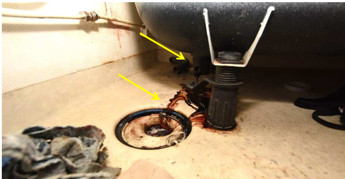
Figur 81. Visar blod (S028) mellan badkarets mynningsrör samt avloppsbrunn, se pilar.
