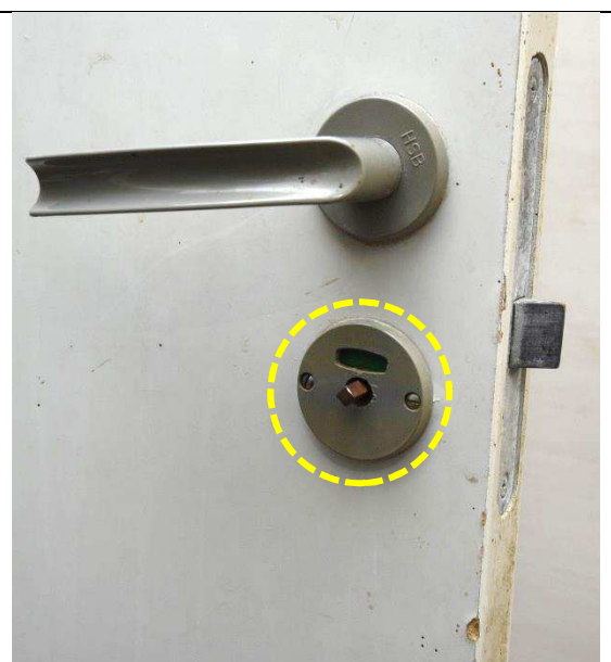
Figur 54. Låsvredet/beslaget saknades på dörrens insida.
