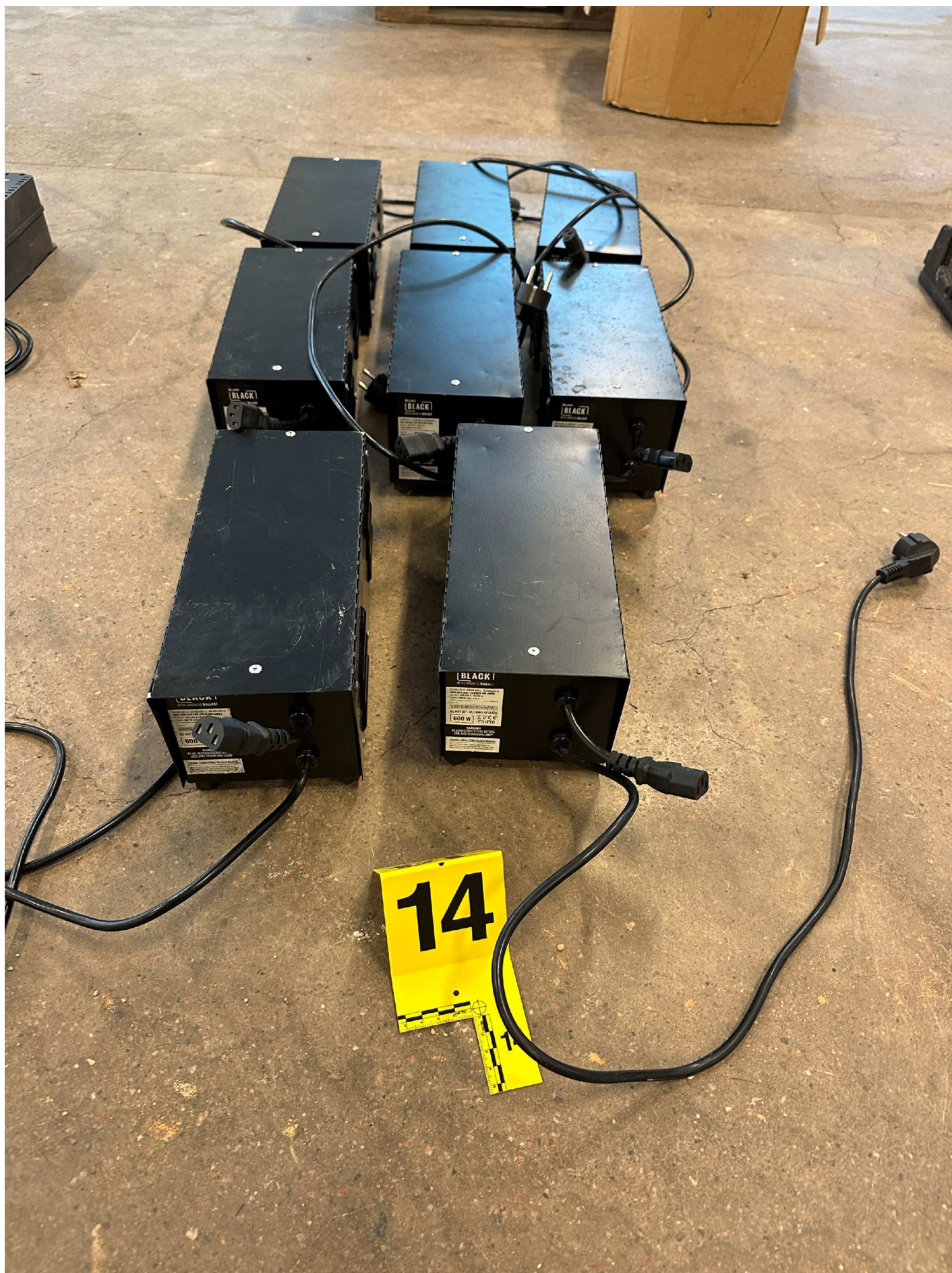
14. 14. Transformatorer. Lumii. Elektrisk ballast 600W.
