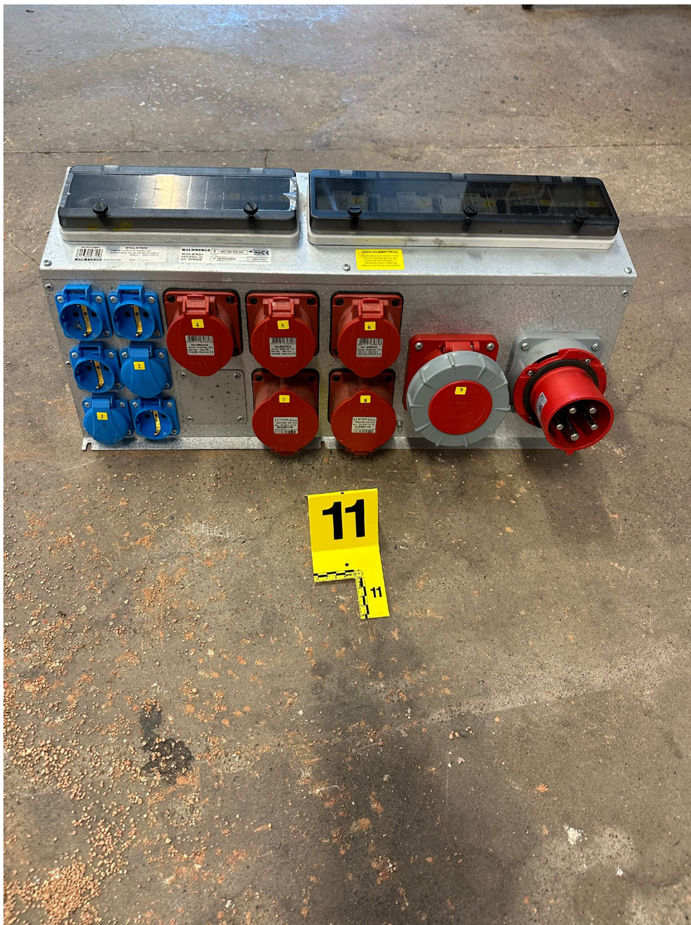
11. 11. Elcentral. Malmbergs. Byggström. Med jordfelsbrytare.
