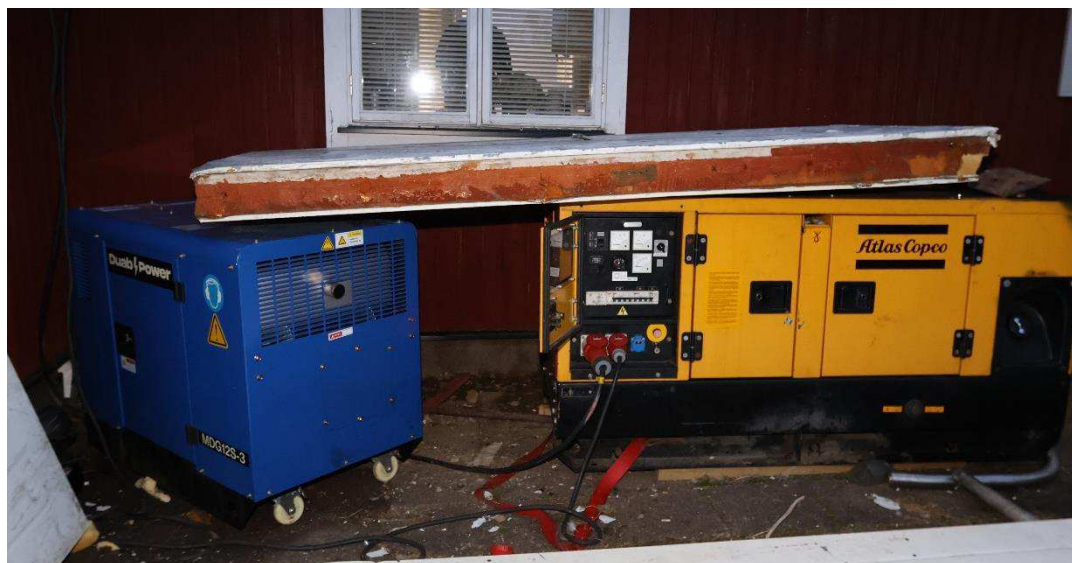
Figur 4. Visar generator utmed husväggen.
