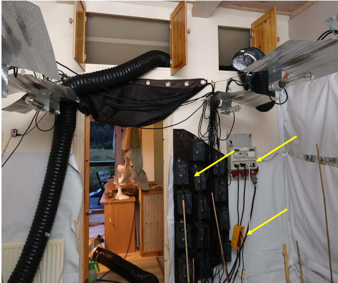
Figur 21. Visar elektronsik utrustning uppsatt på väggen mot hallen. Markeringarna visar säkrade spår från elektronisk utrustning.
