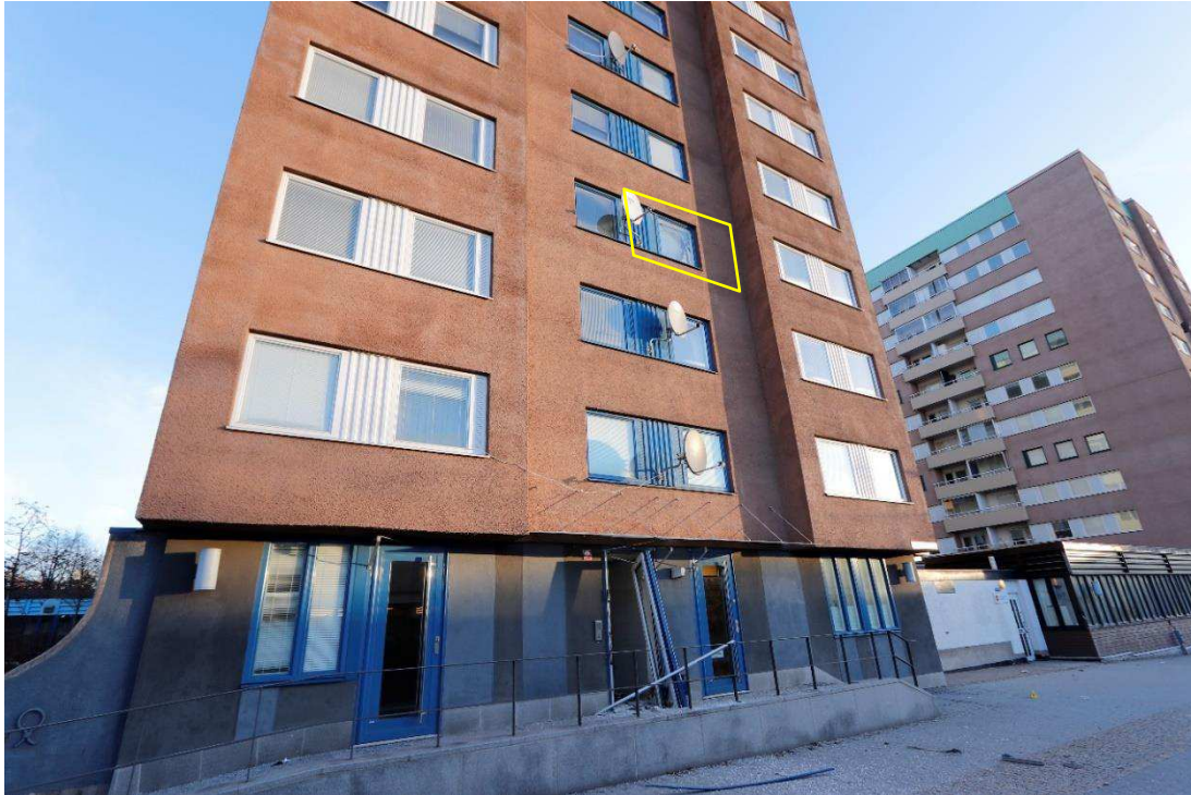
Figur 30. På våning 3 i flerbostadshuset ses en trasig fönsterruta rakt ovanför detonationsplatsen.
