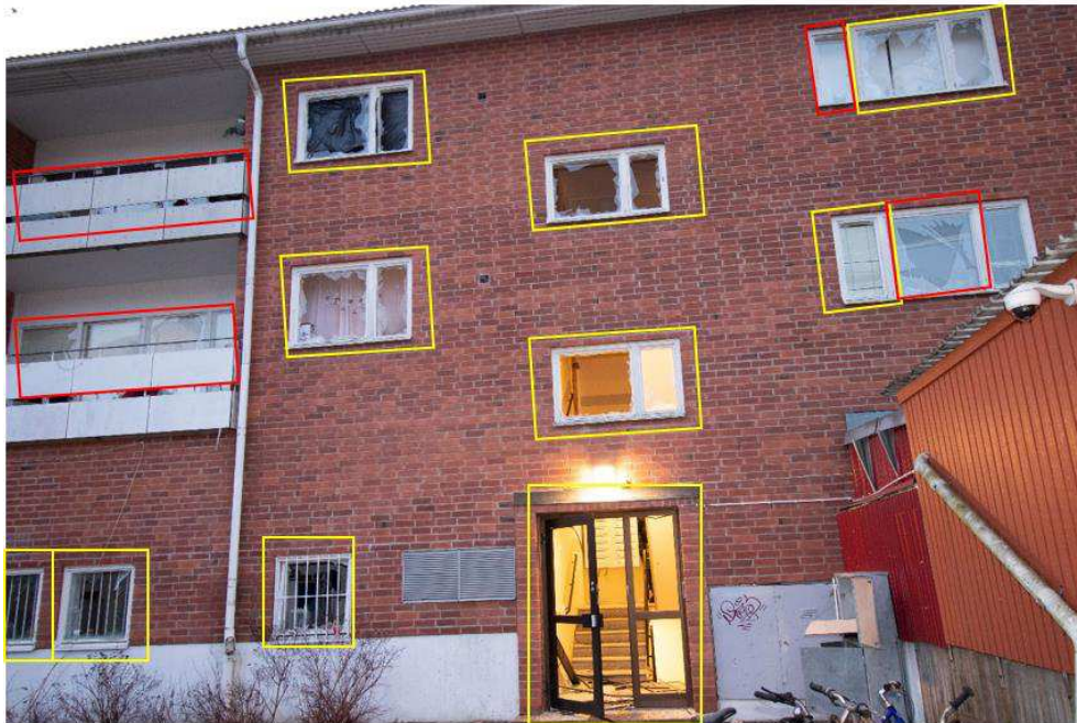
Foto på entré nr 31. Gulmarkerade fönster var krossade rakt igenom, de rödmarkerade fönstren är endast yterrutan krossad.
