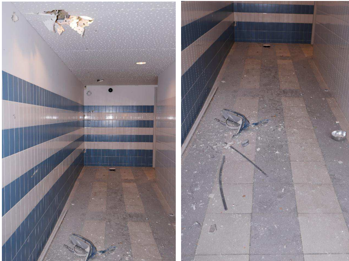
Figur 21. Trapphuset med synliga skador i taket och på väggarna. En större metalldel låg ca 5 meter in från entrédörren.
