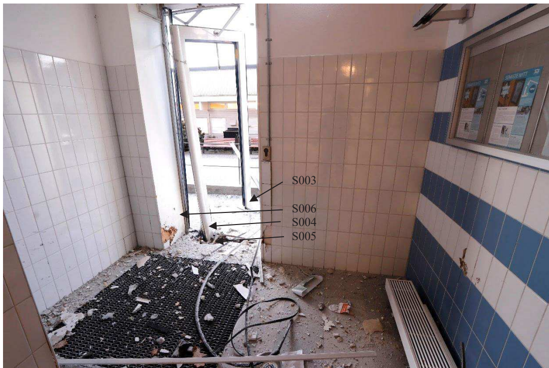
Figur 18. Entrén sedd från trapphuset. Byggnadsmaterial ligger på golvet och skador ses på kakelväggen.
