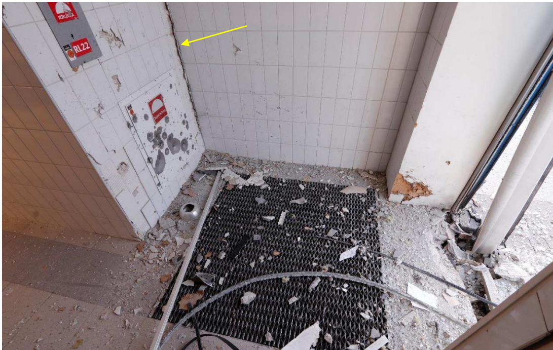
Figur 17. Skador i trapphuset på golvet och väggarna samt på en metallucka. Pilen markerar en spricka i väggen.
