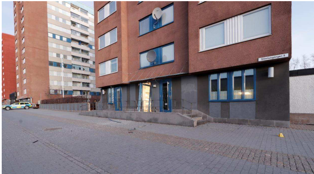
Figur 5. De mest omfattande skadorna ses på entrén vid fastighetens kortsida. Bilden är tagen mot nordväst.
