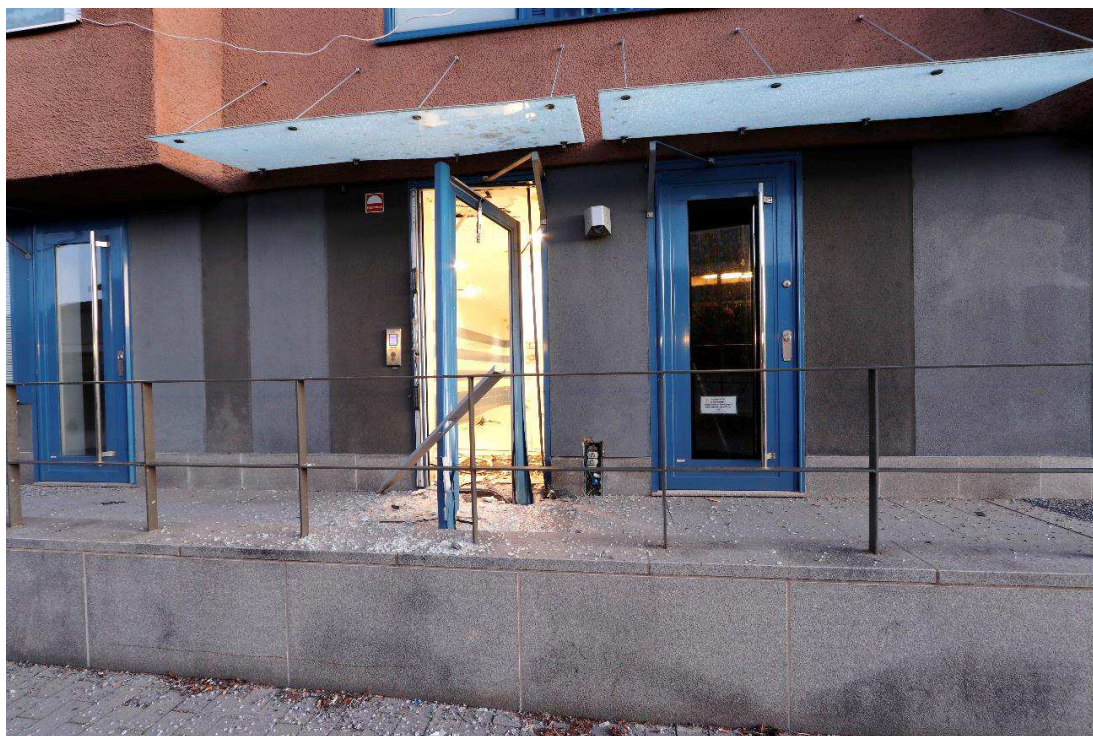
Figur 6. Skador på entréns dörr och dörrkarm. Bilden är tagen norrut.
