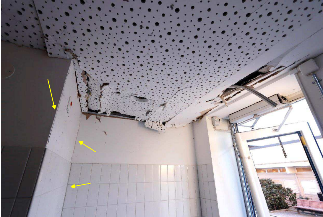
Figur 19. Skador i taket i entrén i trapphuset. På väggen ses sprickor (pilar).
