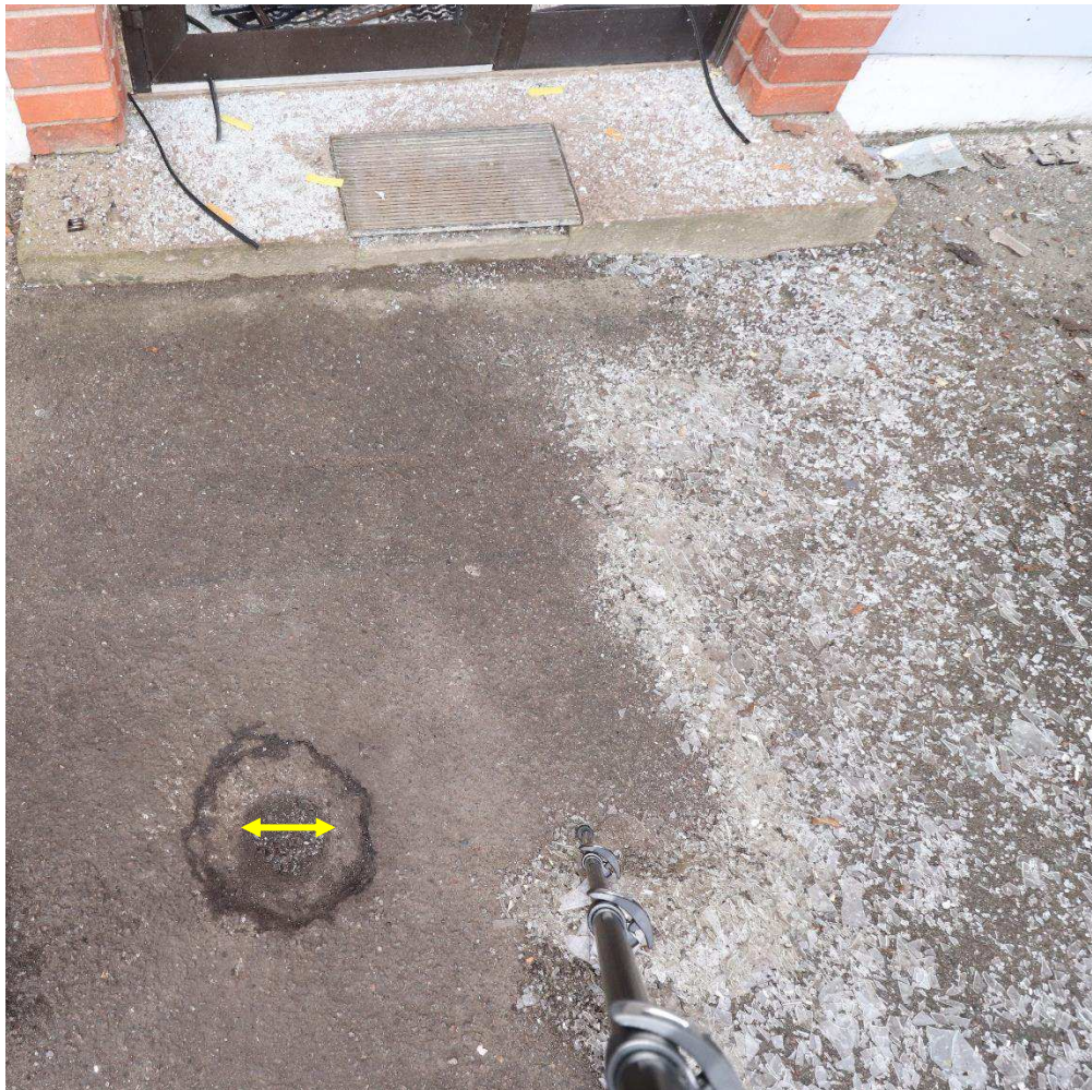
Figur 9. Detonationsgropen efter att löst material sopats bort. Den markerade delen av gropen var ca 17 cm i diameter. Undersökarens kamerastativ är synligt i förgrunden.
