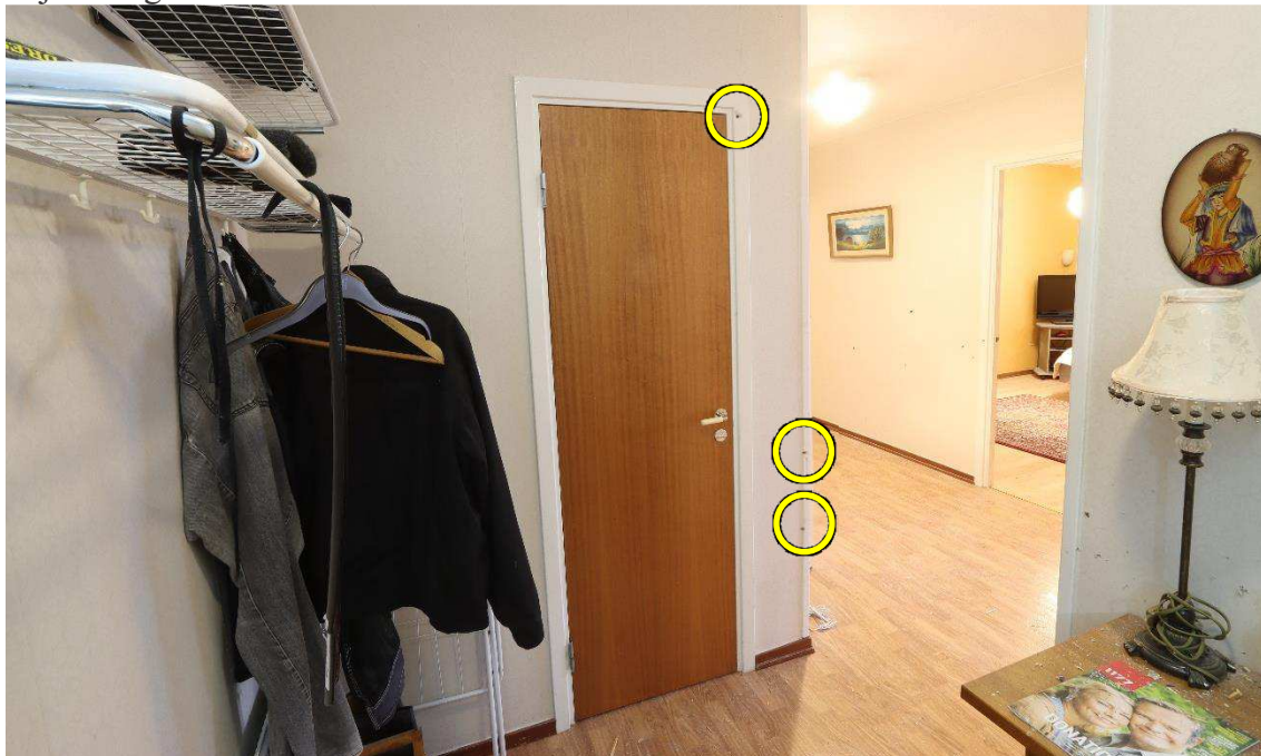
Figur 10. Väggen i hallen mot toaletten. I bilden är skottskadorna markerade med gult.
