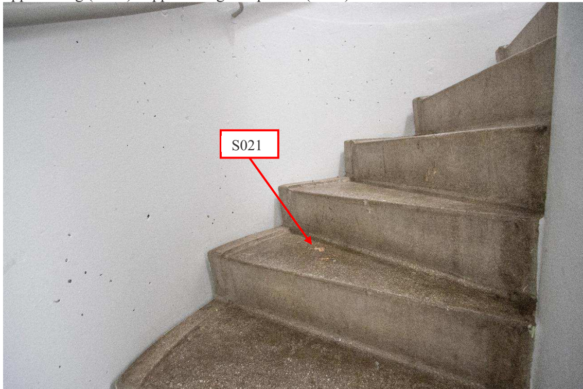
Figur 10. Mindre uppkastning (S021) i trappan mellan våningsplan 3 och 4.
