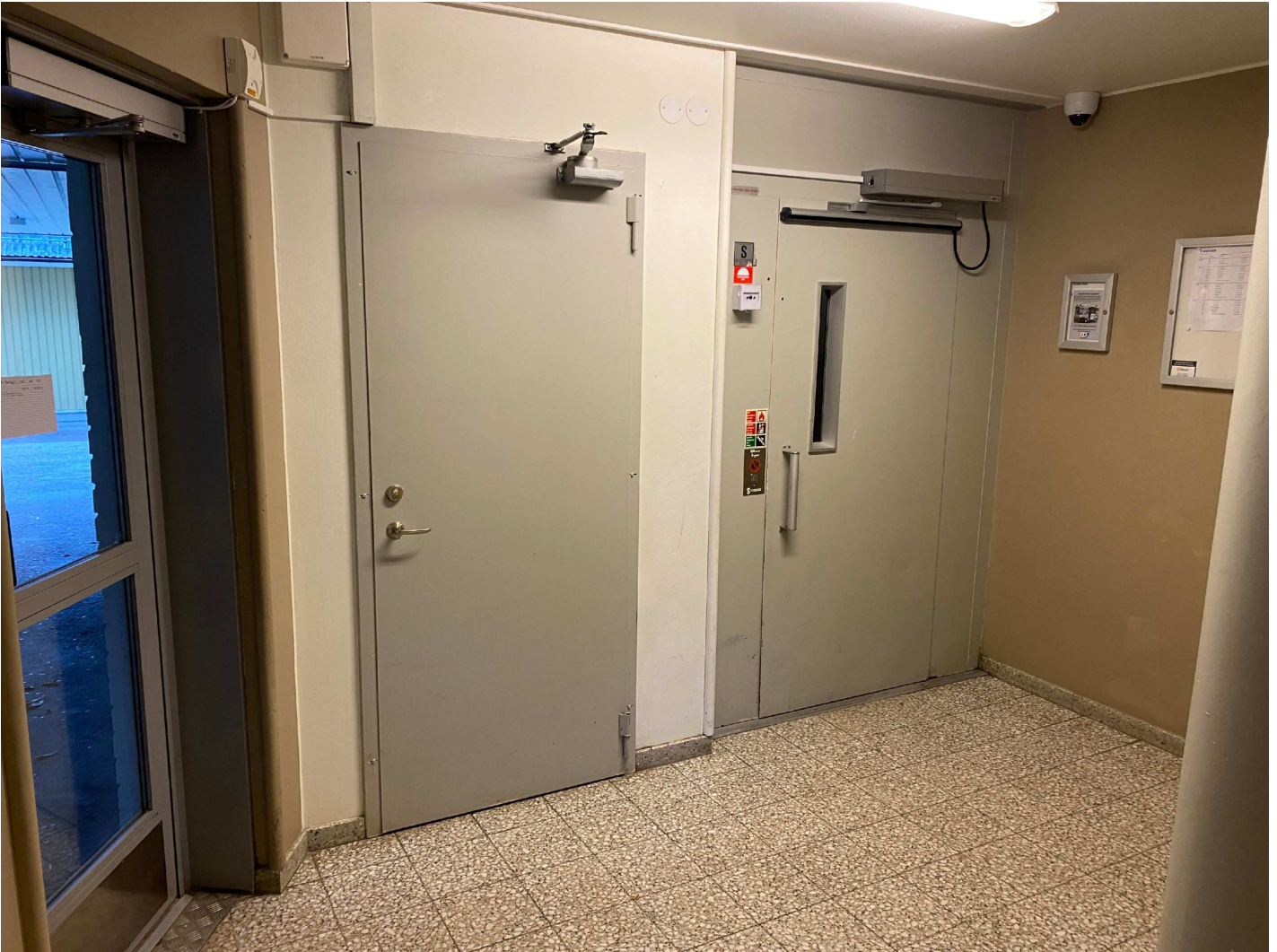
7. Ingång trapphus i nr 13, kamera monterad upp till höger i bild och filmar mot entrédörr.
