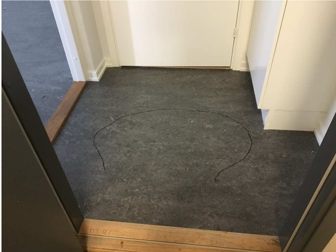
Bild 2. Närbild på Hallgolvet (från trapphuset).
