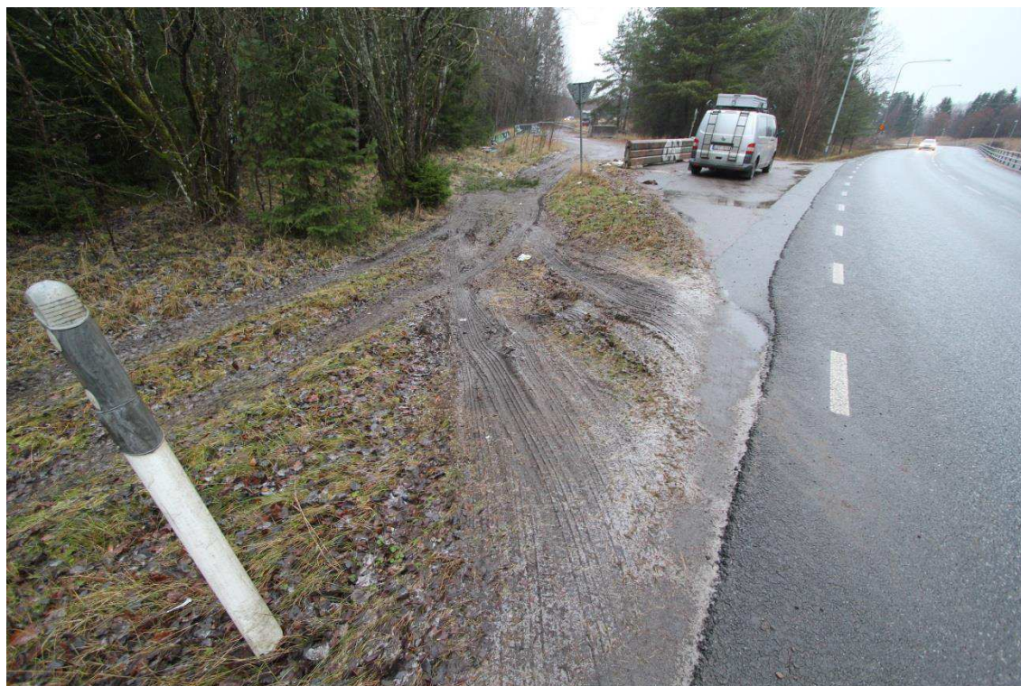
Figur 2 Hjulspår i marken till vänster om den blockerade infarten till räddningspåfarten.
