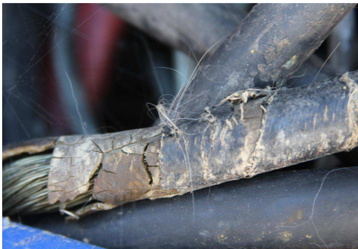
Bild 27. Detaljbild på hårliknande material S158 på kabeln.
