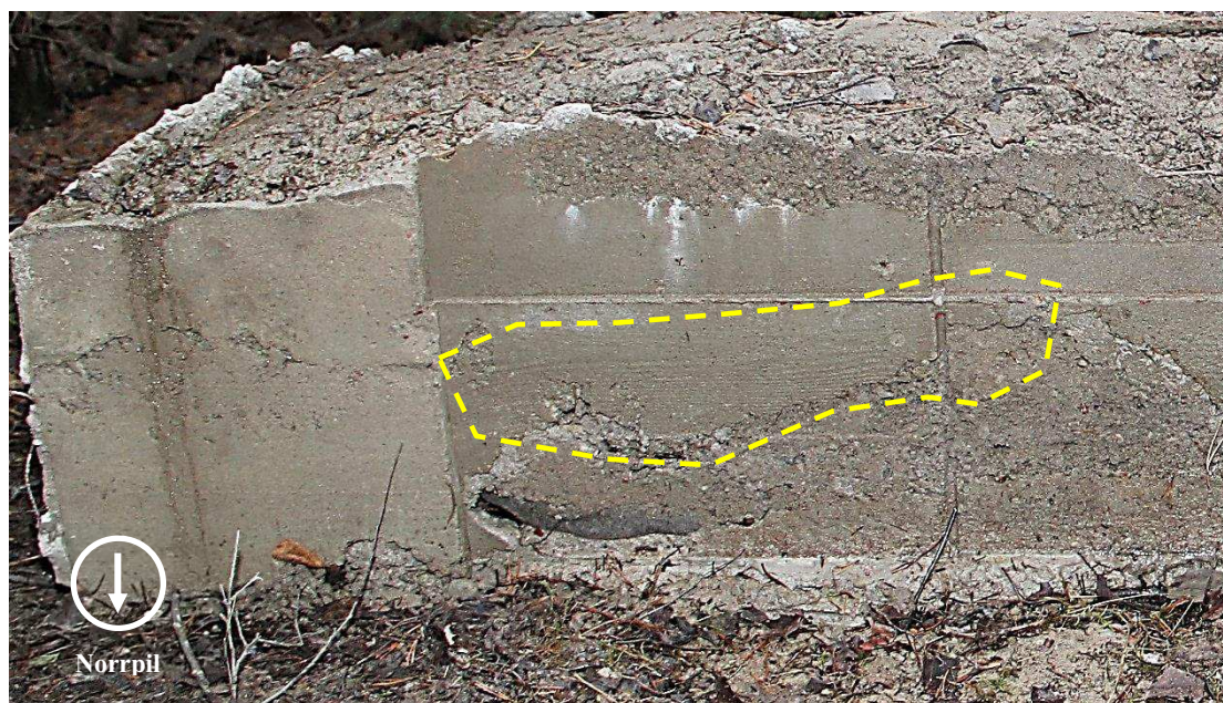
Figur 21 På den norra långsidan iaktogs träådring i betongens ytskikt
