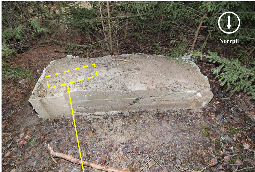
Figur 16 Iakttaget spår i betongens yta.
