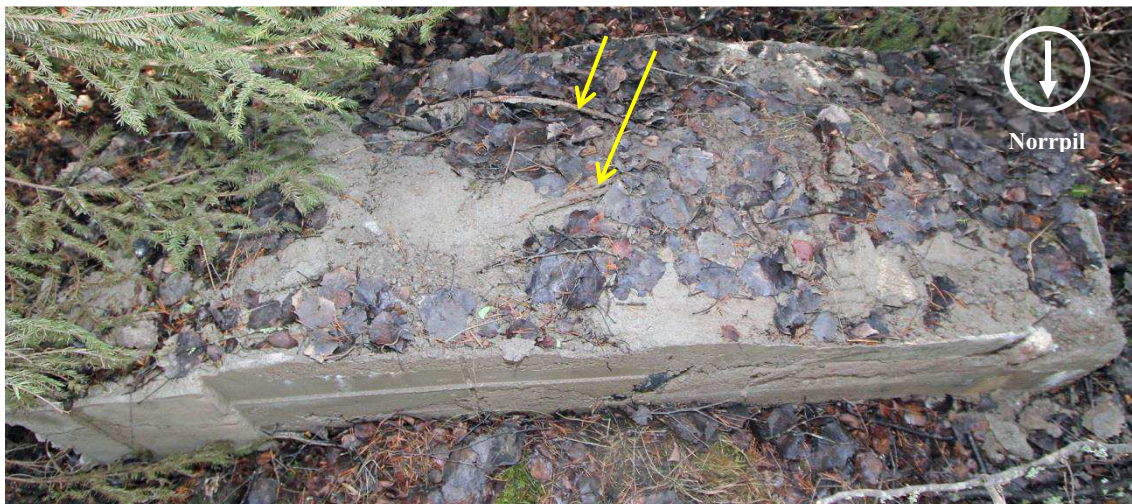
Figur 14 Ovansidan var bemängd med löv, kvistar och barr. Armeringsjärn stack upp ur betongen på ovansidan (pilar)
