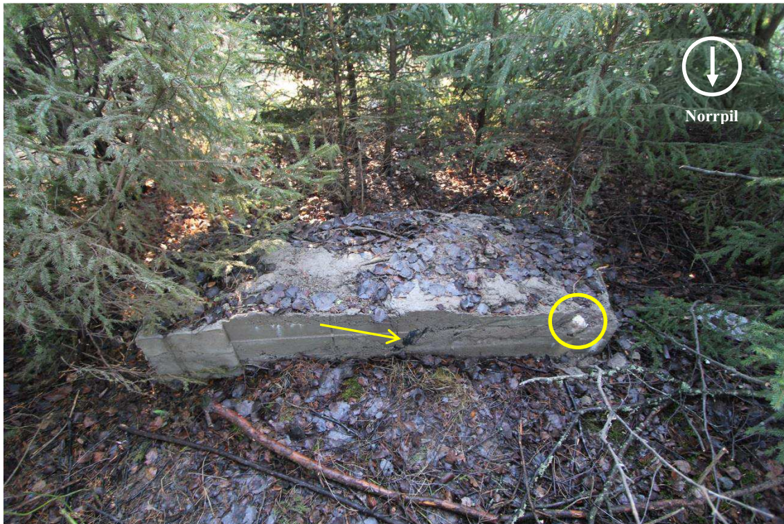
Figur 13 Ringmarkeringen markerar området där betong fallit av och hade blottlagt vad som syntes vara en häl. På långsidan syntes svarta textilier som stack ut ur betongen(pil)
