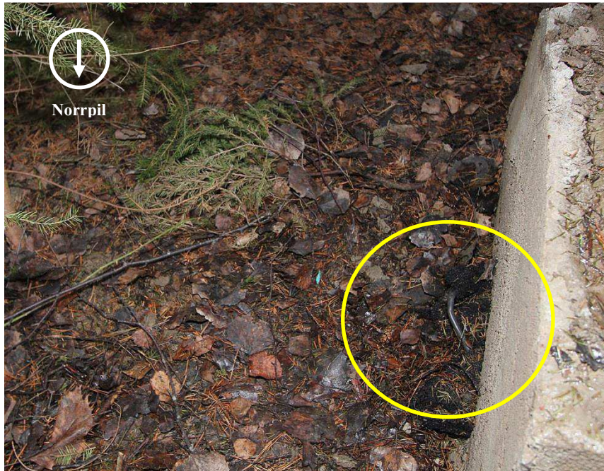
Figur 18 Kabel och svart textil stack ut nedtill vid den östra kortsidan.
