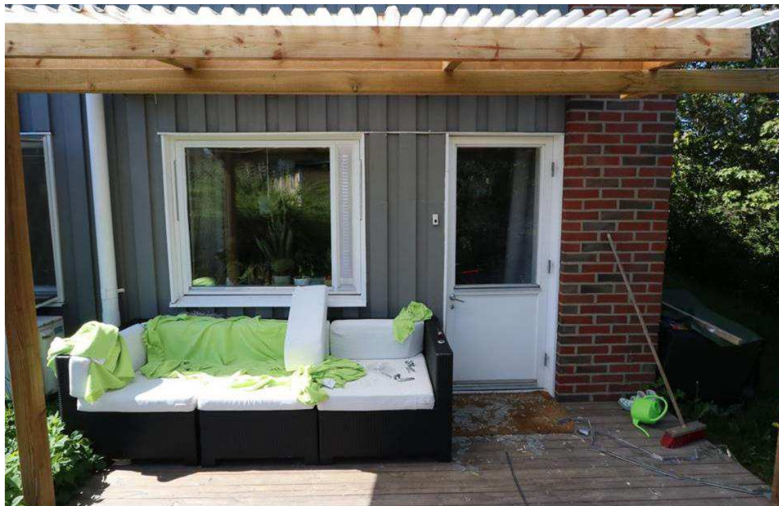
Figur 38. Bild tagen vid 2:a undersökningen efter att det trasiga glasets lagats.
