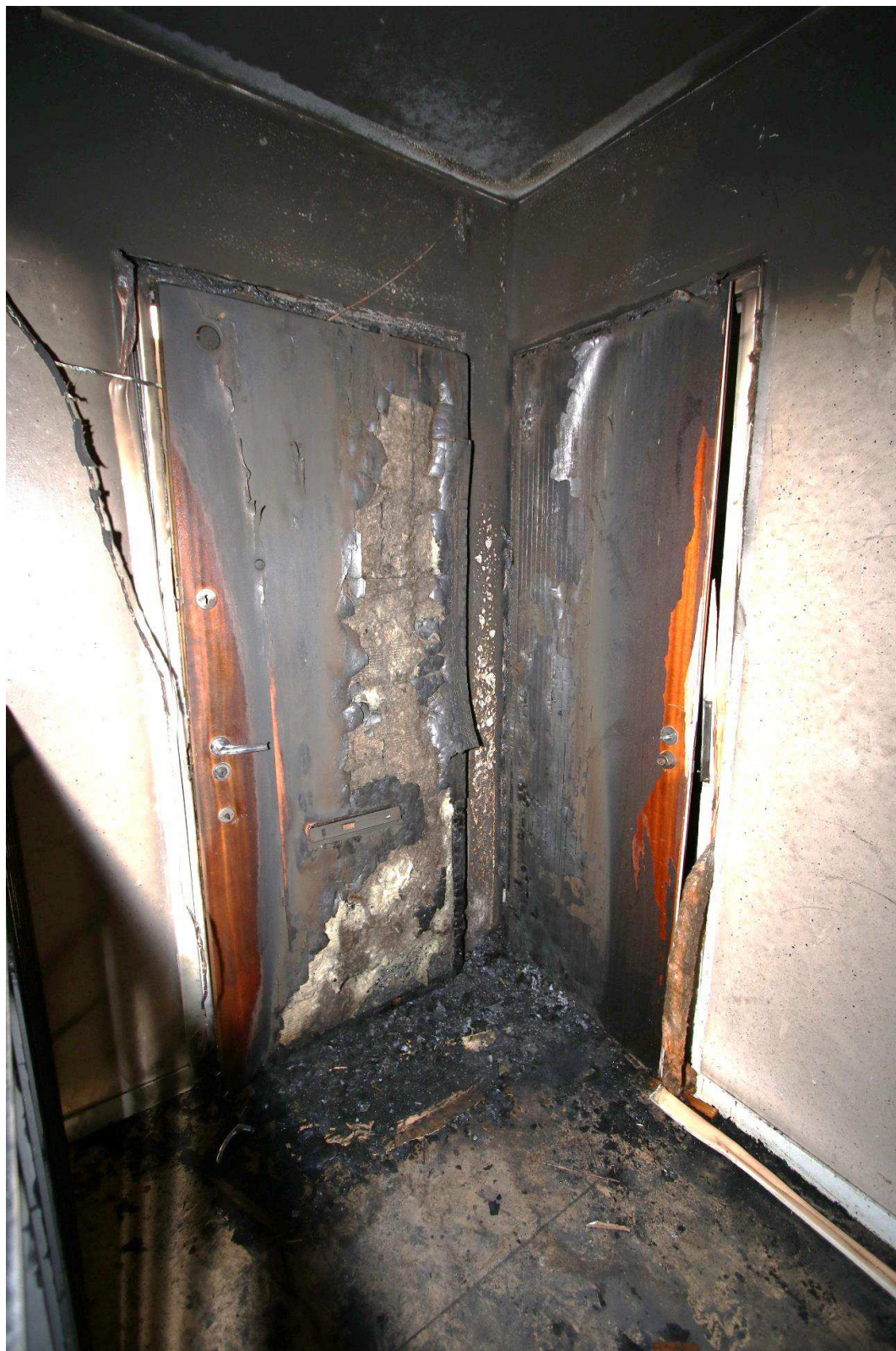
Figur 11. Ytterdörren tillbaksplacerad där den bedöms ha suttit innan branden.
