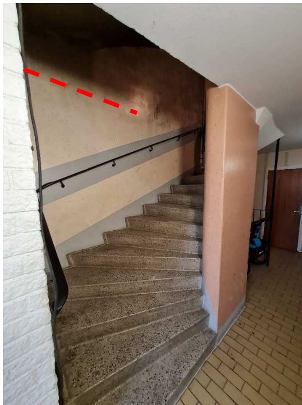
Figur 1 Tydlig gräns vart röklagret har varit i trapphuset. Allt ovan är röskadat, allt under har försumbar påverkan. Syns även en barnvagn under trappen. Bild från besök 2024-06-12
