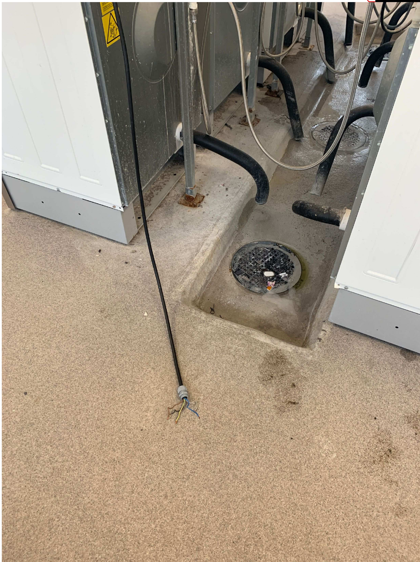
14. Kabel på golv.
