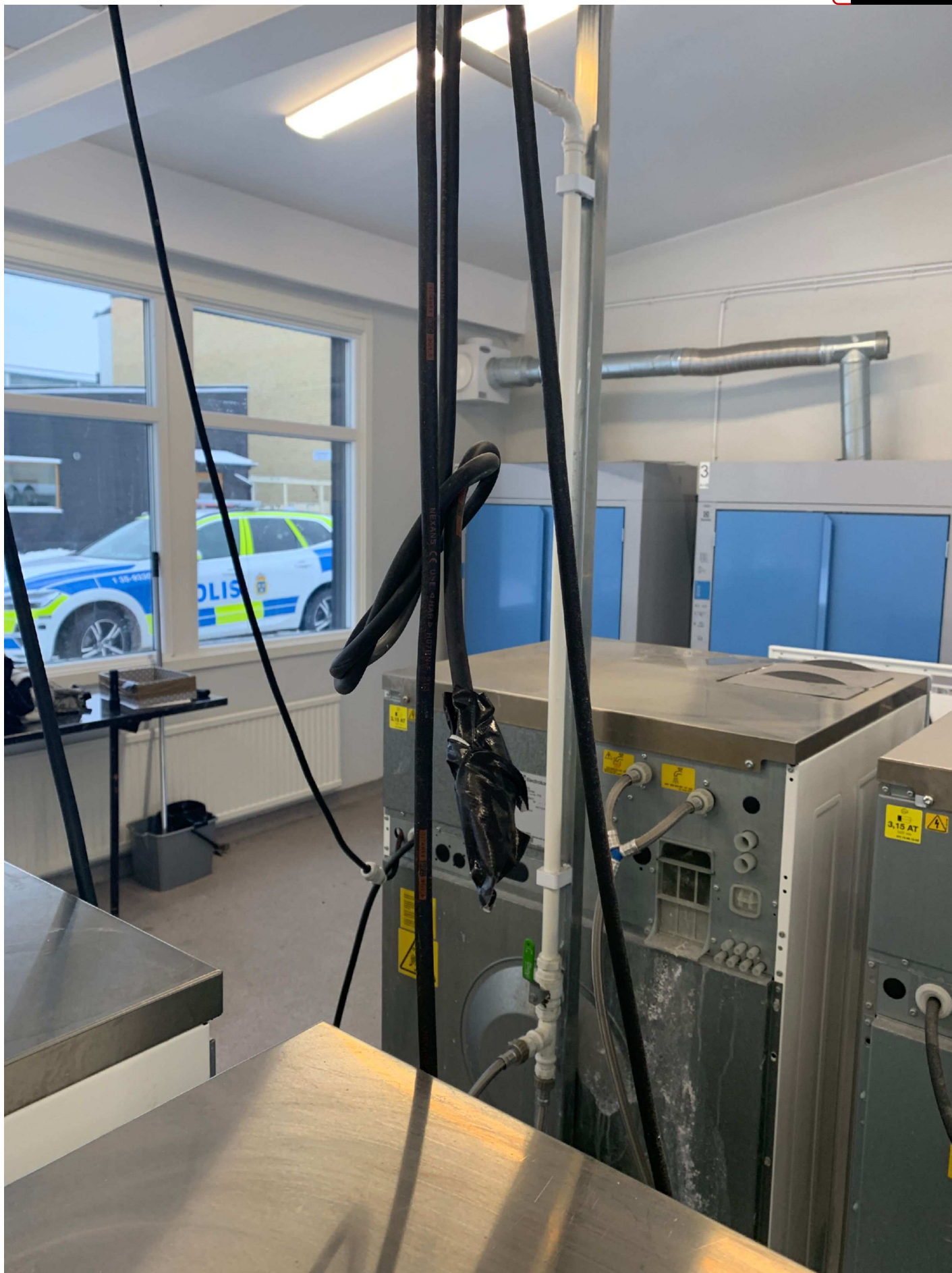
22. Öppnad panel ovanför tvättmaskin som Marko anträffades under, tejpad kabel.
