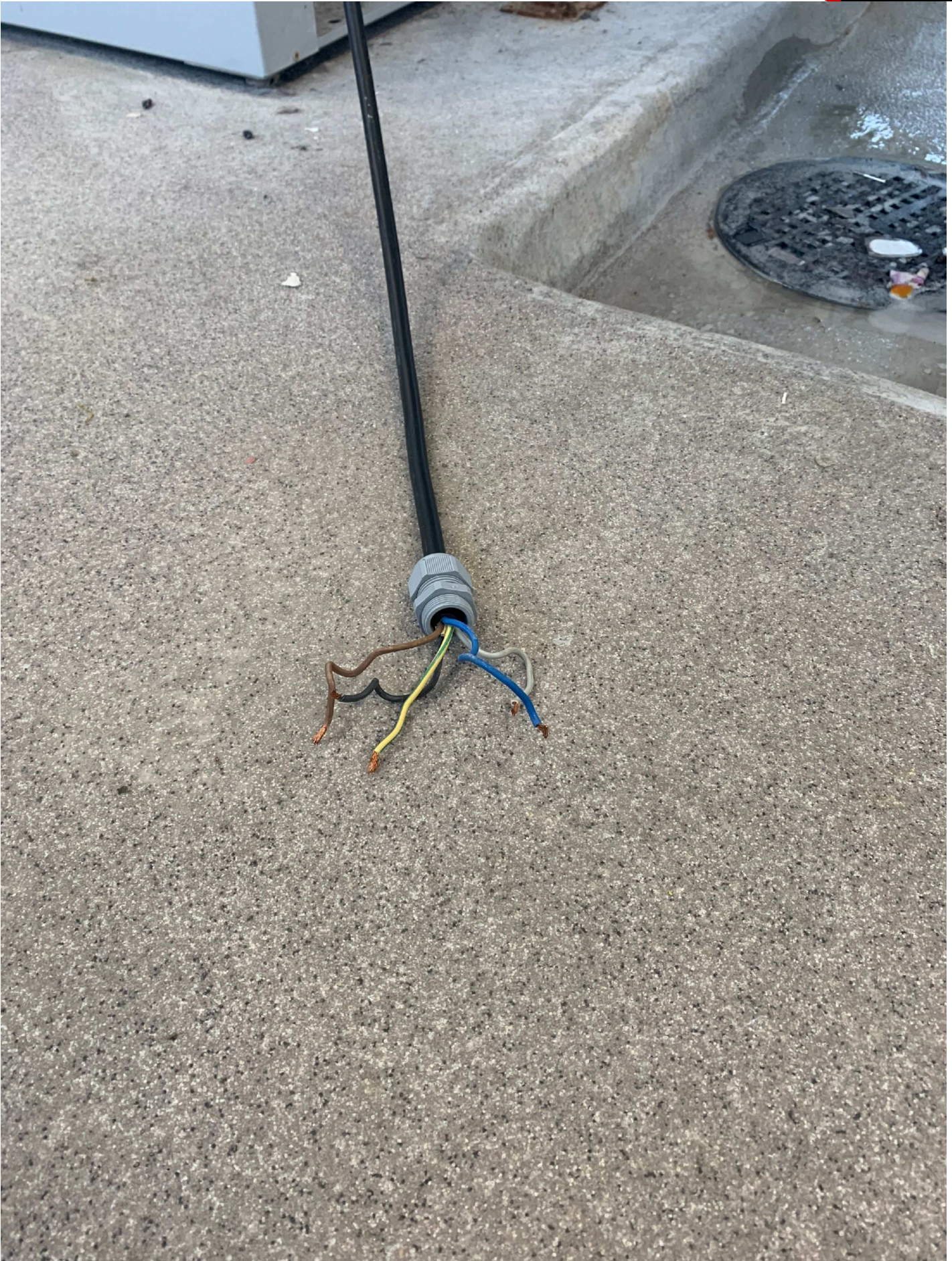
15. Kabel på golv, närbild.
