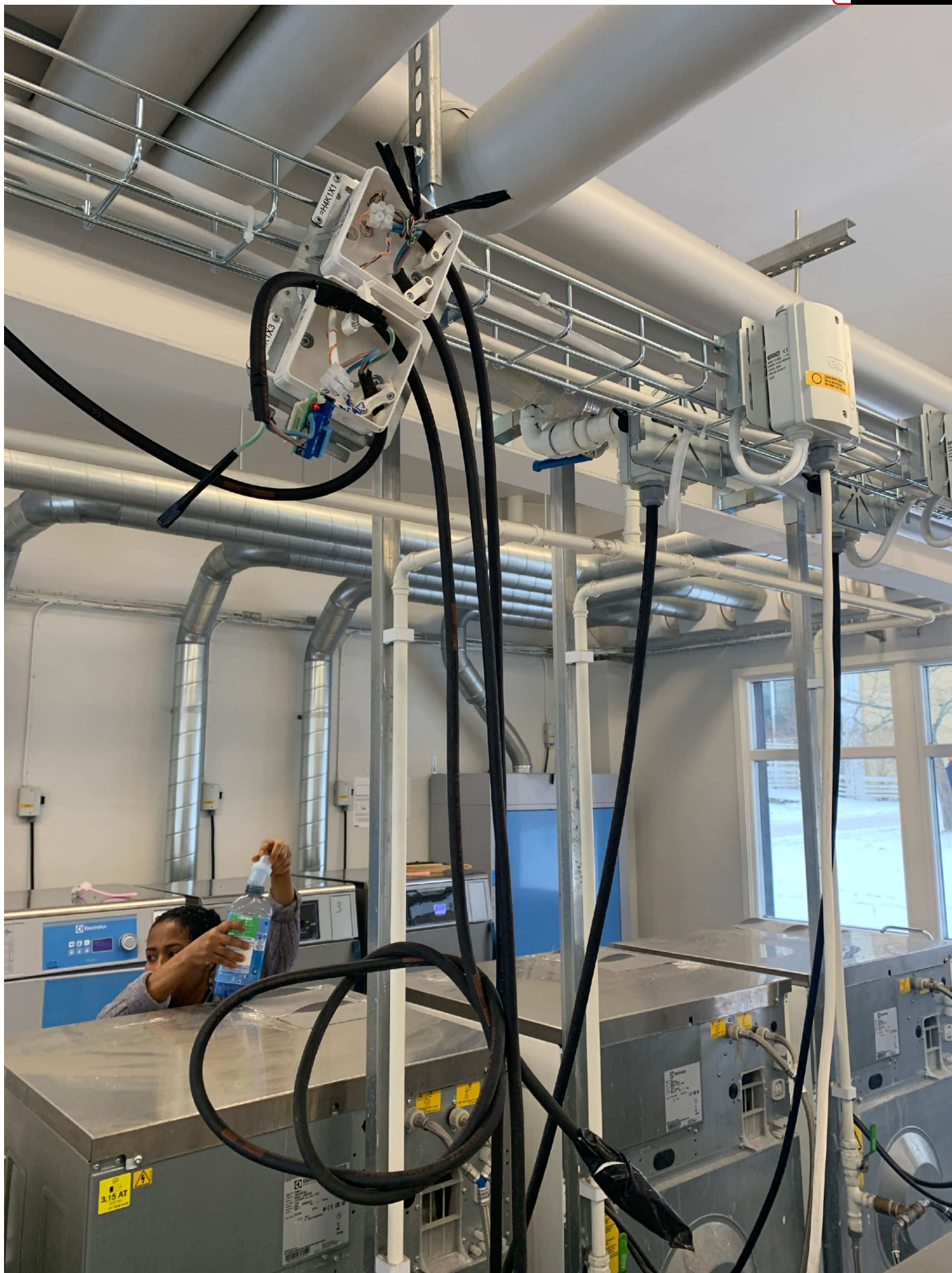
13. Öppnad panel ovanför tvättmaskin som Marko anträffades under.
