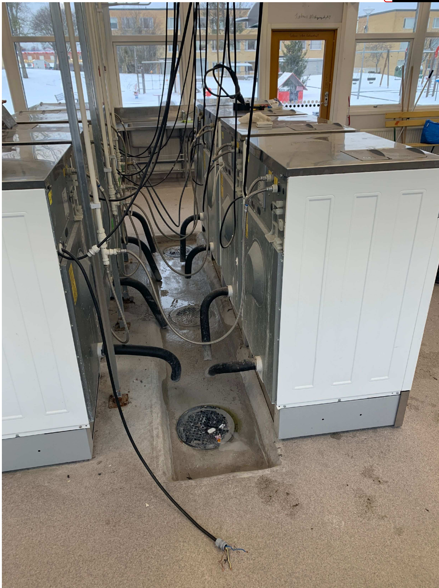
10. Baksida tvättmaskin, Marko anträffades ovanpå tvättmaskin till höger. Kabel på golv.
