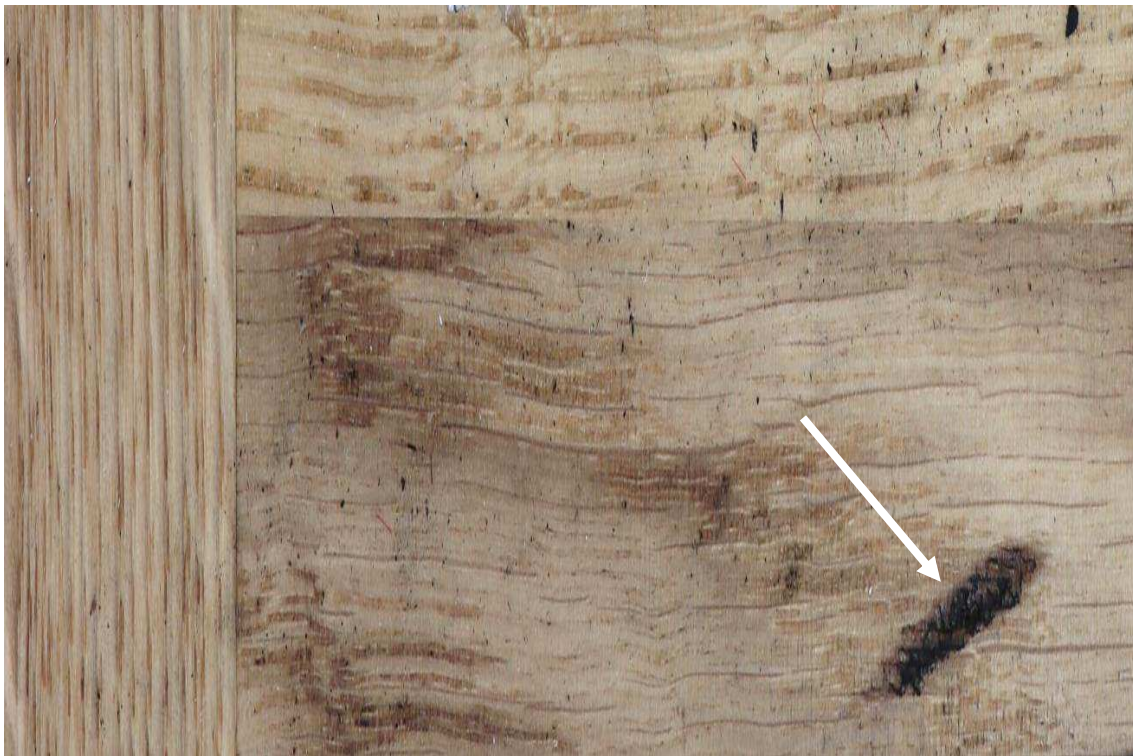
Figur 34. Bild på skadan i trägolvet i område 2. Skadan är markerad med vit pil.
