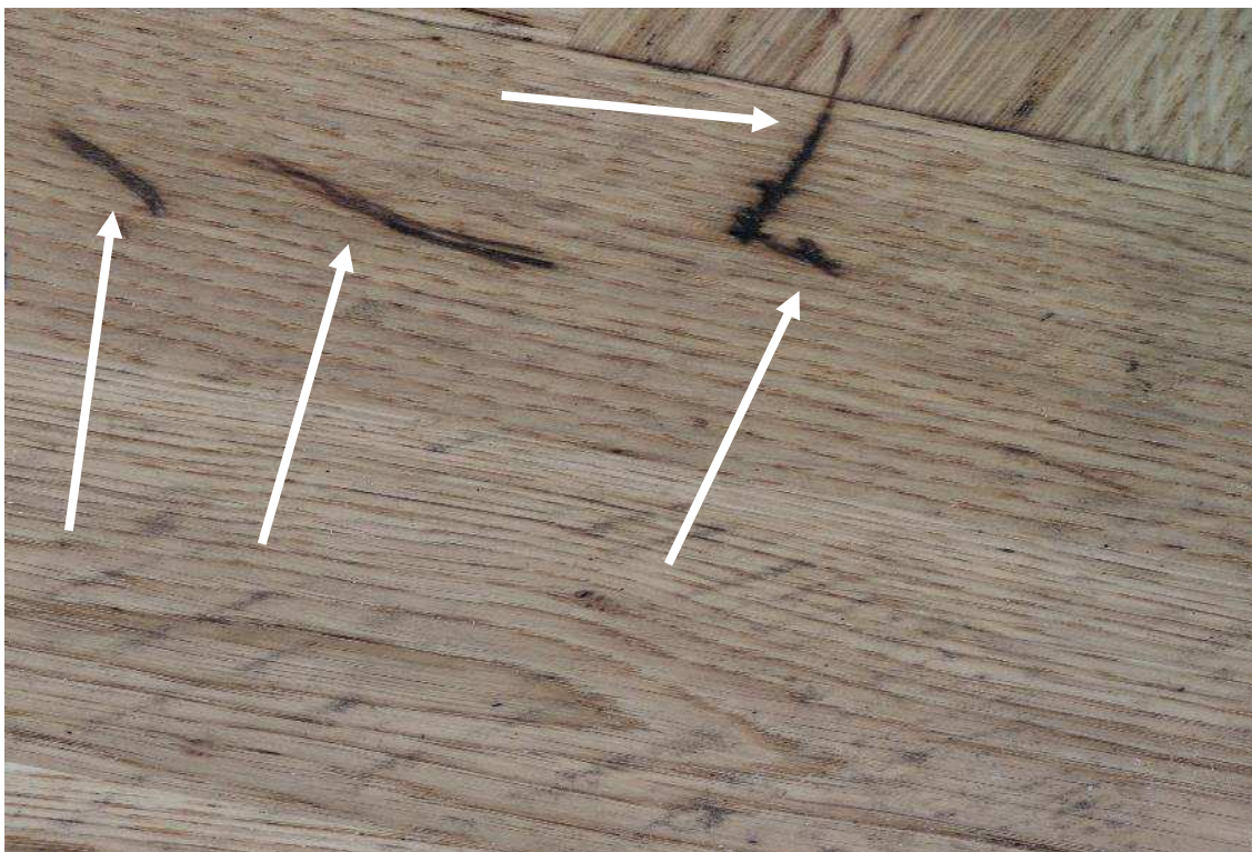
Figur 39. Bild på skador i trägolvet i område 7. Skadorna är markerade med vita pilar.
