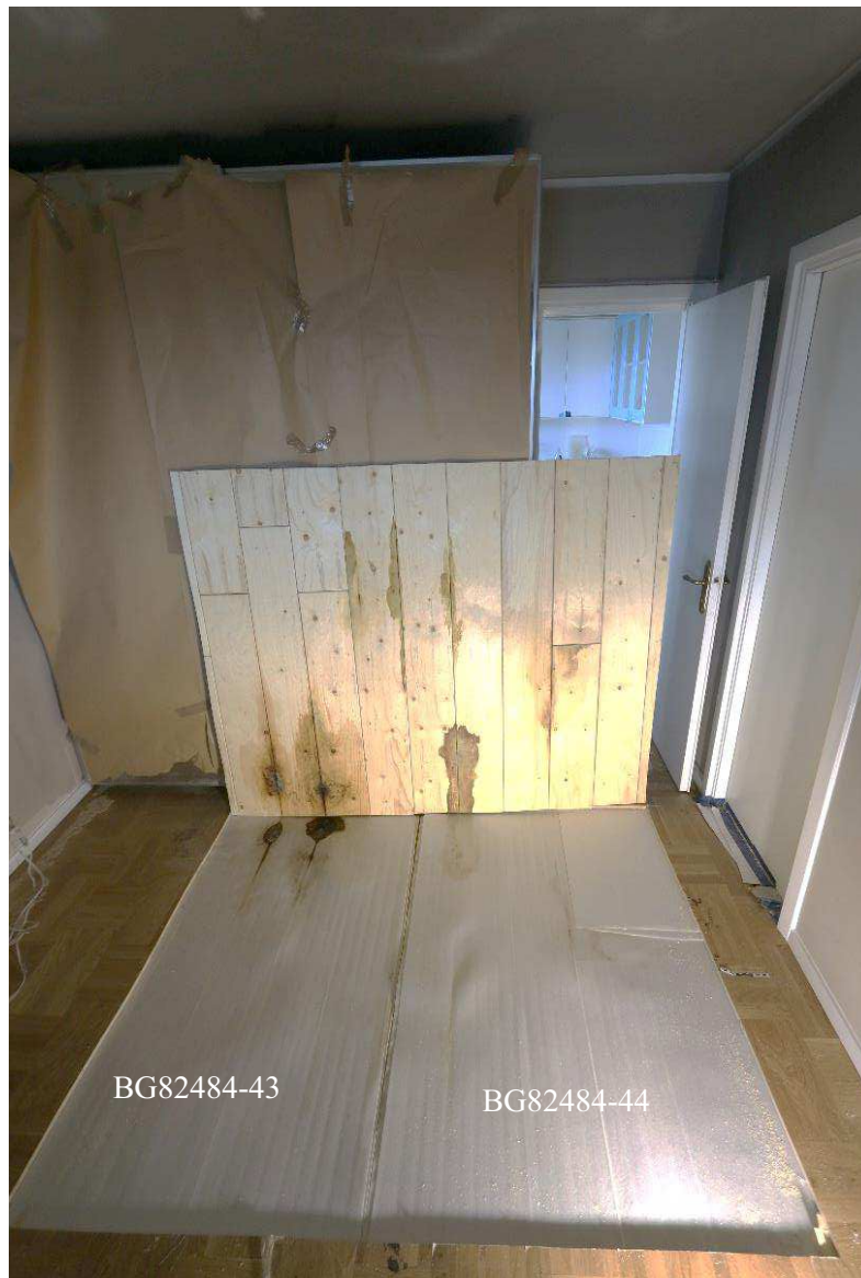
Figur 42. Trägolvet i sovrummet uppsågat. Besudlingar iakttas på undersidan av trägolvet. På golvet ligger golvfoam (BG82484-(43-44))
