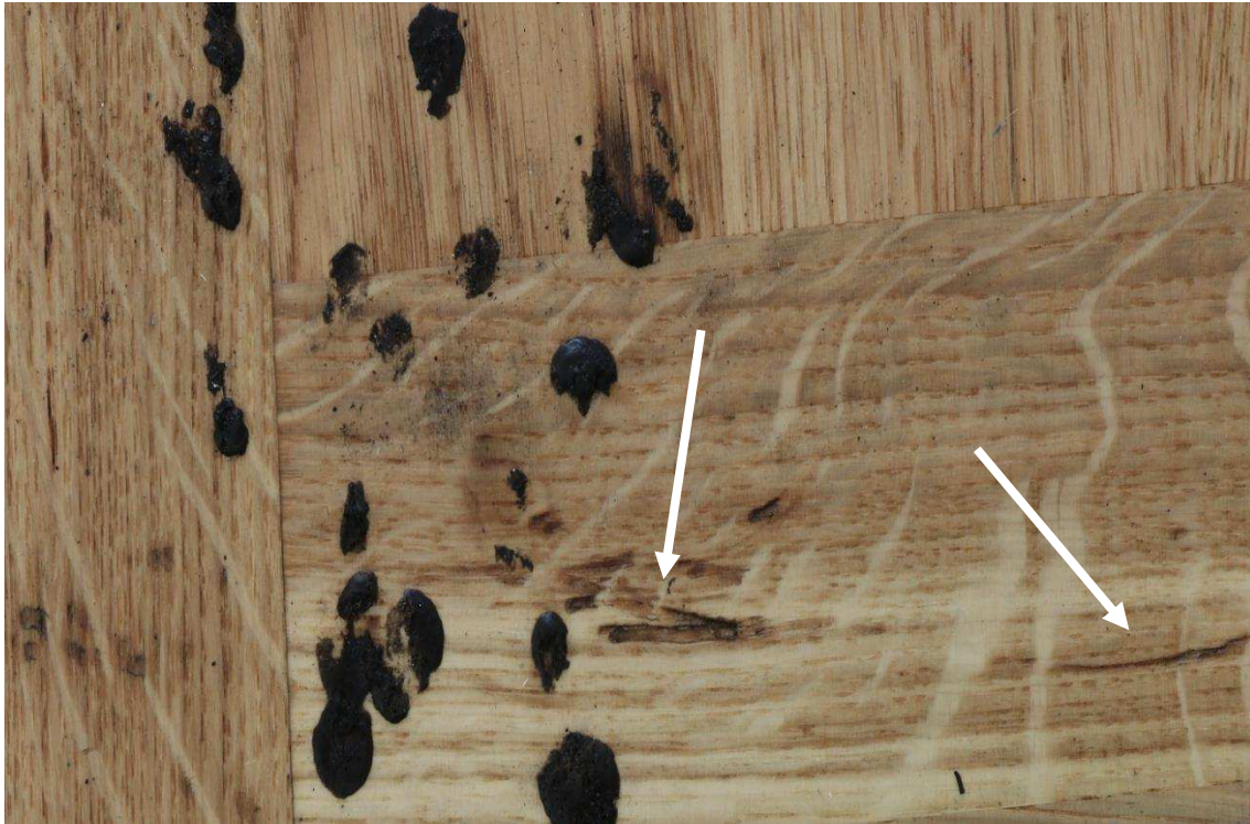
Figur 40. Bild på skador i trägolvet i område 8. Skadorna är markerade med vita pilar.
