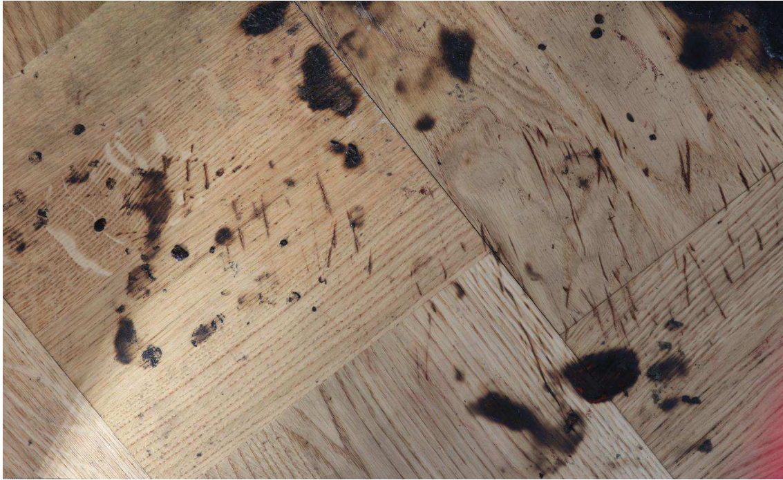
Figur 33. Bild på skador i trägolvet i område 1.
