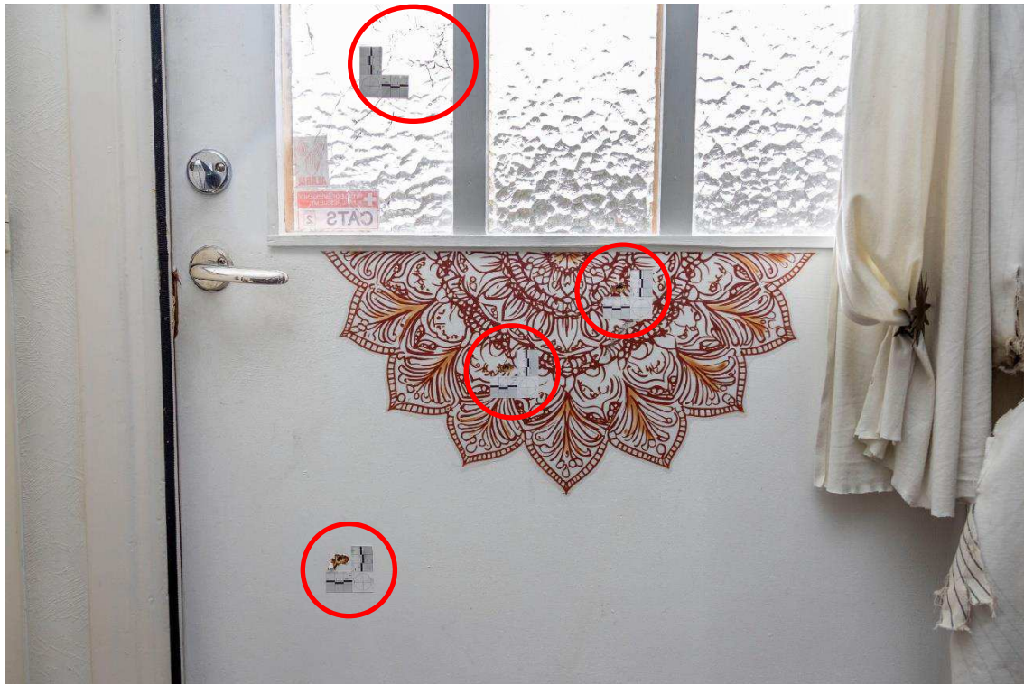
Figur 24. Genomgående skador (1–4) i ytterdörren.
