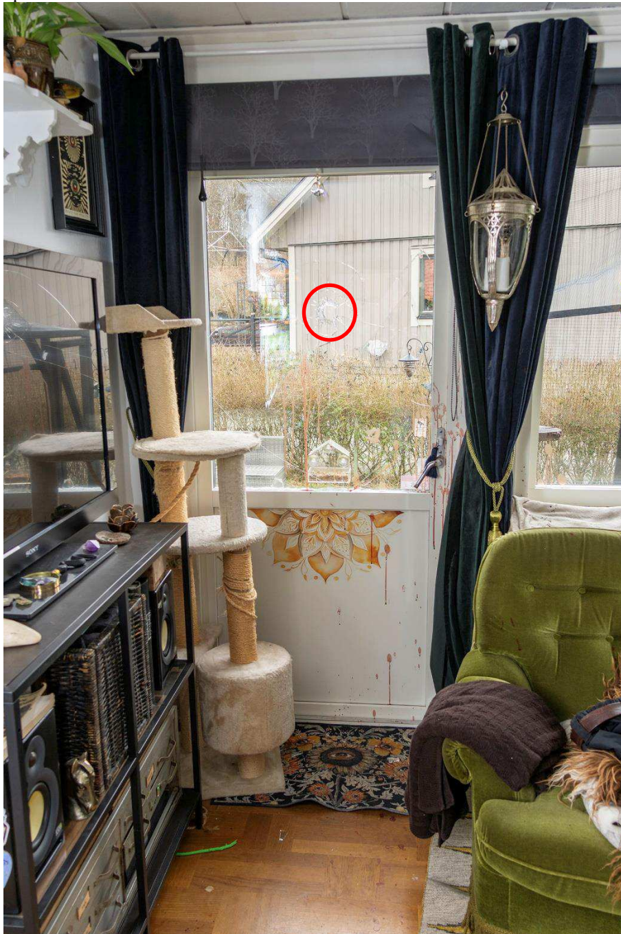
Figur 34. Skada i fönsterrutan i altandörren.
