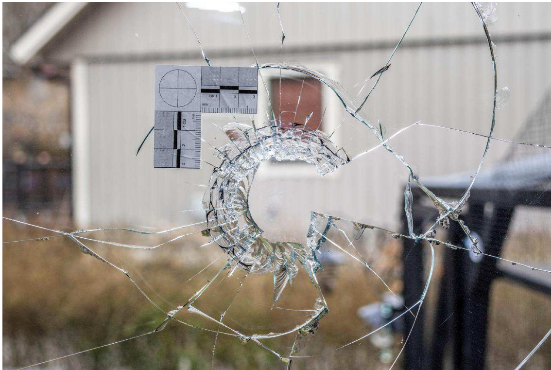
Figur 35. Skada i fönsterrutan i altandörren.
