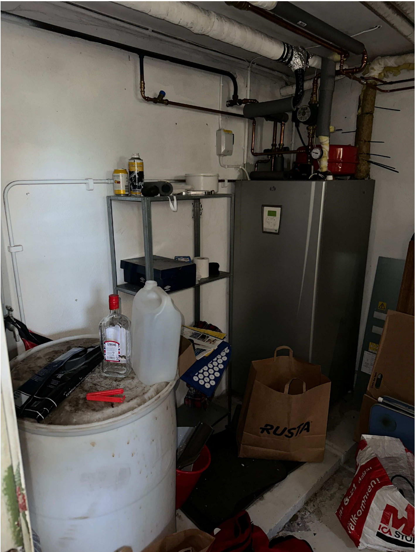
28. Kattkroksvägen 71-6, Asarum. Pannrum i bottenplan. Foto taget av J Mejegård
