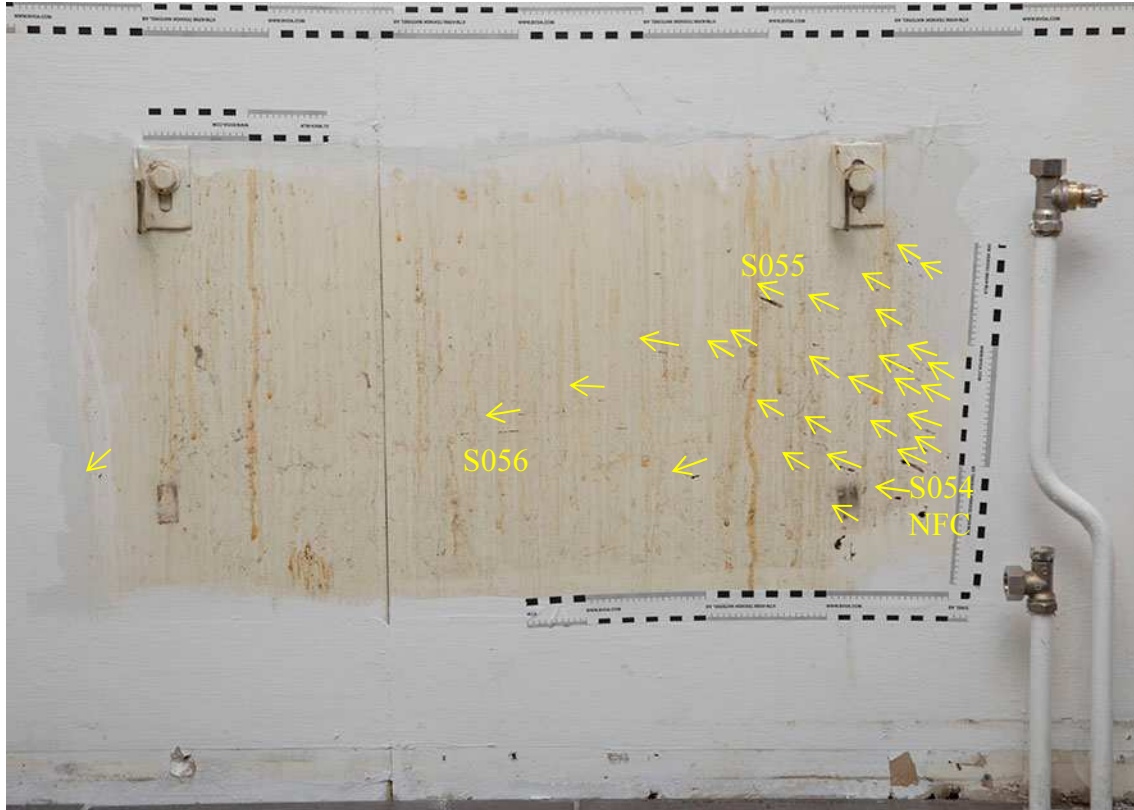
Bild 14. Väggen bakom elementet med stänkriktning markerade med pilar vid några av stänken.
