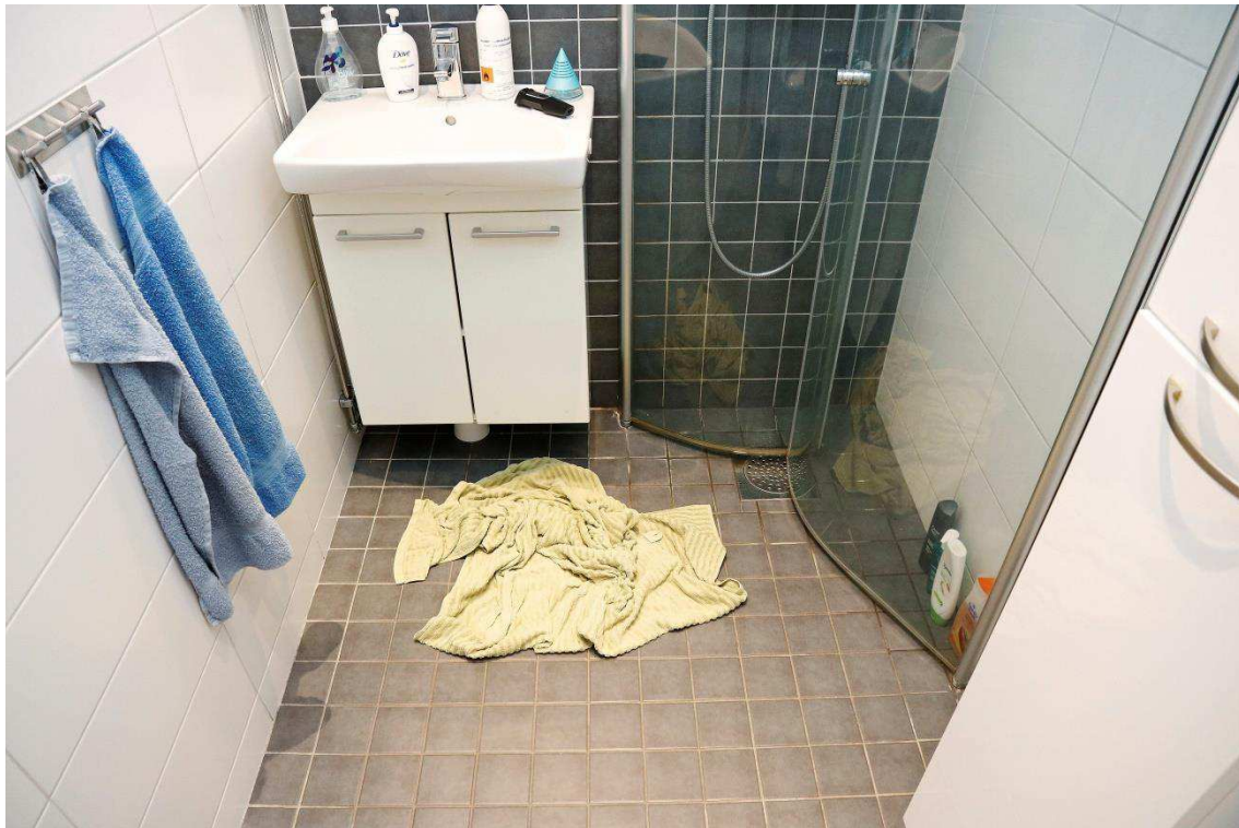
Figur 68. Tvättställ och duschhörna
