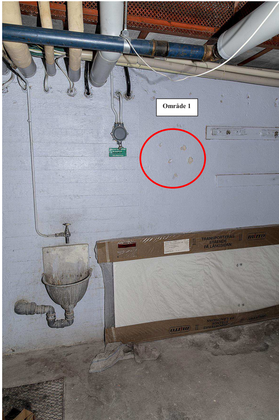
Bild 2 visar islagsmärken i väggen, område 1. Bilden är tagen från caféets källardörr.
