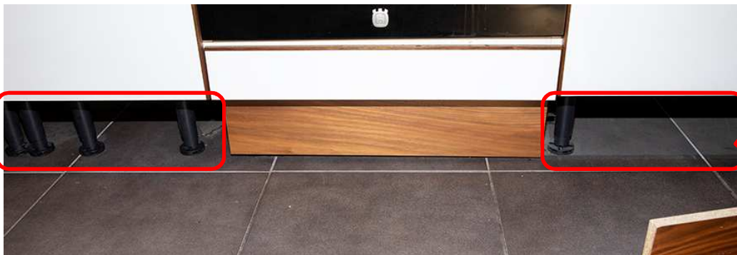
Bild 19. Bilden visar skillnaden på dammet bakom socklarna.
