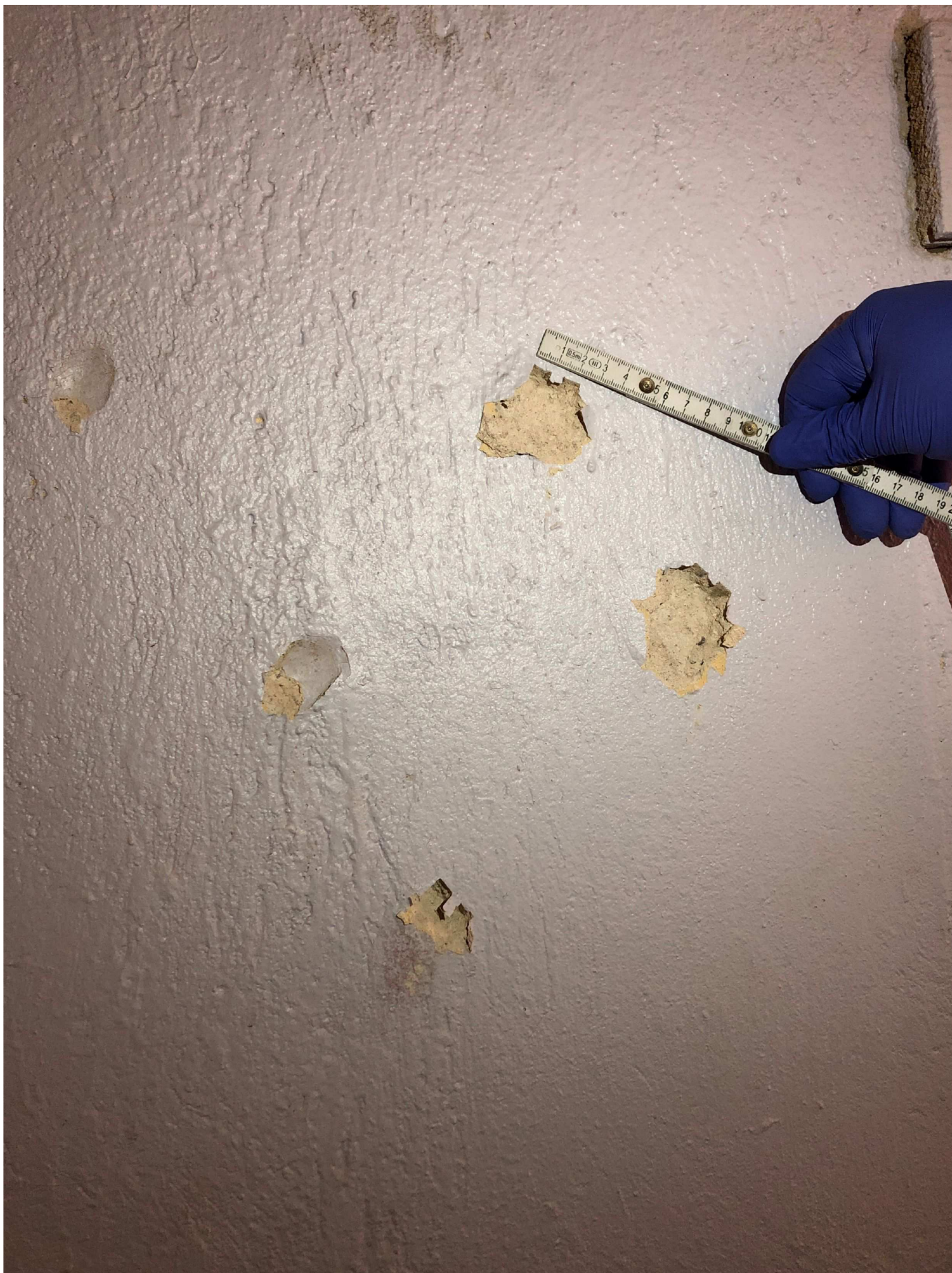
4. Översiktsbild - "Hål 1". Från väggen i källargången på cafét.
