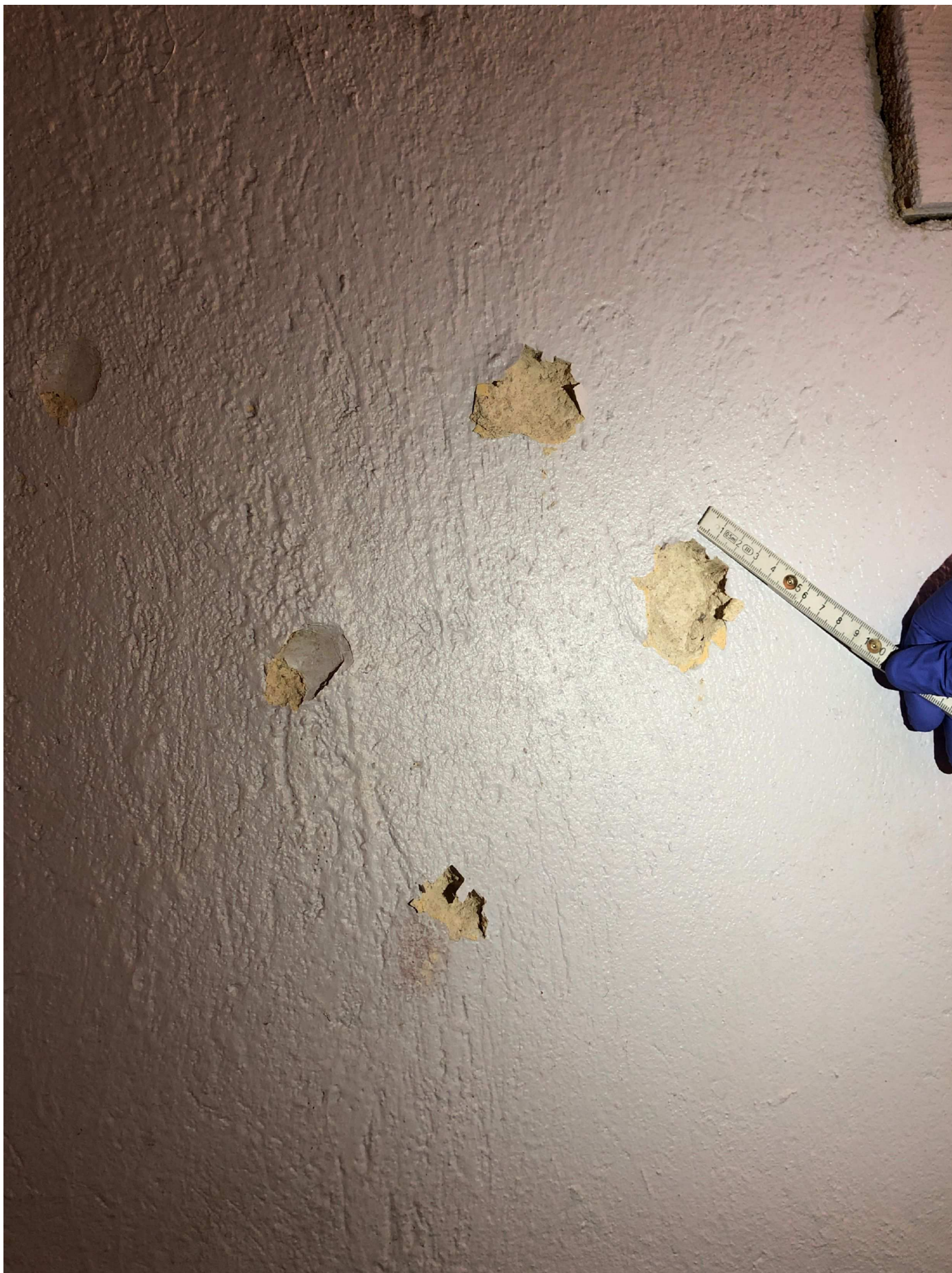
6. Översiktsbild - "Hål 2". Från väggen i källargången på cafét.
