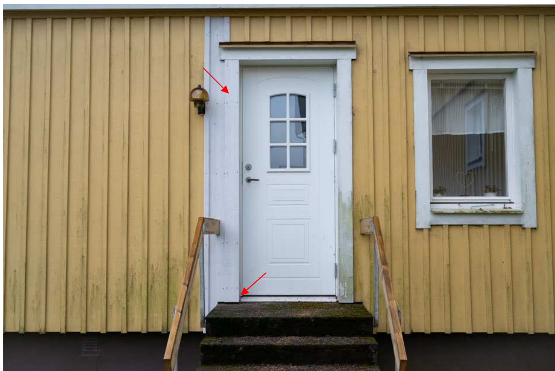
Bild 4. I bilden markeras utbytt dörrfoder samt placering av kvarvarande brandskada
