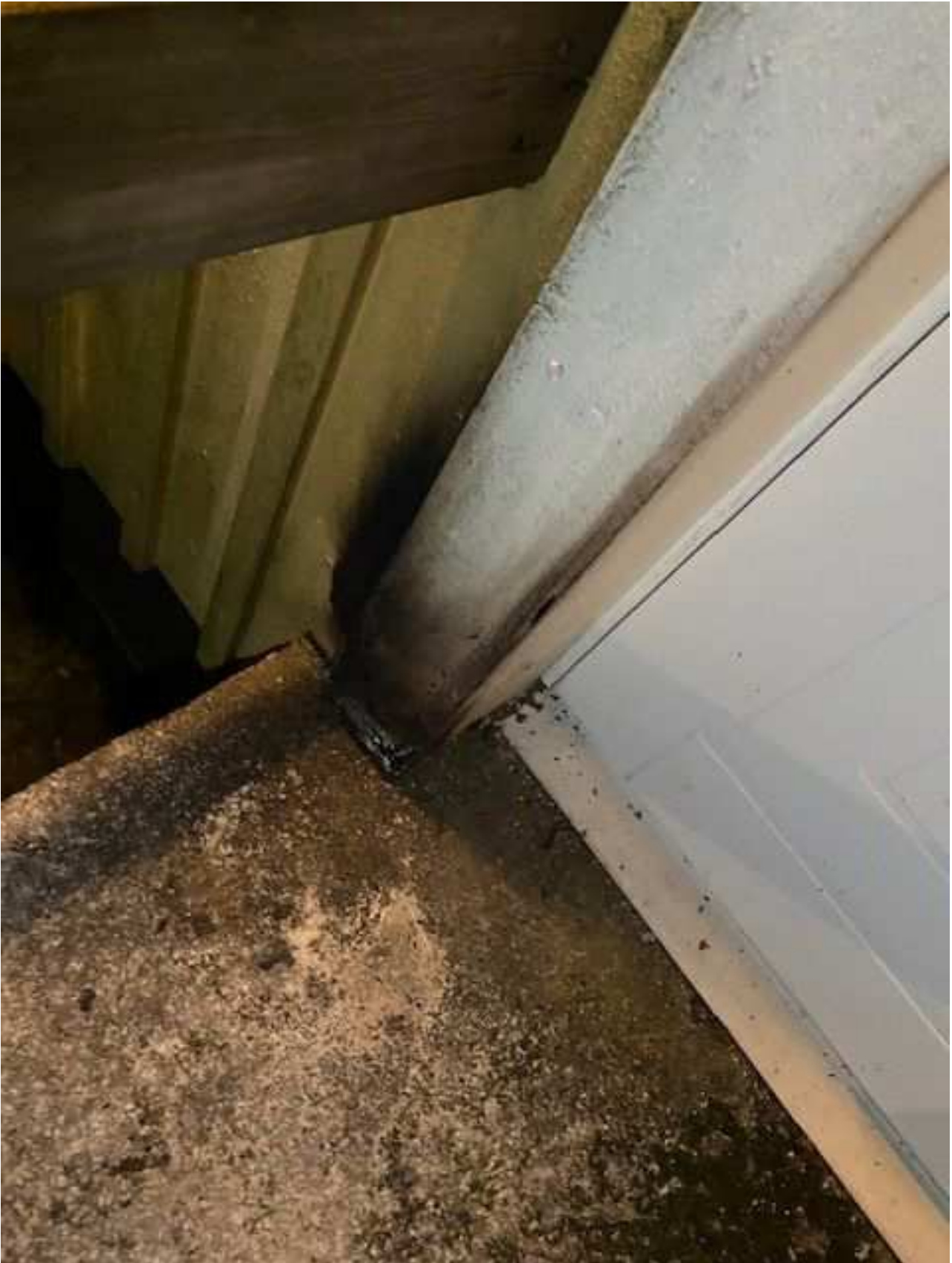
6. Skador på dörrfodret. Bilden är tagen av Martin Fröding, pojkvän till My Tönnies. Martin lämnade in bilden till polisen.
