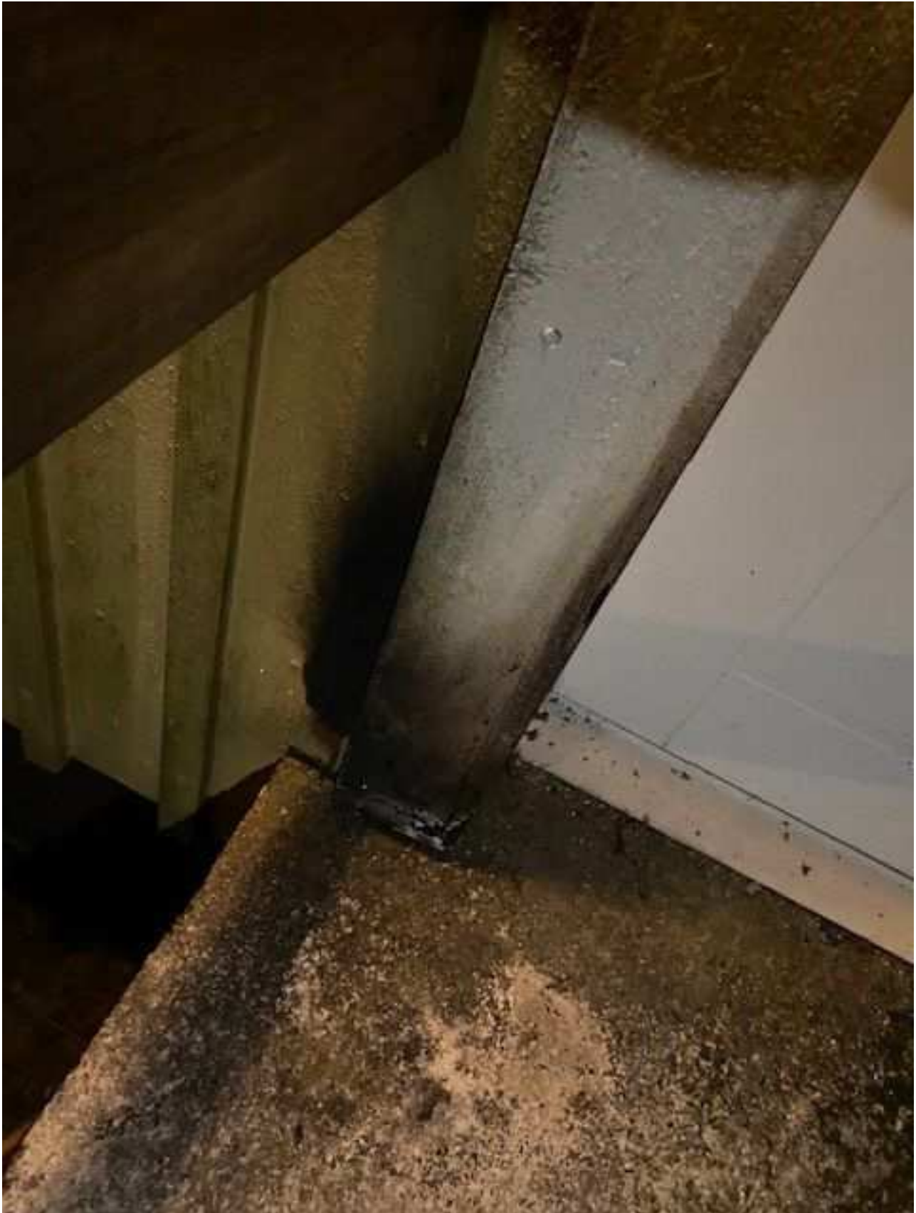
7. Skador på dörrfodret. Bilden är tagen av Martin Fröding, pojkvän till My Tönnies. Martin lämnade in bilden till polisen.
