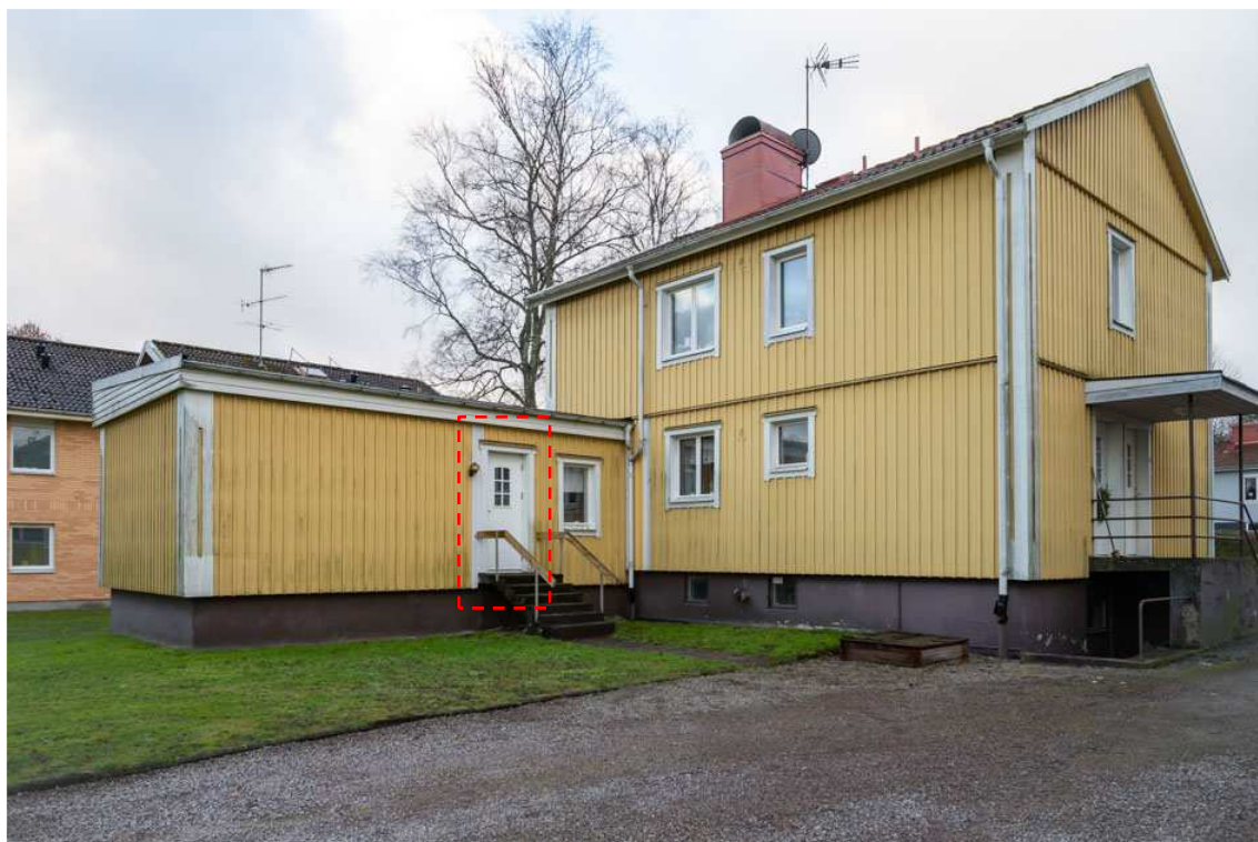
Bild 3. Vintergatan 16, baksida. I bilden markeras brandskadornas placering
