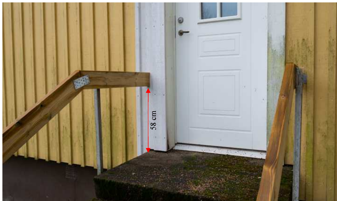
Bild 5. I bilden markeras kvarvarande brandskada och avstånd till räcket underkant
