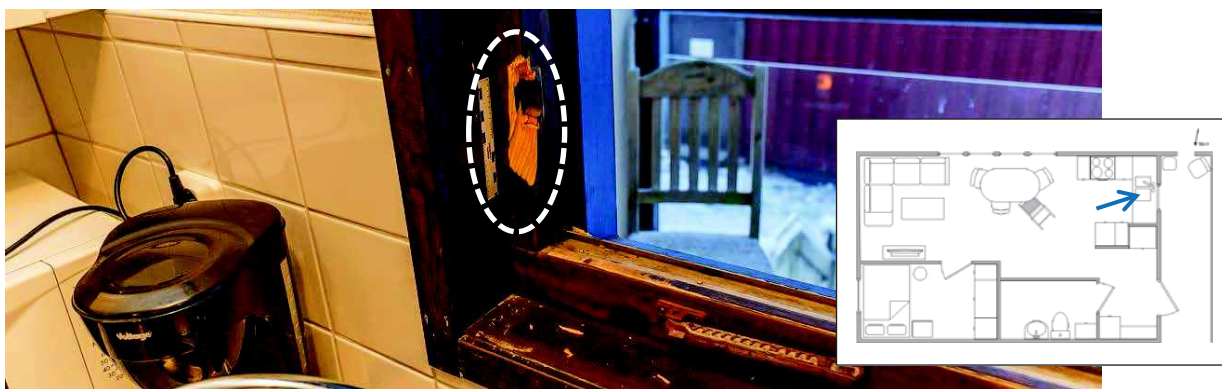
Bild 35. Skador på köksfönstrets nedre del av karmen, insidan.
