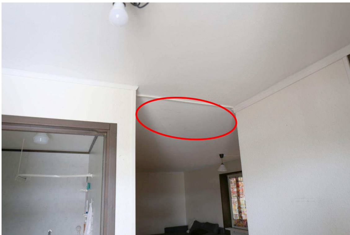
Bild 17. På bilden har område i taket där skospår kunde iaktas markerats med en cirkel. Bilden är tagen från hallen i riktning mot badrum och vardagsrum.
