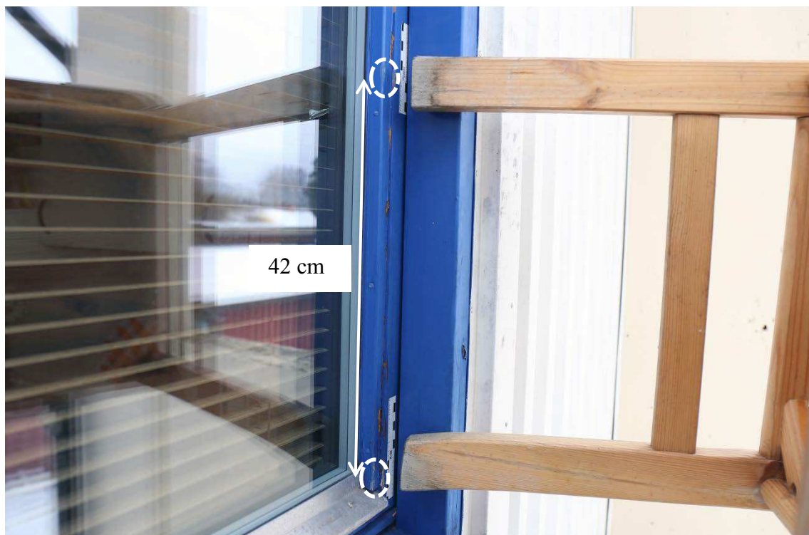
Bild 33. Trästolen på loftgångens utsida i jämförelse med skadorna på fönsterbågen på köksfönstrets utsida.
