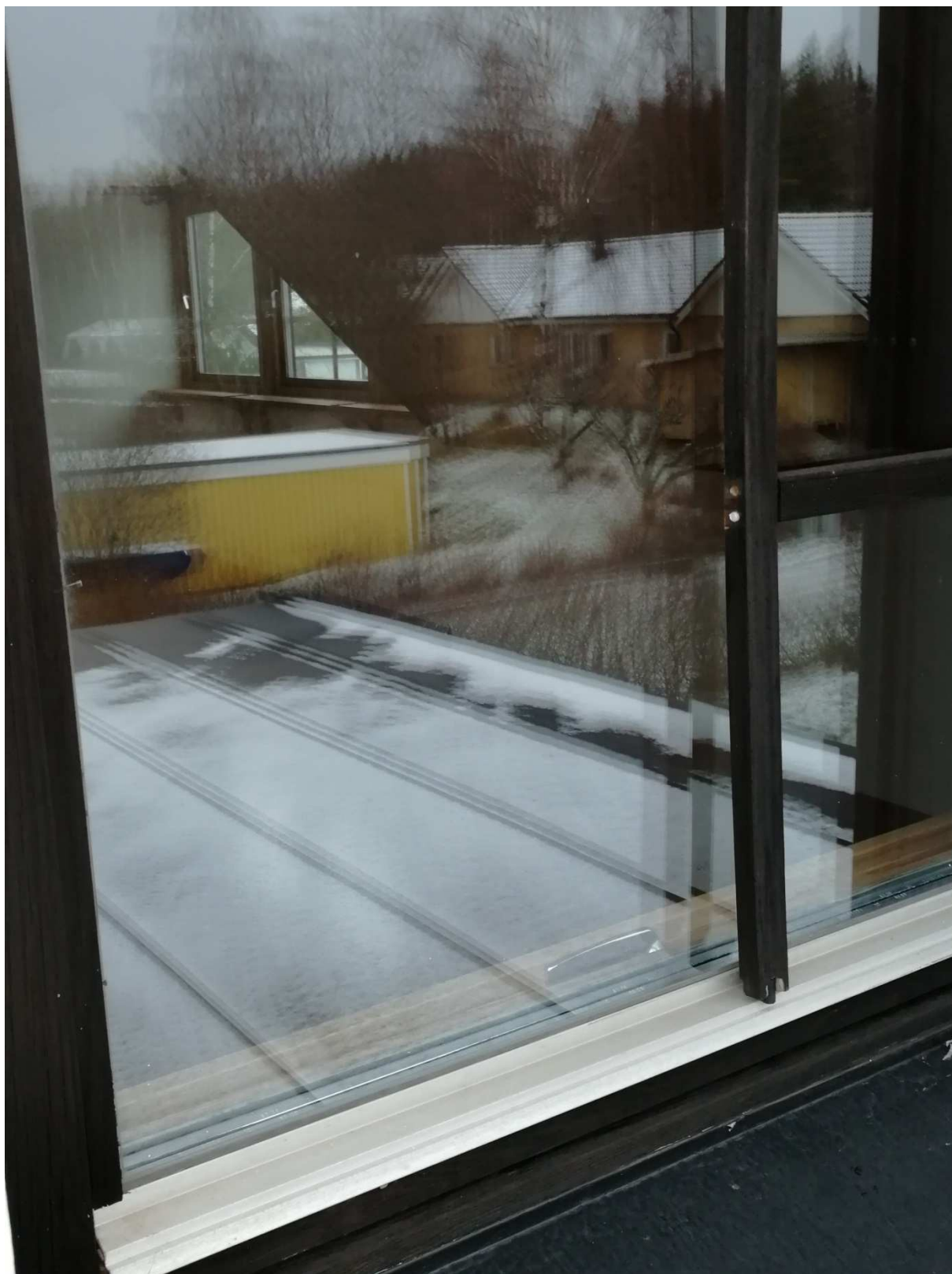
Bild på trasig spröjs, fönster ovanför garaget (ovanvåningen, allrummet).
