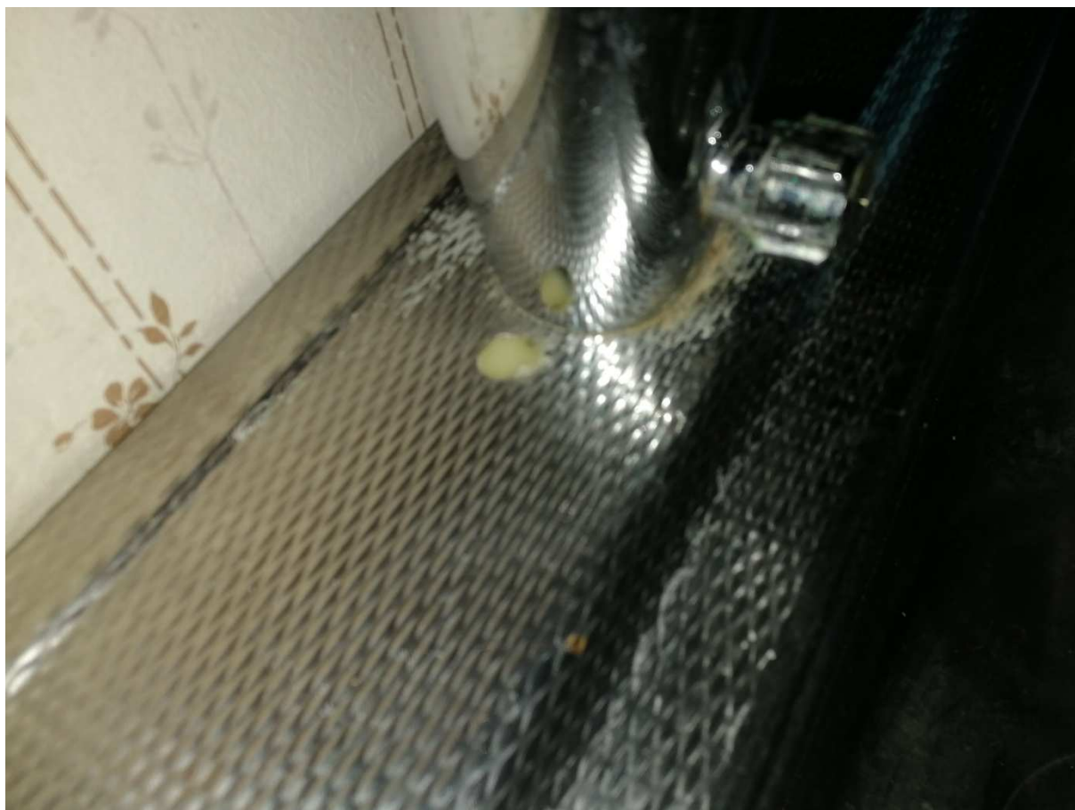
Diskho i tvättstugan. Smuts och kalkavlagringar. Inte åtgärdat av Zlatko.
