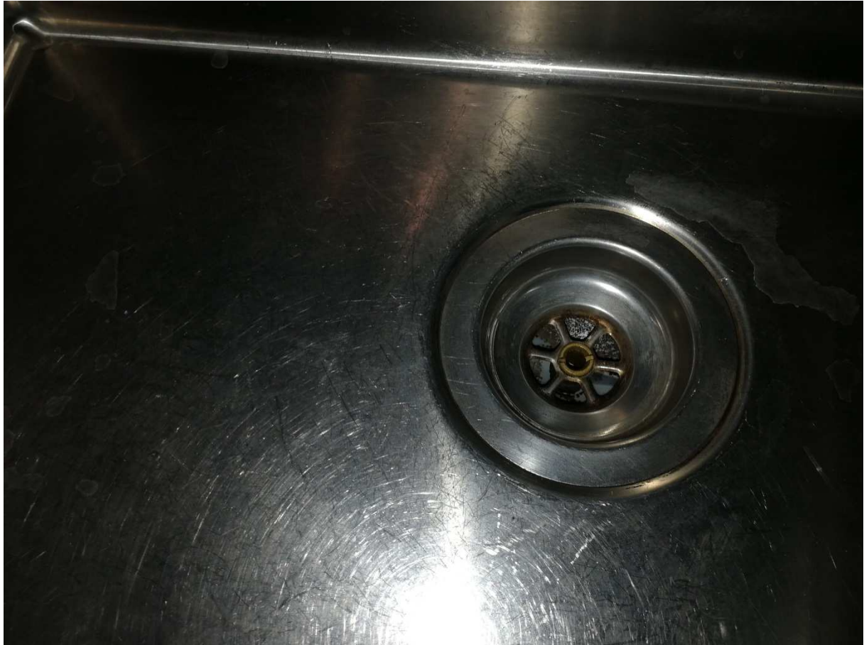
Diskoho i köket. Fotograferat eftersom det inte var rengjort i avloppet.
