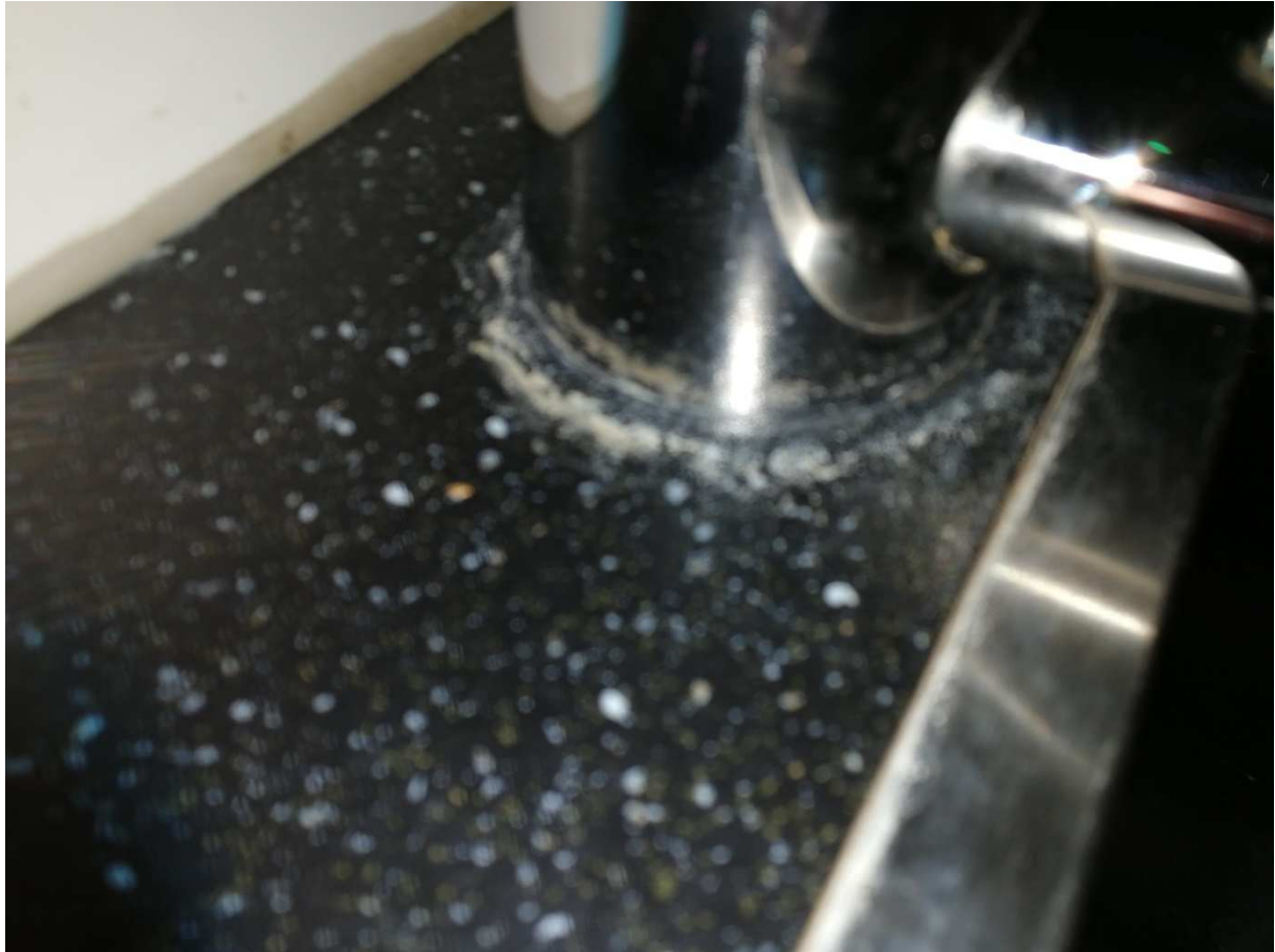
Kran i köket. Fotograferat eftersom det var kalk runt kranens fäste.
