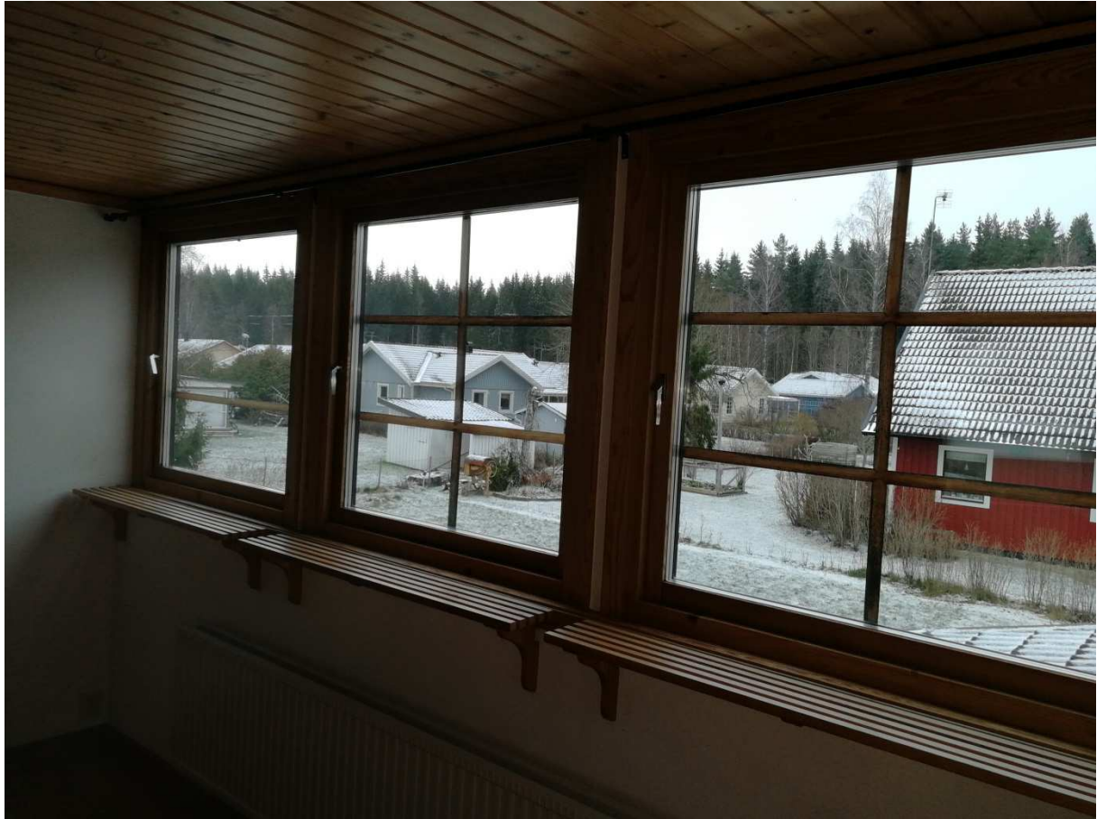
Fönster i allrummet, fönstret längst till vänster är fotograferat tidigare med trasig spröjs.
