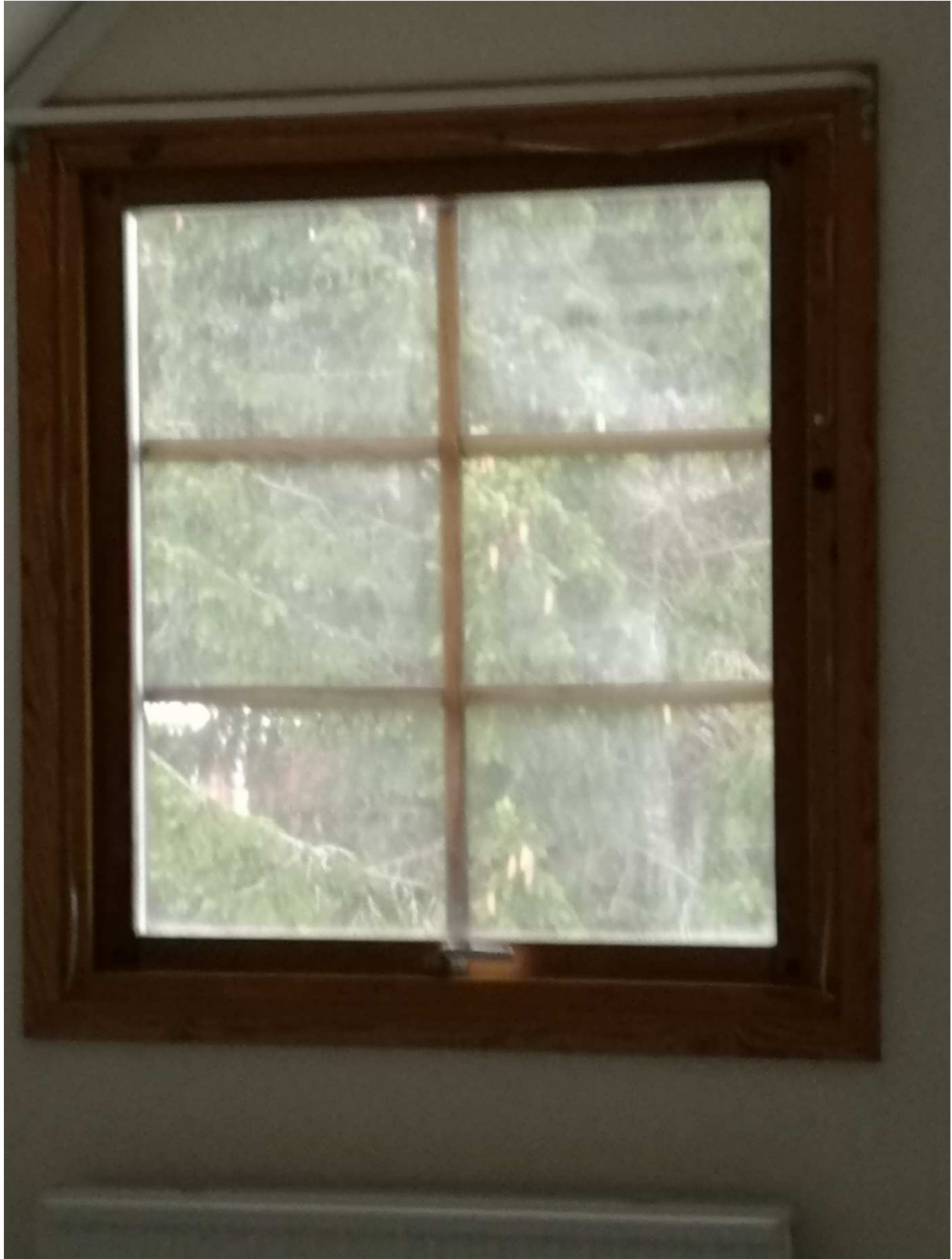
Bild på sovrumsfönster, vänstra sovrummet på ovanvåningen. Fönstret var mycket smutsigt samt att det var fukt mellan glasen.
