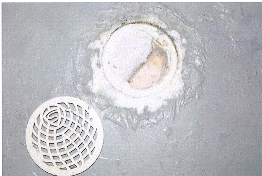
Figur 19. Golvbrunnen efter att silen lyfts bort.
