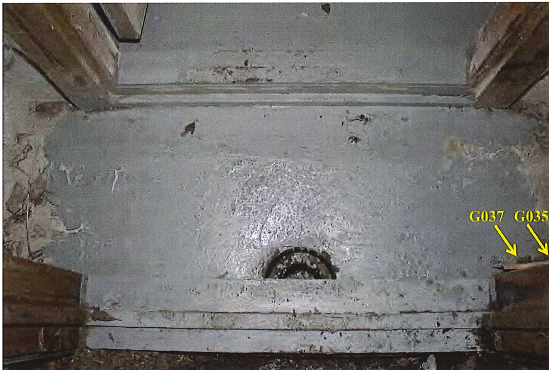
Figur 18. Golvet mellan de två dörrarna. Bilden är tagen in mot jordkällaren. Tuben med spackelhärdare (G035) samt spackelspaden (G037) är markerade.
