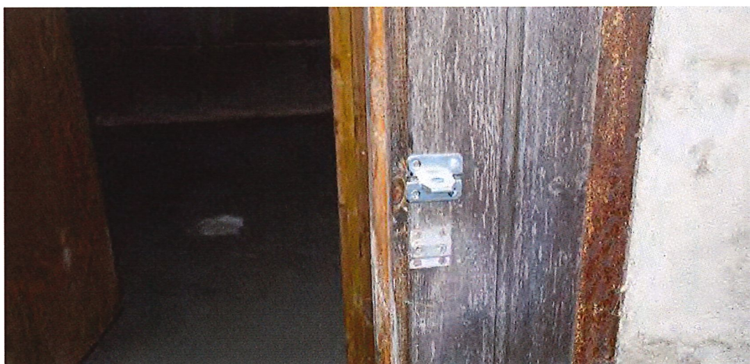
Figur 15. Låsbygelbeslagen. Den översta låsbygeln var den som var komplett.
