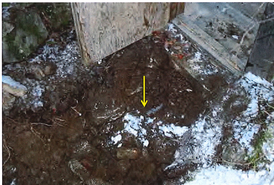
Figur 26. Avloppsröret mynnade ut ca 50 cm utanför entrédörren, se markering.
