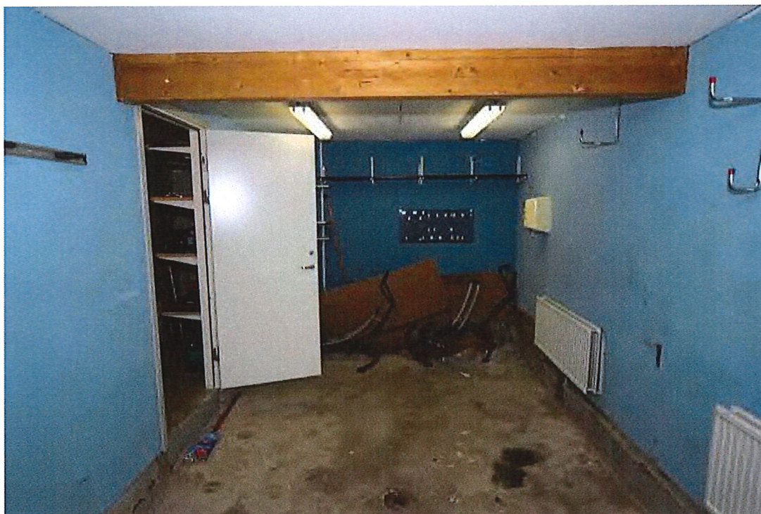
Figur 52. Garaget sett från porten. På golvet i höjd med dörren ligger en öppen golv-mopp.
