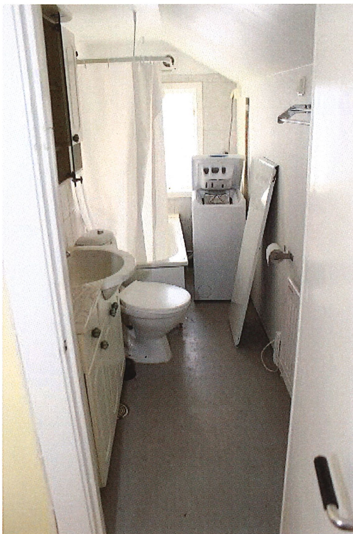
Figur 9. Badrum med tvättmaskin.
