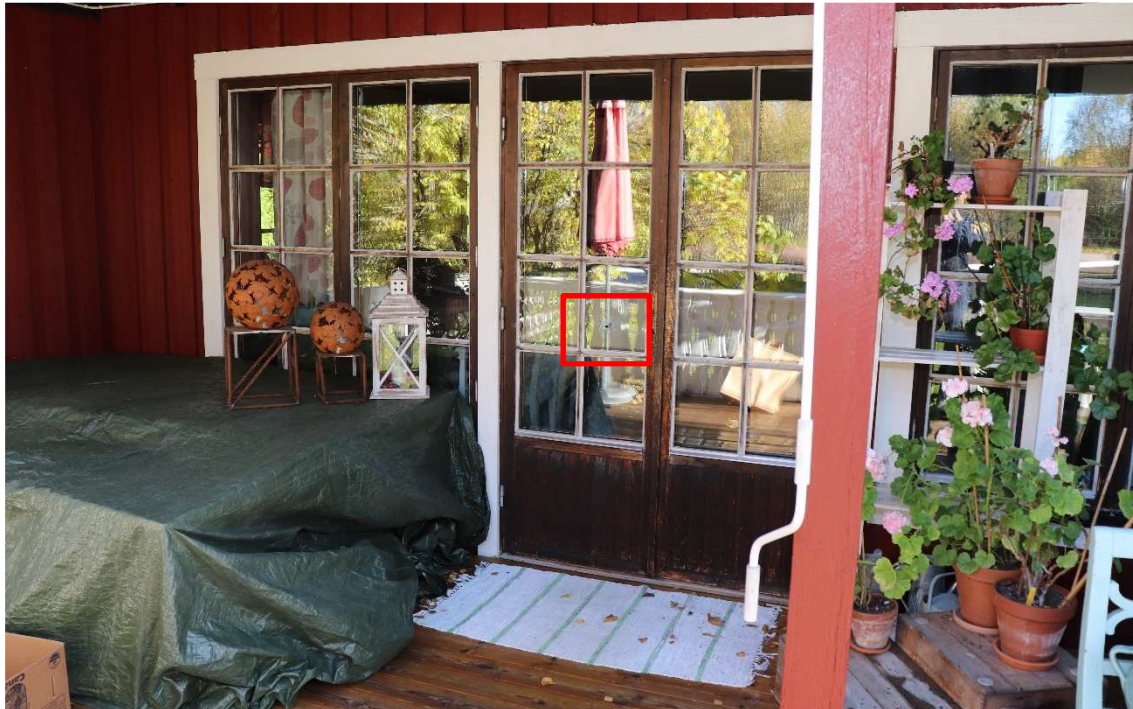
Figur 8. Bild tagen mot altandörren på Sandsäterbrovägen 61. Skotthålet markerat med röd ram.
