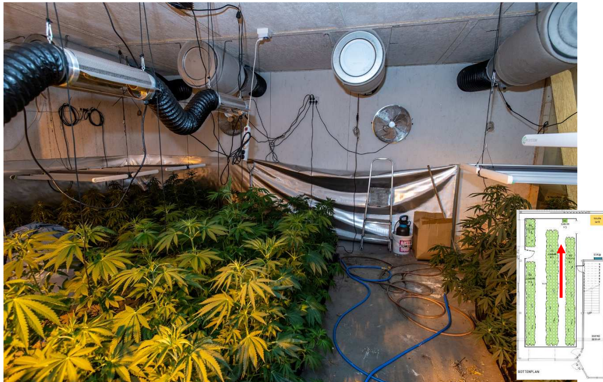
Figur 23. Östra delen av odlingsrummet med utsugsfläktarna i taket.
