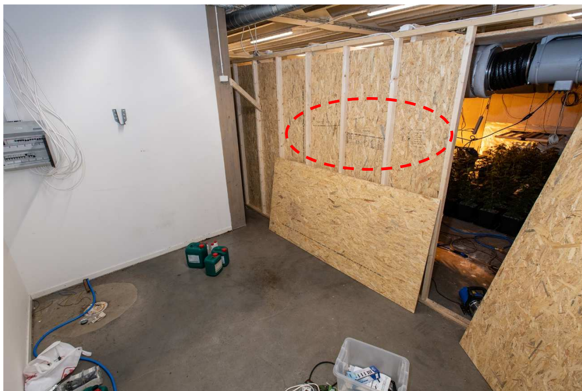
Figur 16. Sidoutrymmet med öppningen in mot odlingsrummet. På golvet i odlingsrummet skymtar den blå vattenpumpen.
