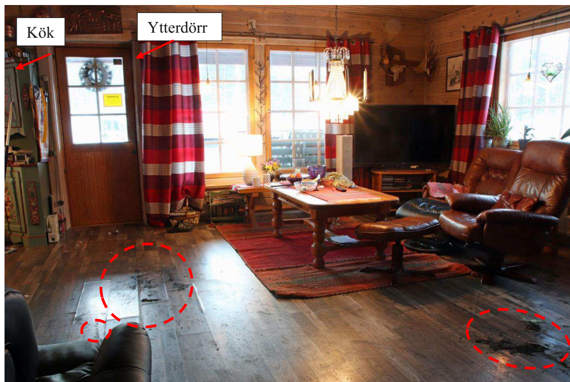
Bild 10. Vardagsrummet med markeringar där värme/brandskadade märken iakttagts på golvet. Fotoriktning från hallen utanför badrummet mot ytterdörren.
