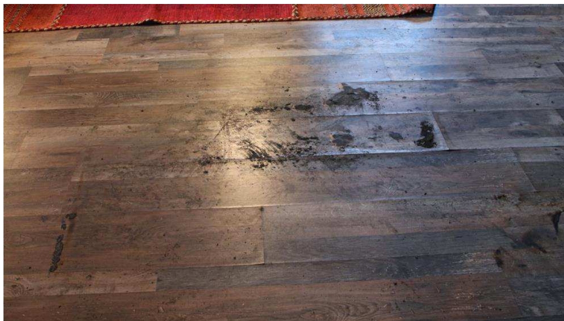
Bild 12. Värme/brandskadade märken och sot på golvet i området framför ytterdörren.
