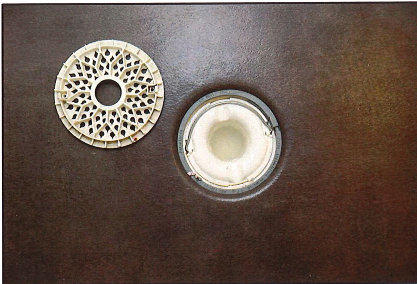
Figur 13 visar golvbrunnen vid duschen.
