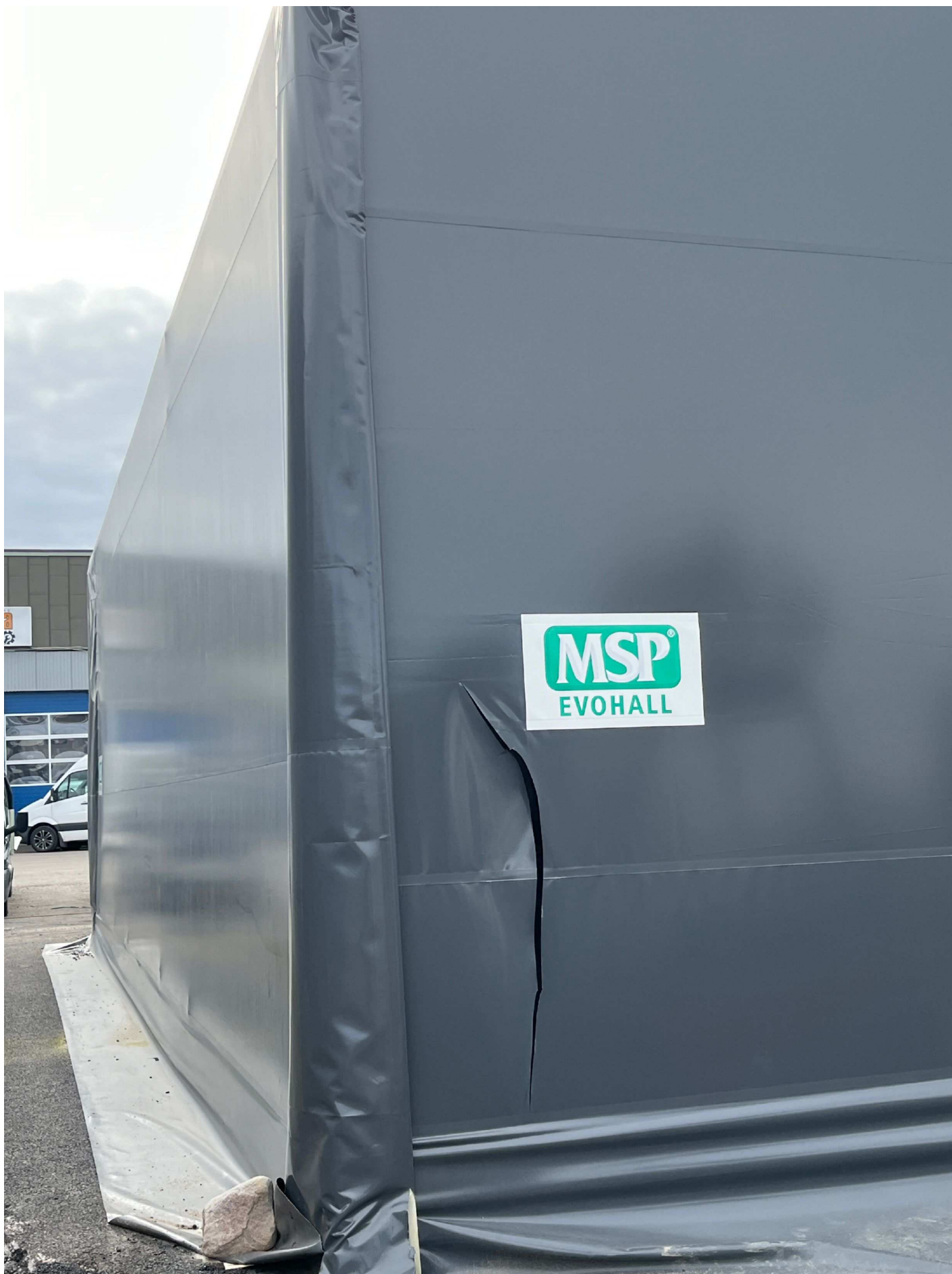
2. Fotografi taget av pa A Stuge 240820 kl 12.51 på Oljevägen 11 Hydralservice, Gällivare. Fotografiet förställer uppskuren tältduk i tält nr 2 (västra tältet) bild tagen från baksidan.
