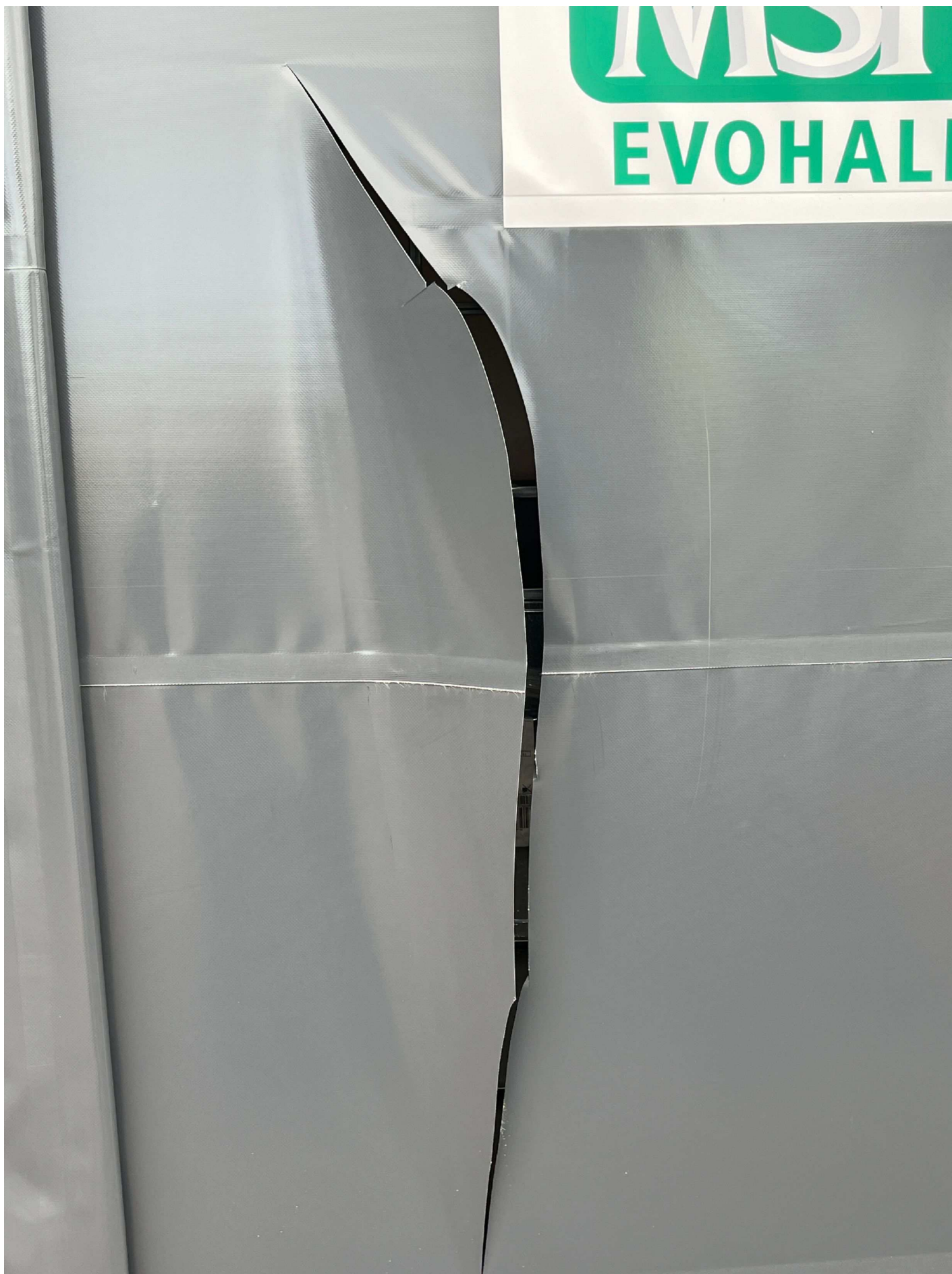
3. Fotografi taget av pa A Stuge 240820 kl 12.51 på Oljevägen 11 Hydralservice, Gällivare. Fotografiet förställer uppskuren tältduk i tält nr 2 (västra tältet) bild tagen från baksidan.
