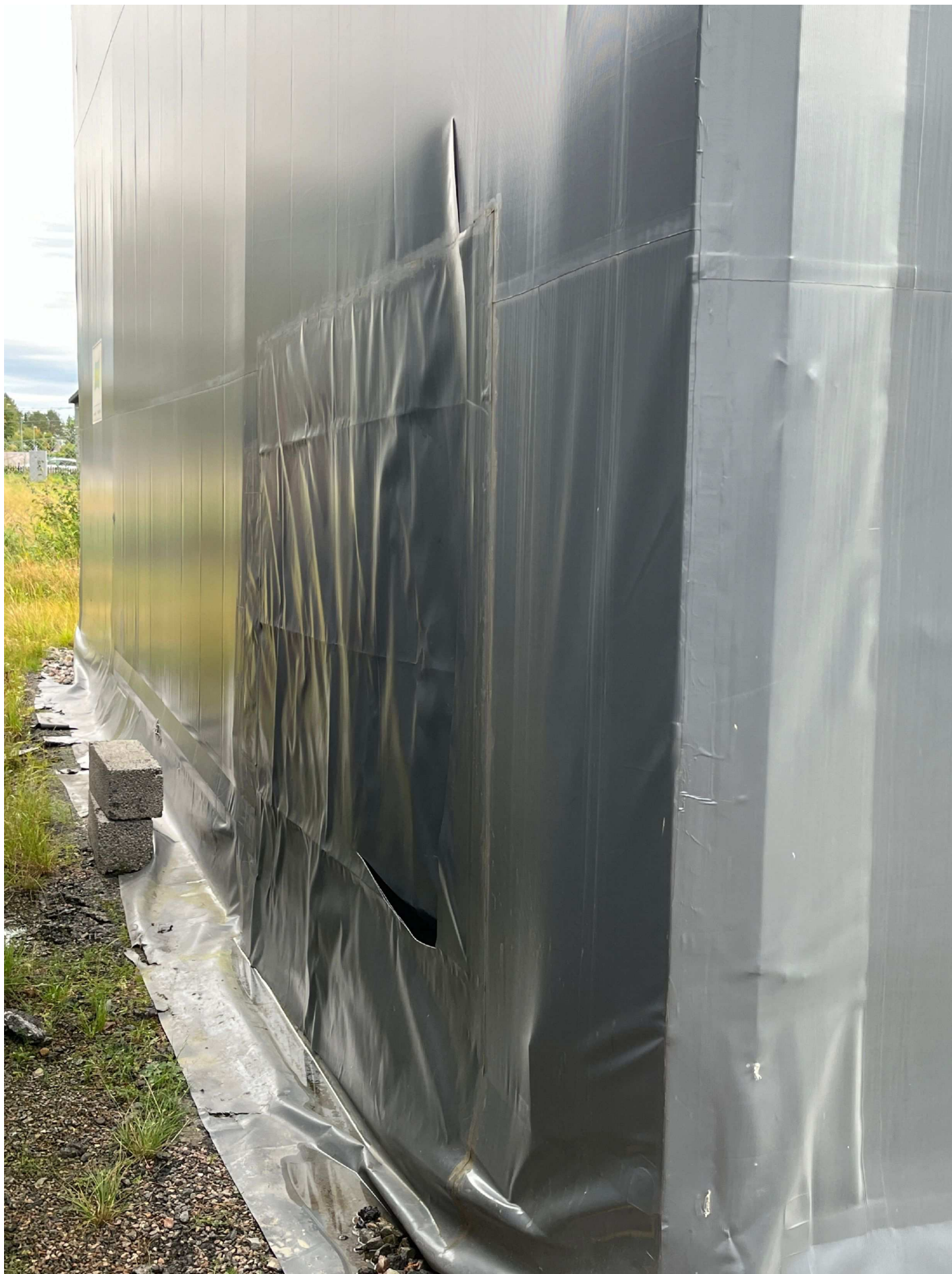
6. Fotografi taget av pa A Stuge 240820 kl 12.51 på Oljevägen 11 Hydralservice, Gällivare. Bilden visar uppskuren ingångsöppning baksidan av tält 1, bilden taget utifrån.
