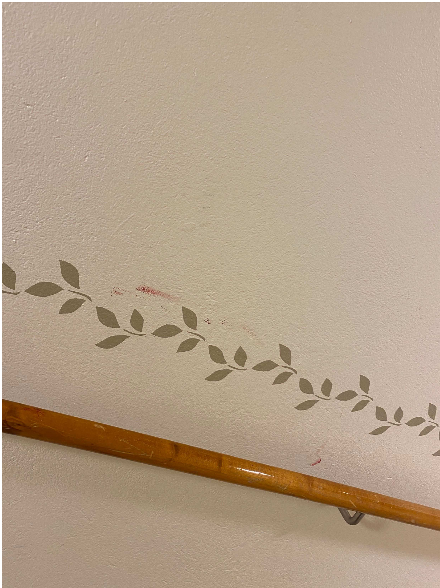
31. Målsägandens trapphus. Misstänkt blod på väggen. Sista trappan upp till målsägandens lägenhet. Foto: Klara Nordell.
