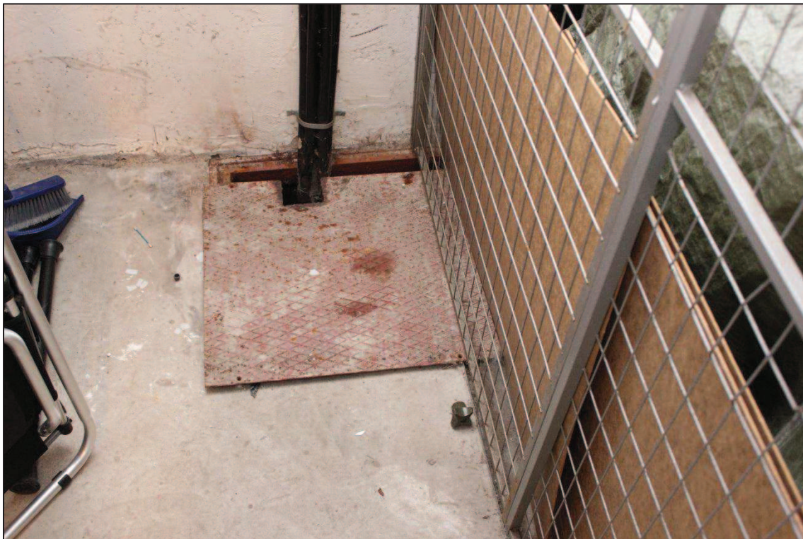
Foto 12. Visar metallocket över utrymmet under golvytan och elledningar på väggen
