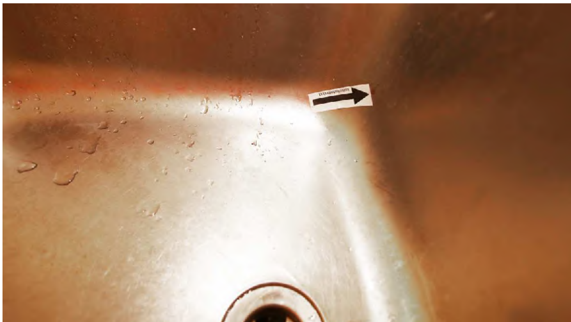
Figur 22 Bild på insidan av tvätthon och blodbesudling S010.
