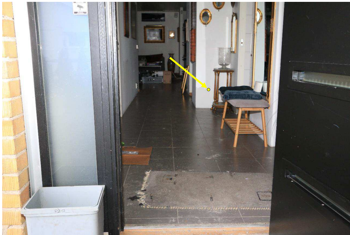
Figur 13. Fotot är taget utifrån och in genom öppna entrédörr. Markeringen visar placering av skottskadan på innerväggen. En piedestal är flyttad för fotograferingen.
