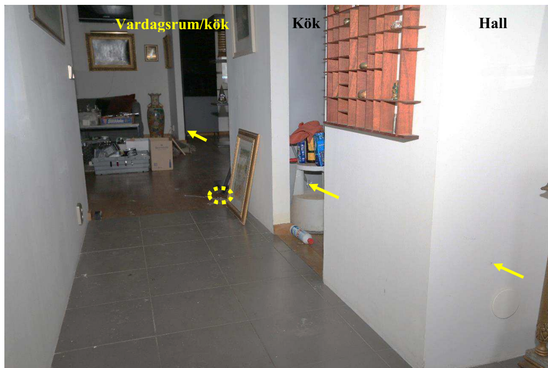
Figur 17. Markeringarna förevisar placeringar av skador orsakade av en kulprojektil. Rund markering visar avfyrad kulprojektil (G018).
