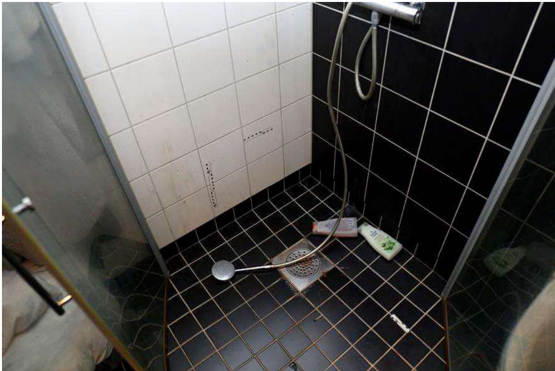
Bild 22. På locket till golvbrunnen i duschen, samt på väggen i duschen fanns rödfärgade besudlingar som bedömdes vara blod.
