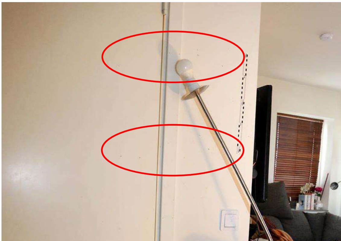
Bild 14. Stänk med utseende som blod kunde bl.a. ses på väggen vid förrådsdörren. Stänk av blod som på bilden markerats med elipser är belägna ca 120 – 180 cm ovanför golvnivå. Stänk med utseende som blod kunde ses även längre ner på samma väggdel.
