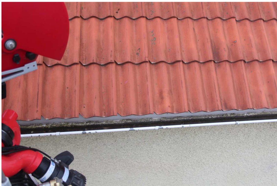
Hängrännan under vardagsrumsfönstret i den aktuella lägenheten
