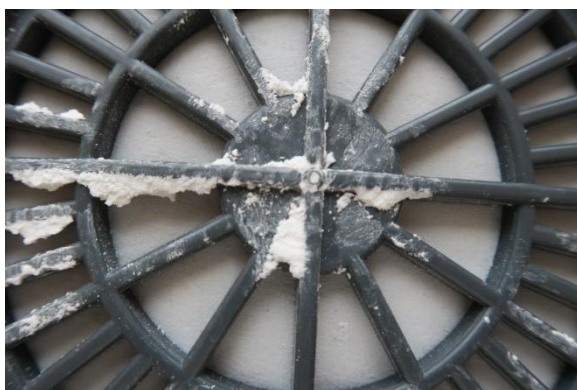
Pulveravsättning på filterhållarens framsida
