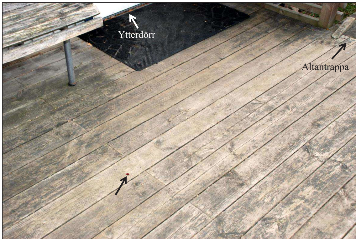
Bild 52. Blod som droppat på trädäcket vid ytterdörren mer i riktning mot det intilliggande bostadshuset jämfört med blodbesudlingarna i bilderna 49-51.
