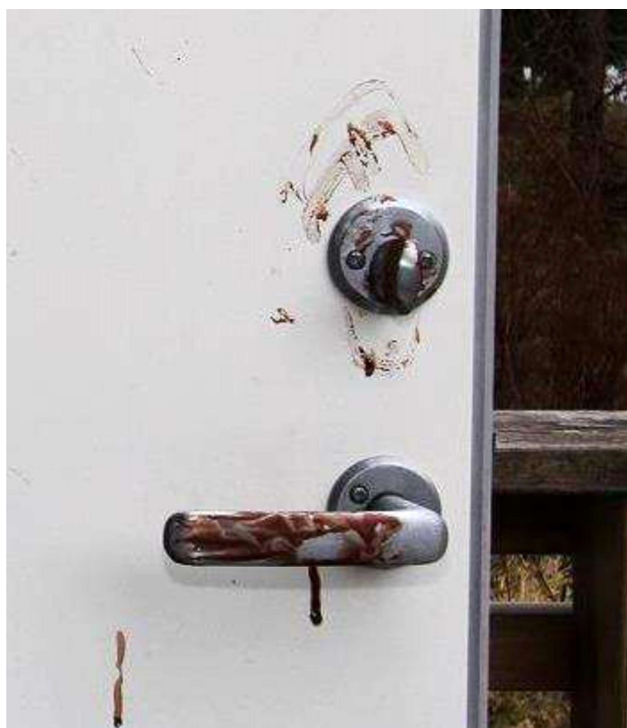
Figur 5. Låsvred och handtag på dörrbladets insida av entrédörren (IMG_7050.JPG)
