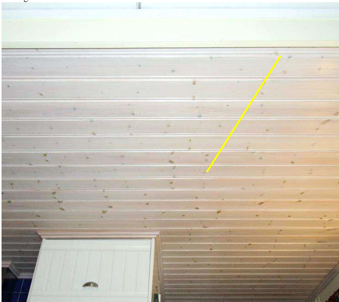
Figur 10. Markering visar avkast i taket (IMG_7028.JPG)
