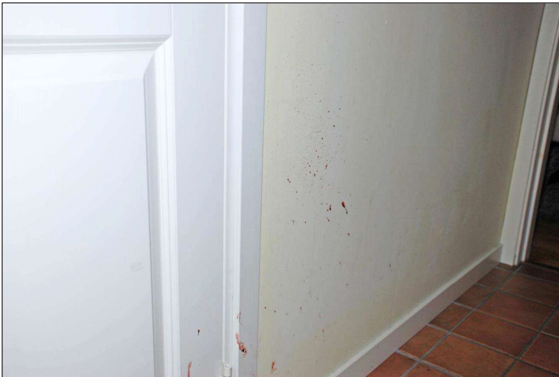
Bild 20. Blodstänk på väggen i hallen mellan sovrummet och badrummet.
