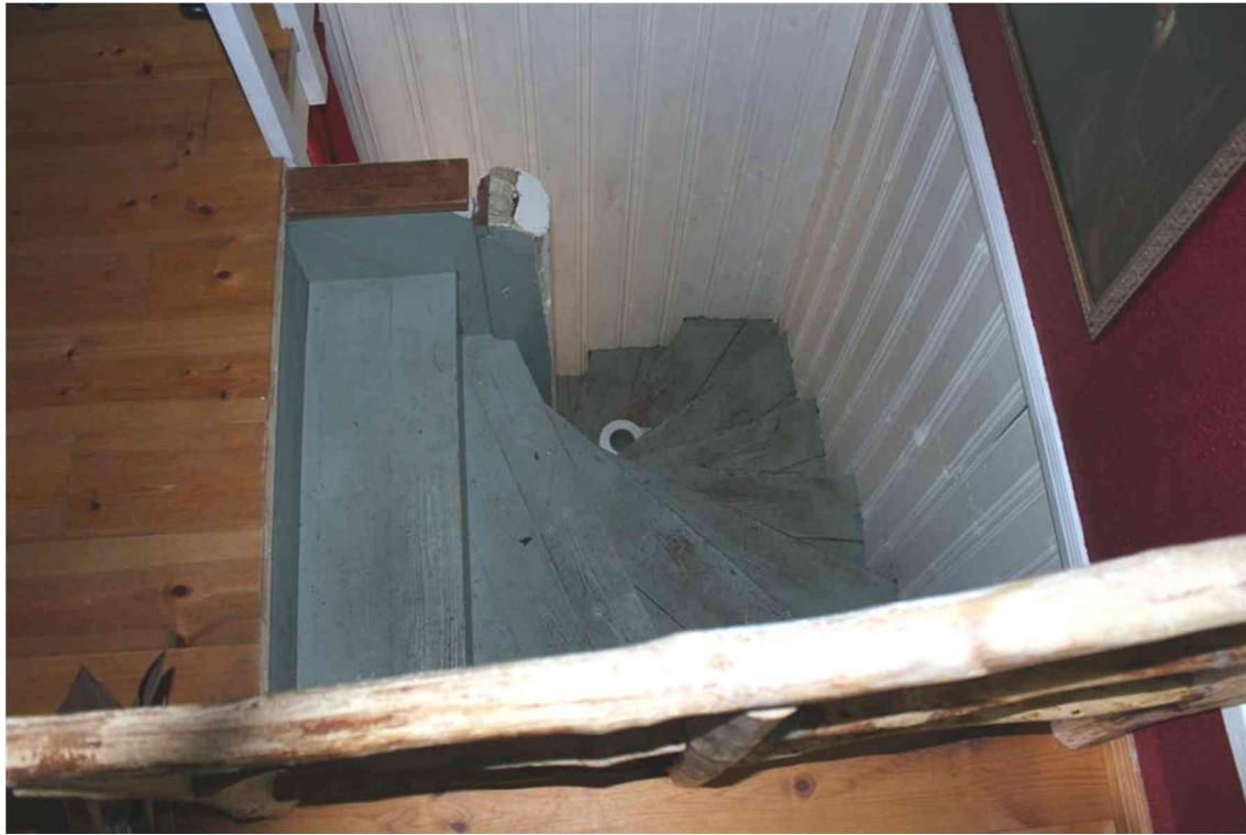
Bild 16. Brant trappa mellan under och övervåning
