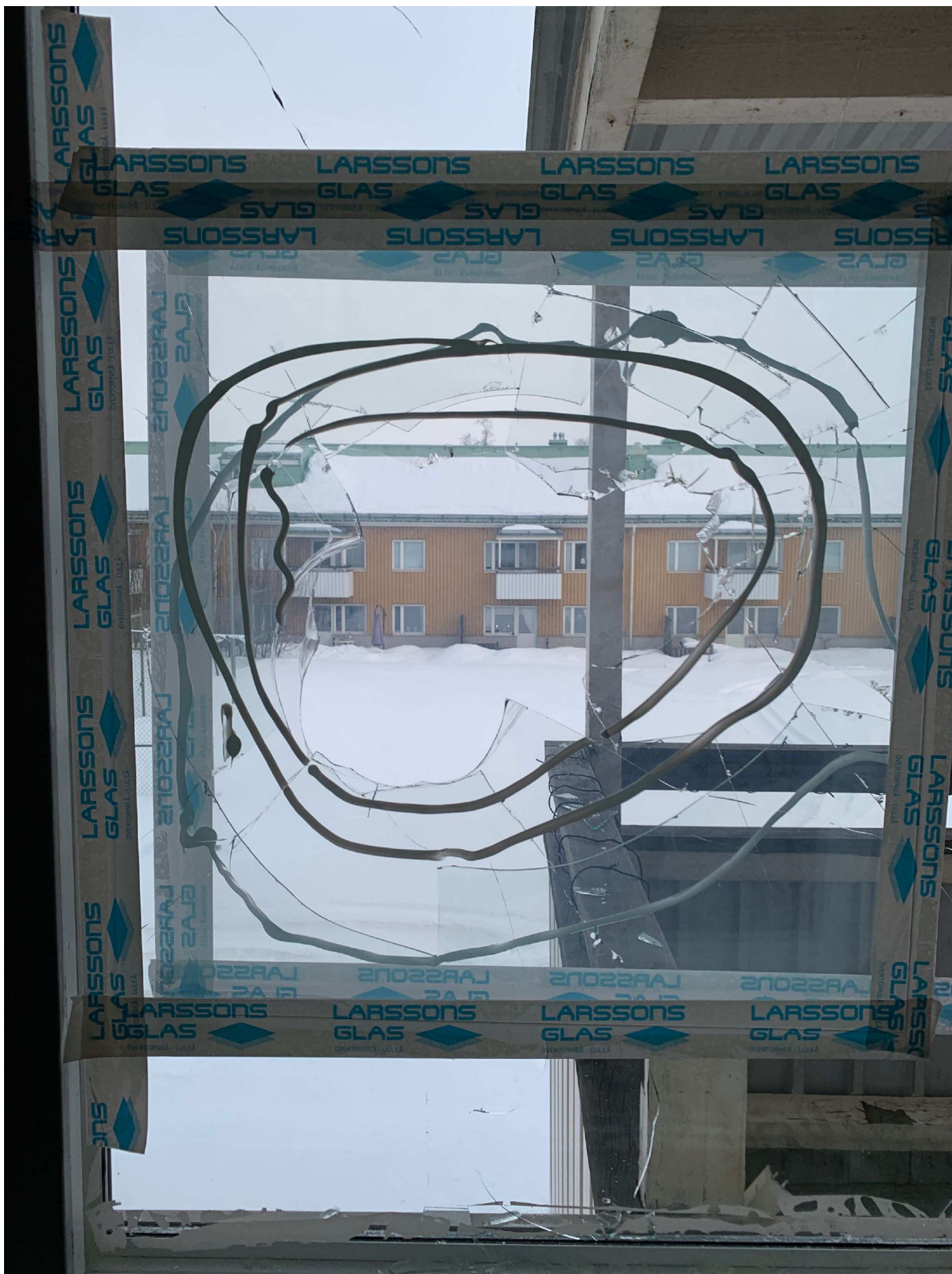
45. Översiktsbild på trasigt fönster i vardagsrummet.
