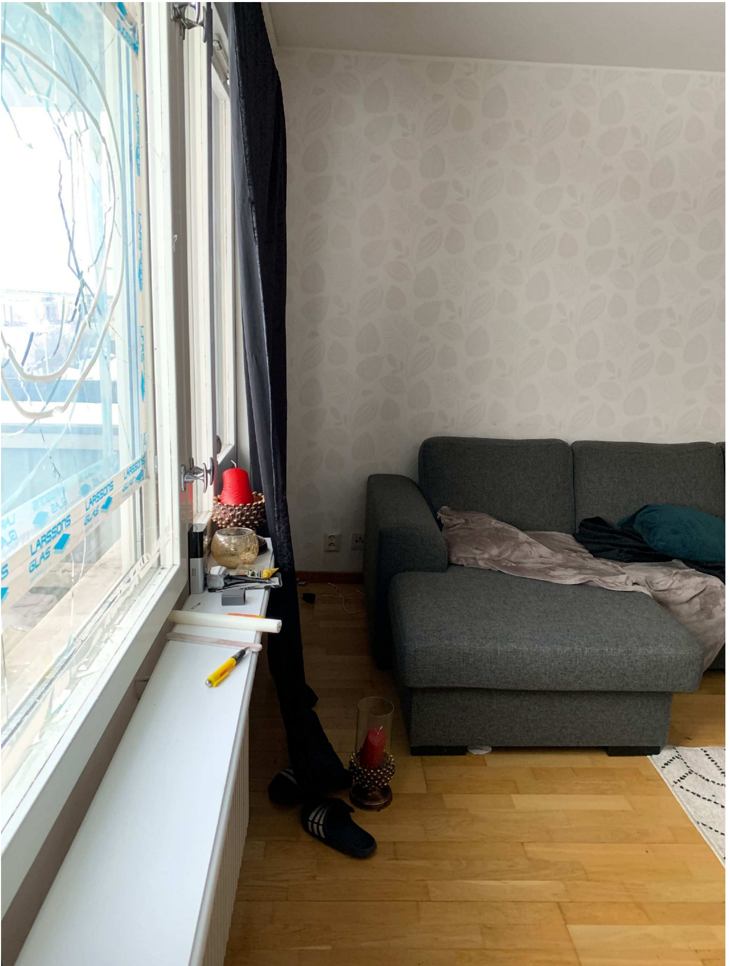
42. Översiktsbild över vardagsrummet. Till höger syns ett trasigt fönster.
