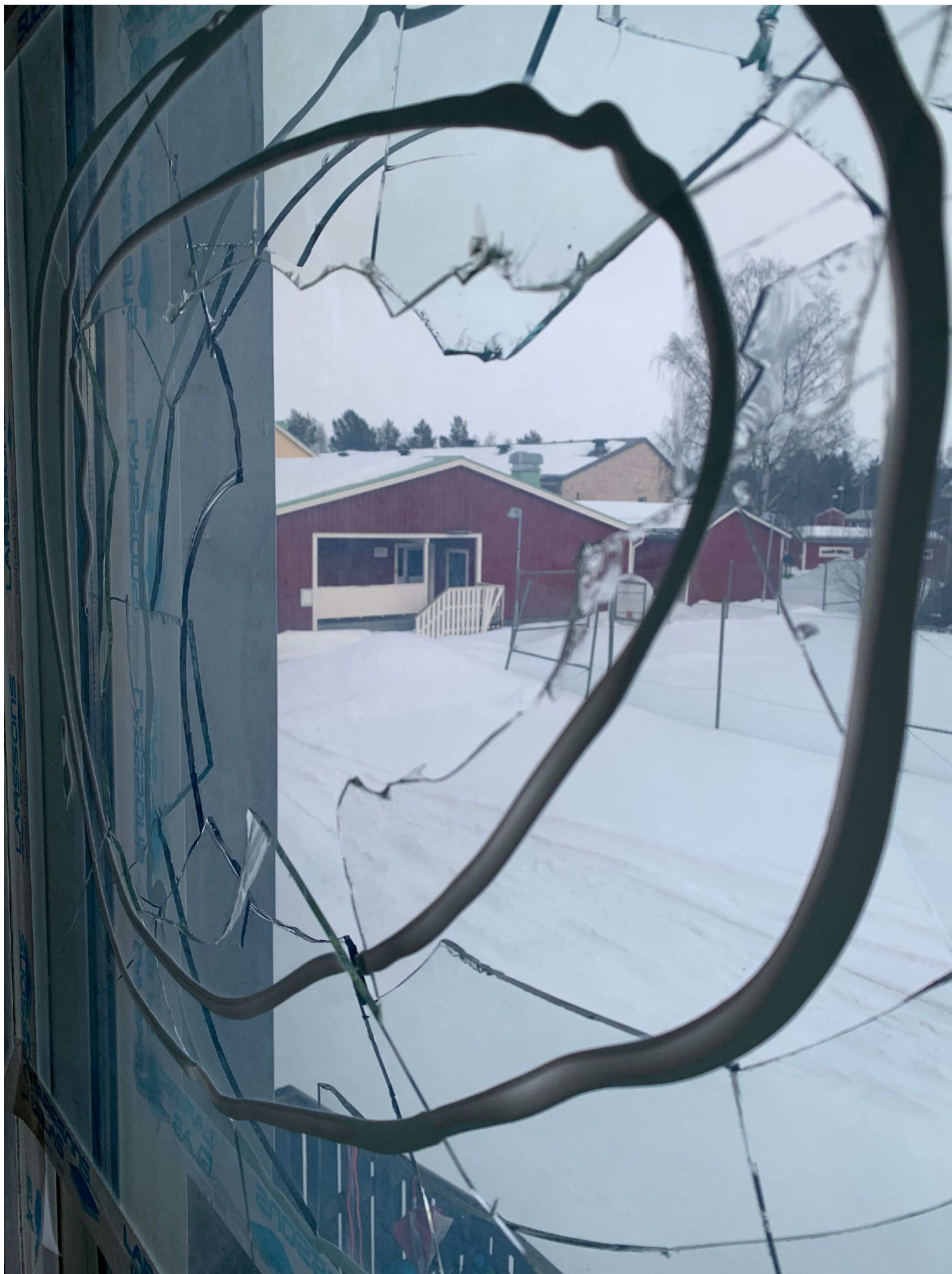
47. Närbild på trasigt fönster i vardagsrummet.
