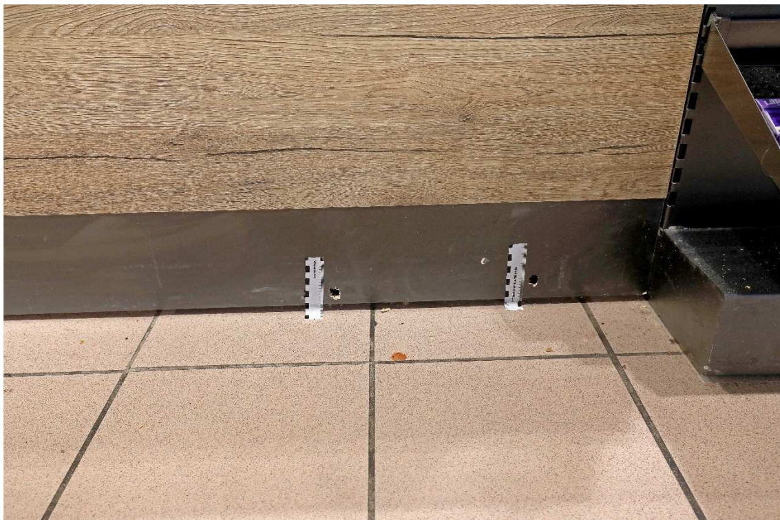
Bild 9. Skotthål i golvsockel i kassadisk.
