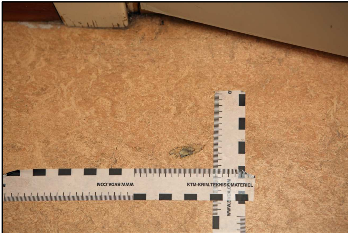
Bild 18. Skadan i golvet i hallen. Skadan testades med Bullet-hole Testing Kit (BTK). Testet gav ej utslag för bly eller koppar.
