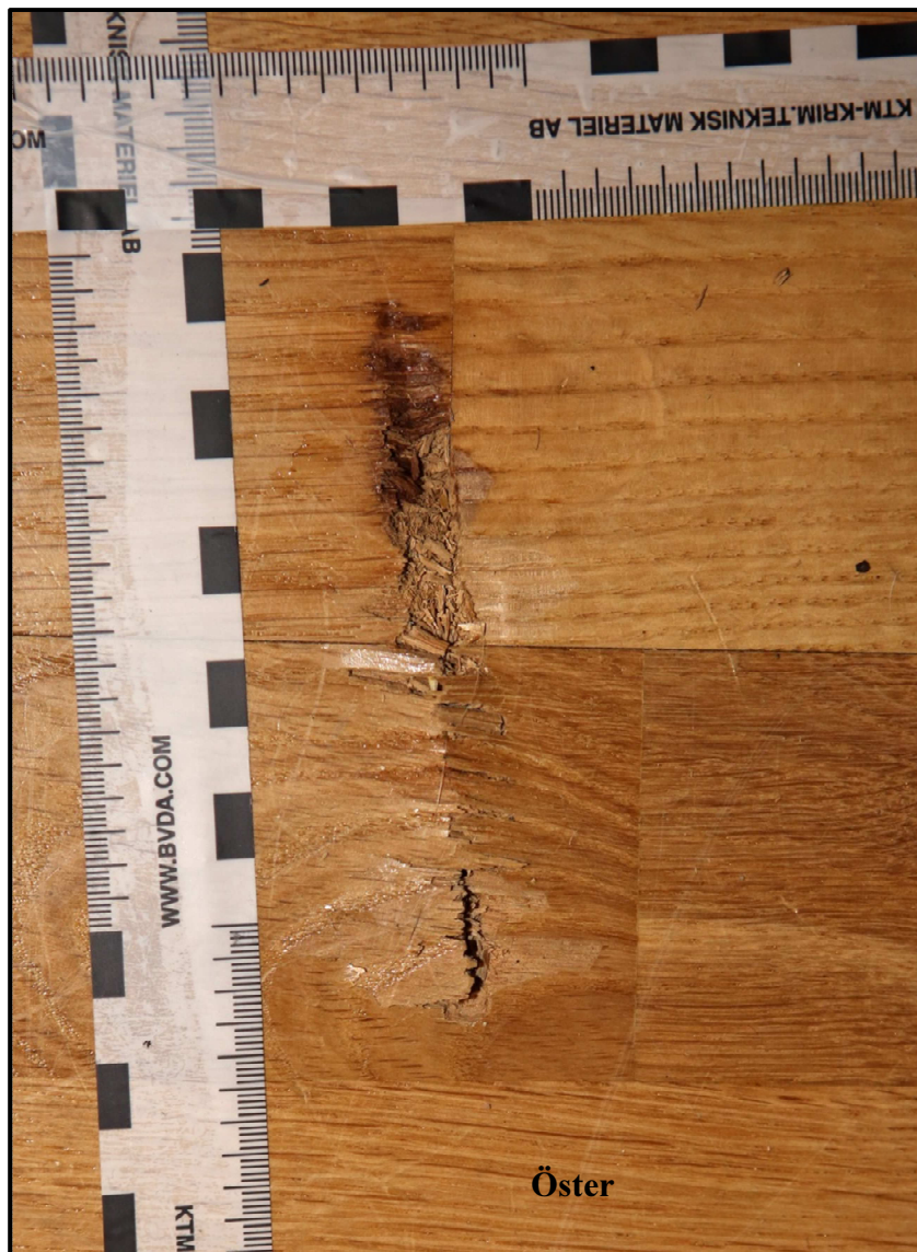
Bild 24. Skadan i golvet i närbild.
