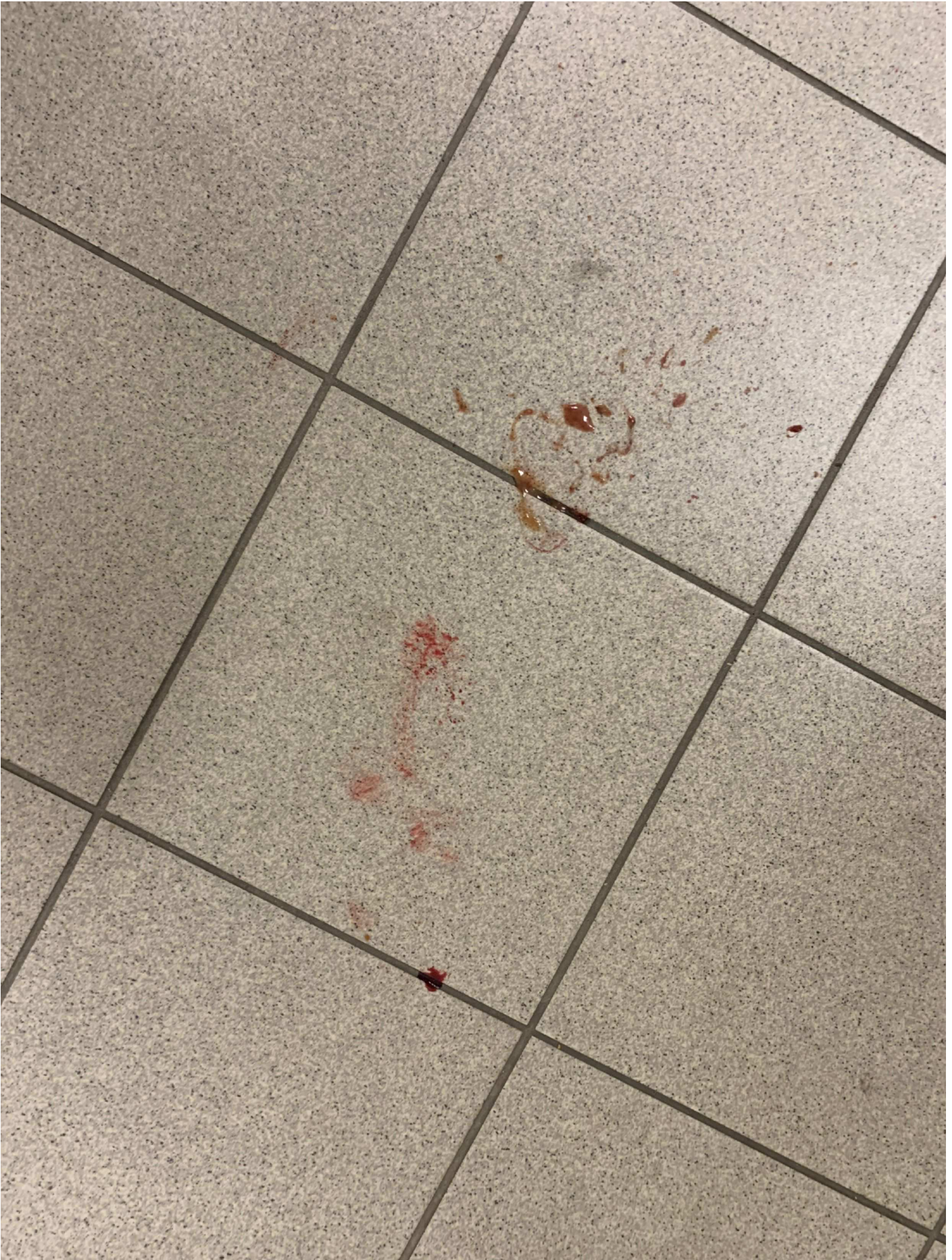
6. Bilden visar misstänkt blodspillning på golvet inne i väktarrummet. Bilden är tagen av PA E Edman. 2021-10-11.
