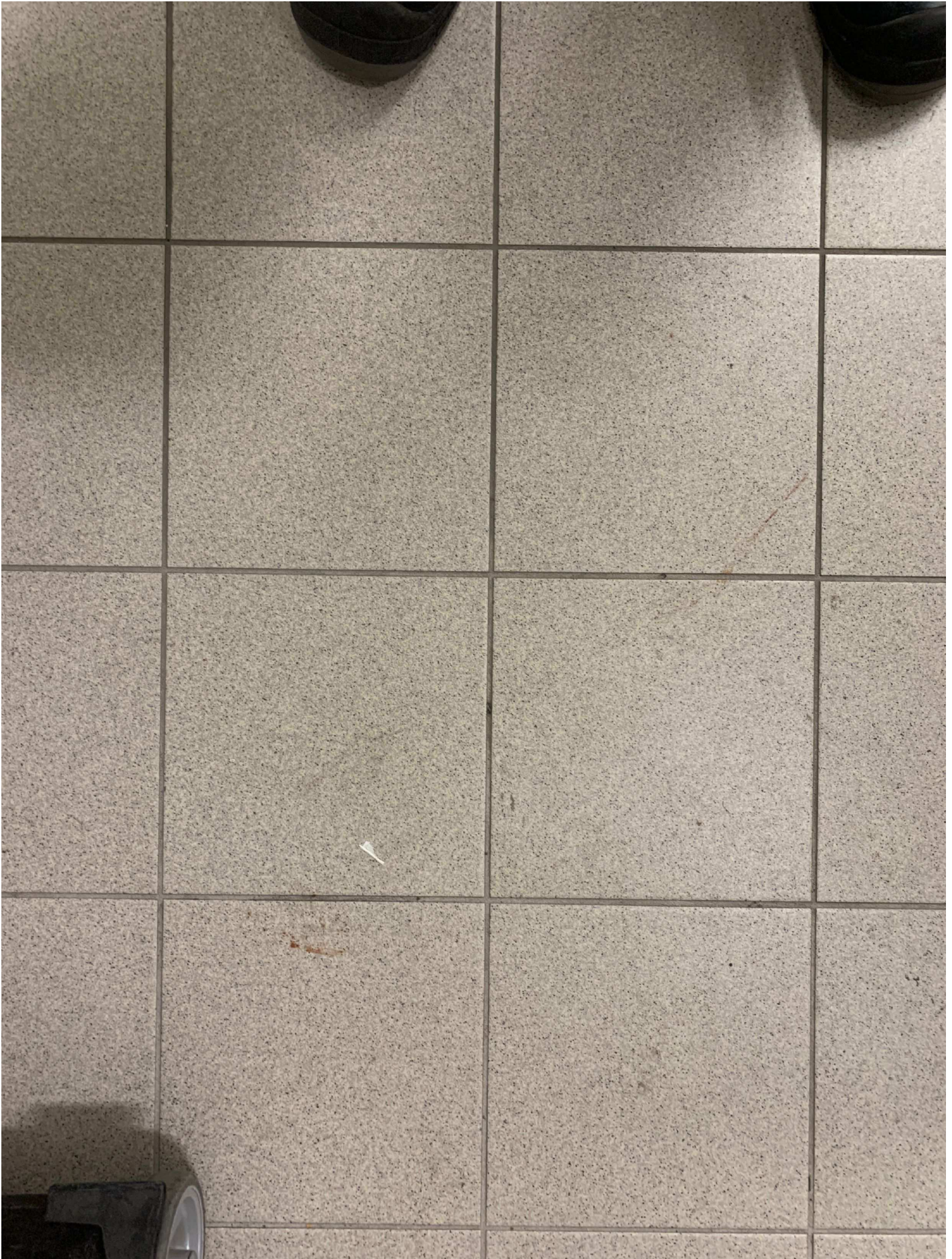
3. Bilden visar misstänkt blodspillning på golvet inne i väktarrummet. Bilden är tagen av PA E Edman. 2021-10-11.
