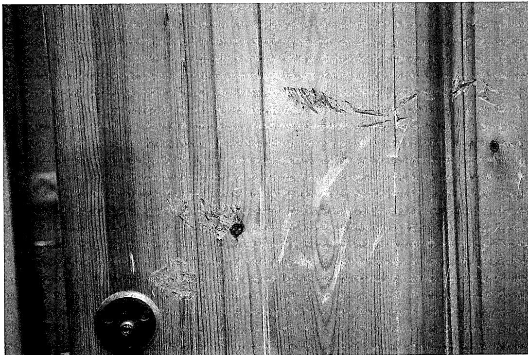
Figur 22. Närbild av skador på utsidan av dörren till stora badrummet.
