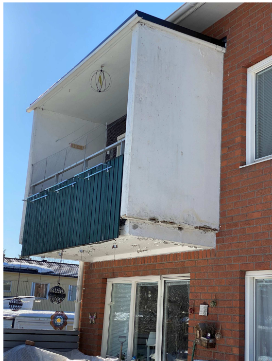
Bild på större frostsprängningar
