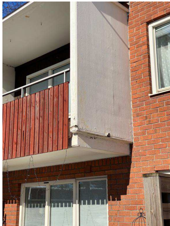
Bild på mindre frostsprängningar
