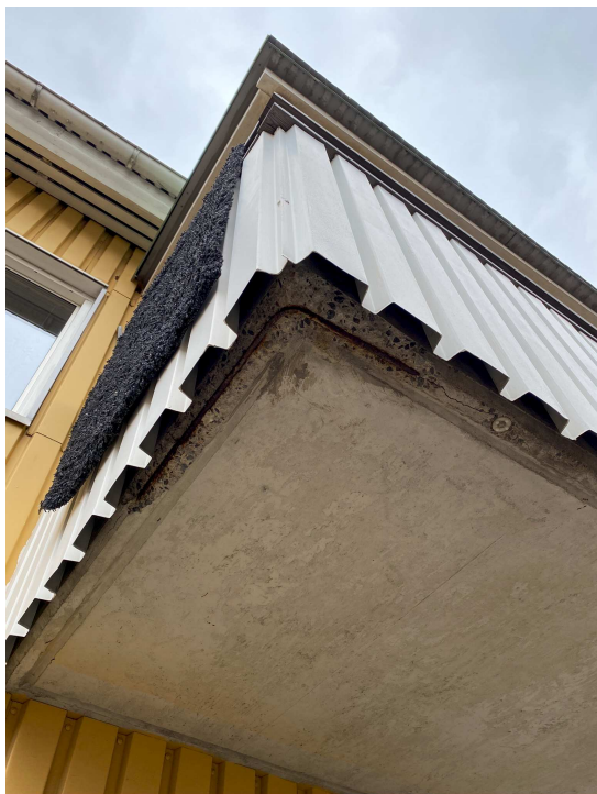
Bild på större frostsprängningar
