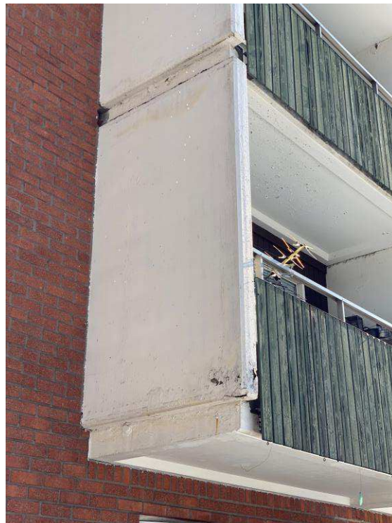
Bild på mindre frostsprängningar
