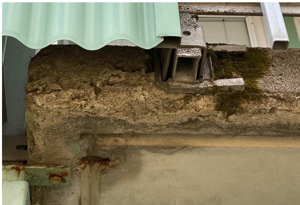
Bild på mindre frostsprängningar
