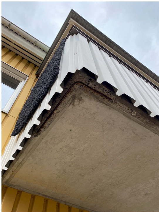
Bild på större frostsprängningar
