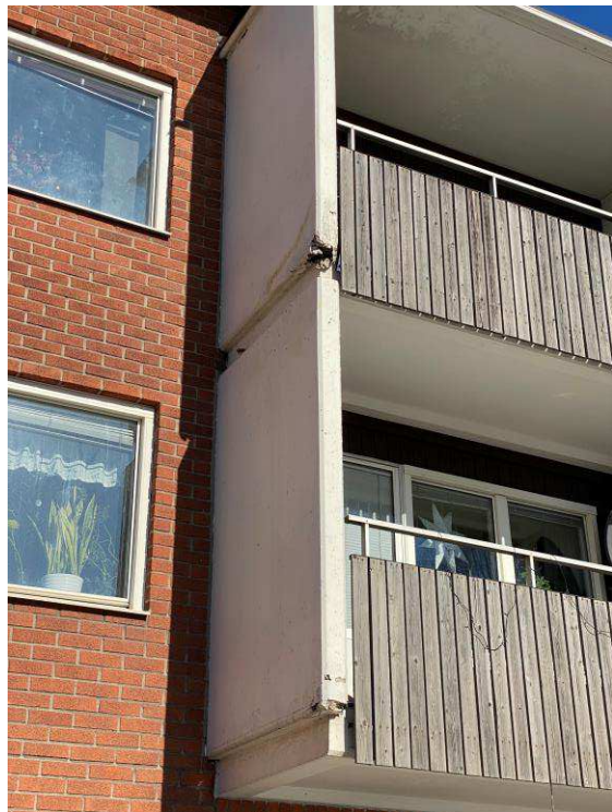
Bild på större frostsprängningar
