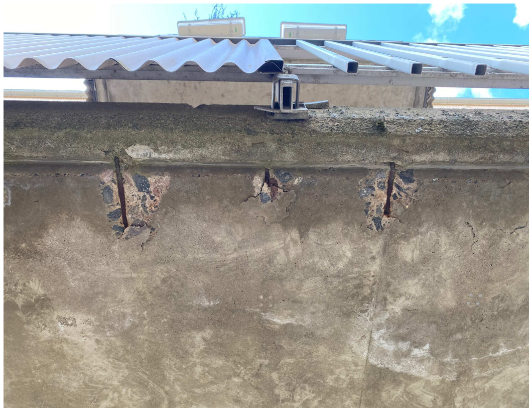
Bild på större frostsprängningar
