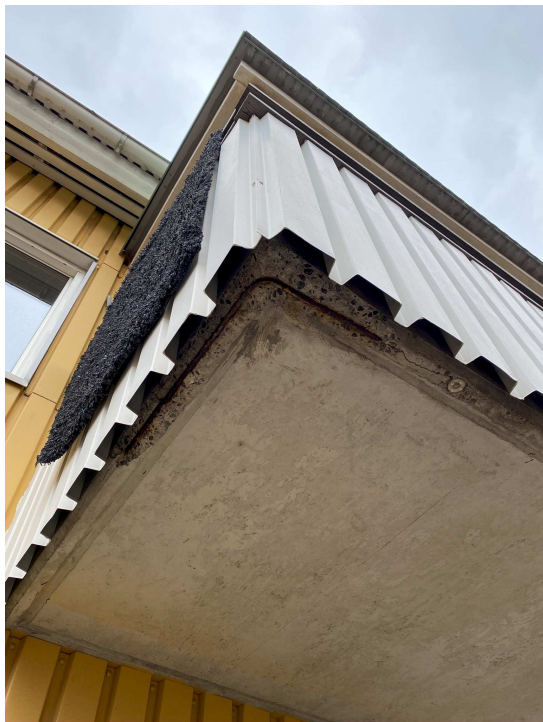
Bild på större frostsprängningar
