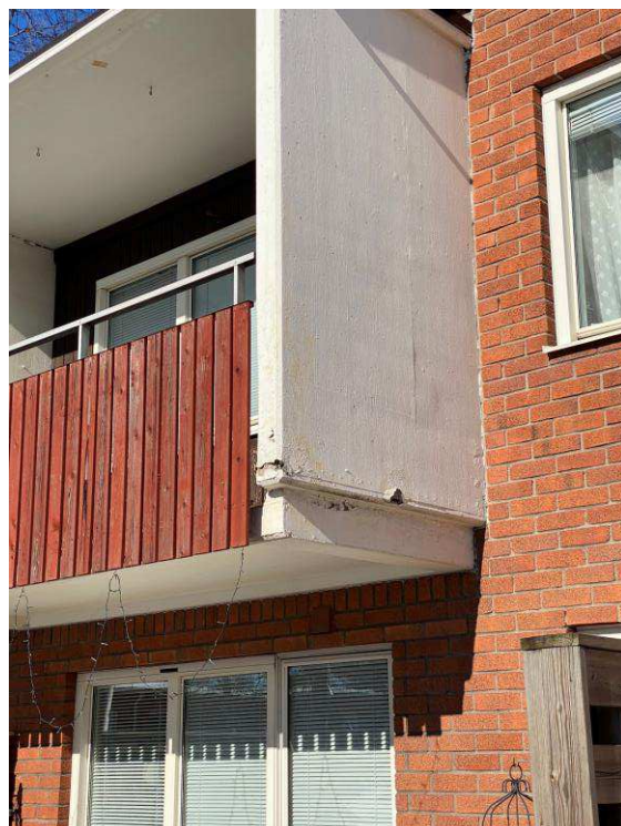
Bild på mindre frostsprängningar
