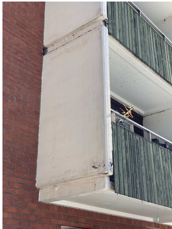
Bild på mindre frostsprängningar
