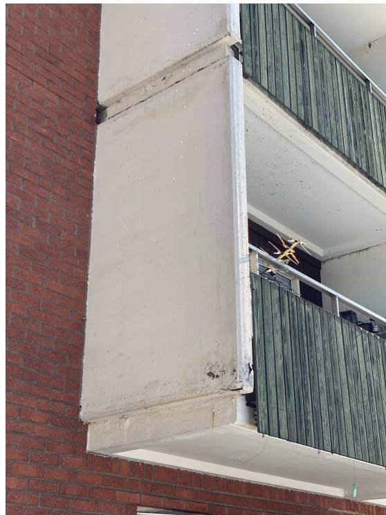
Bild på mindre frostsprängningar
