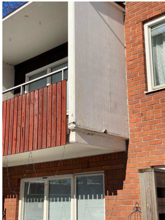
Bild på mindre frostsprängningar
