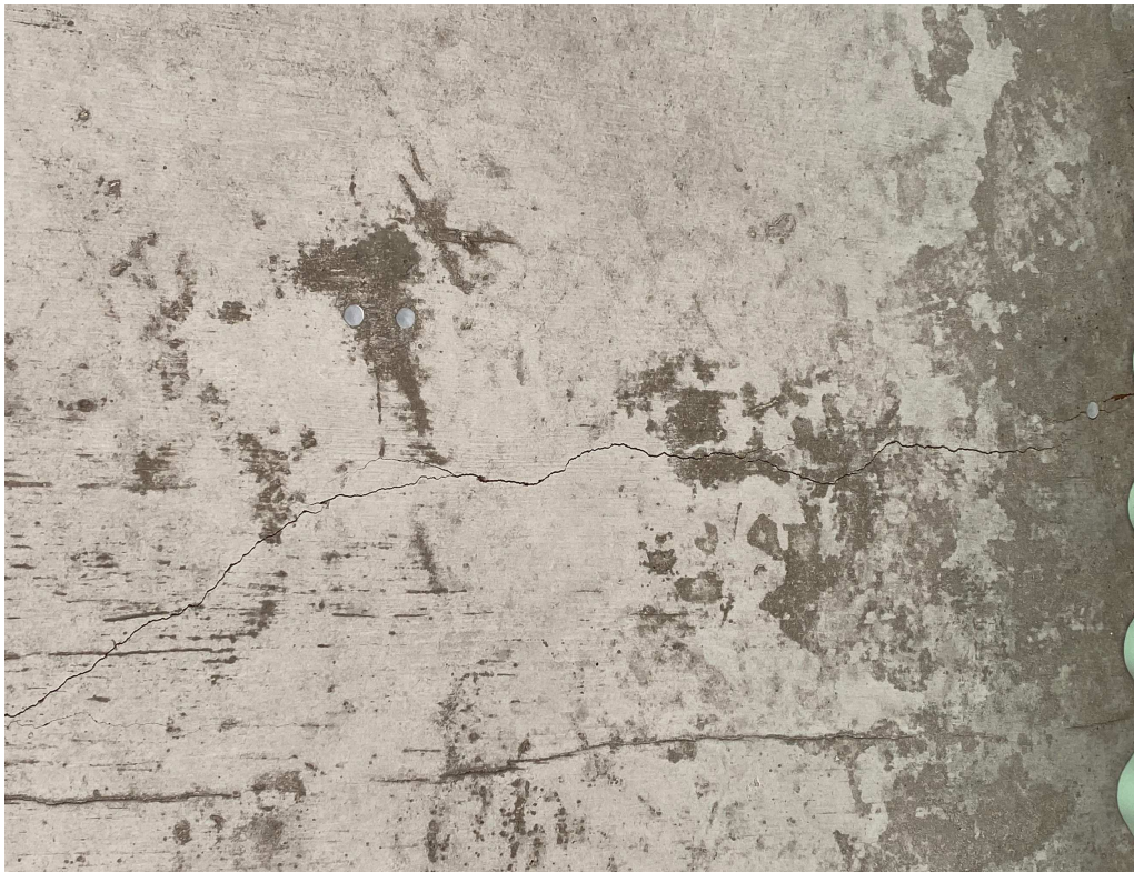
Bild på synlig spricka i balkongplatta
