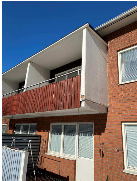
Bild på större frostsprängningar
