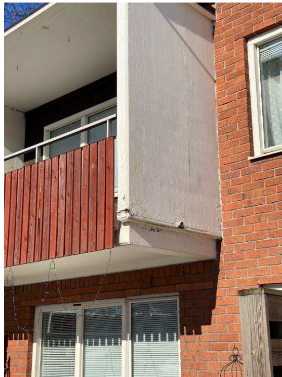
Bild på mindre frostsprängningar
