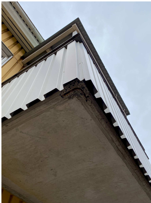
Bild på mindre frostsprängningar
