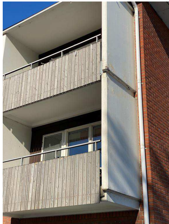
Bild på mindre frostsprängningar
