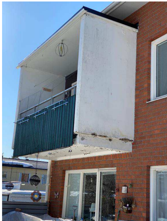
Bild på större frostsprängningar
