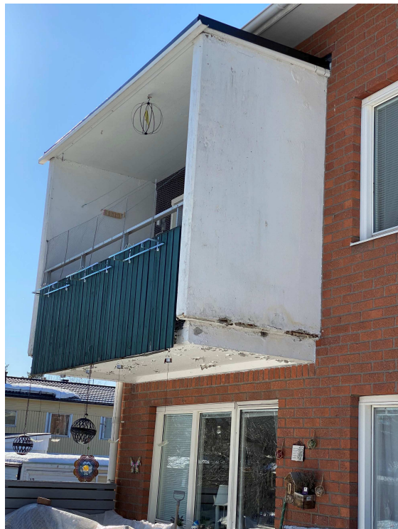
Bild på större frostsprängningar
