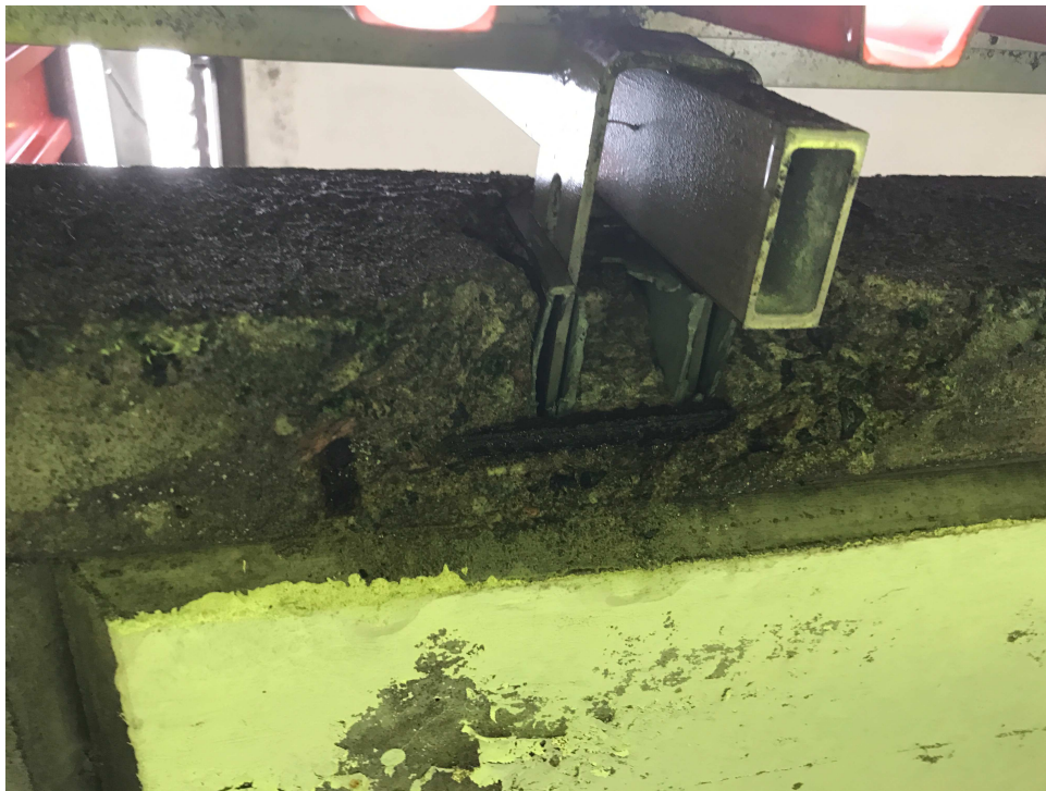
Bild 7: Frostsprängning underkant samt runt infästning balkongräcke (nedre LGH 14A)
