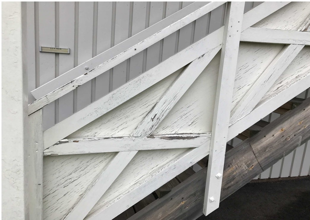
Bild 63: Fuktskadade räcken upp till plan 2
