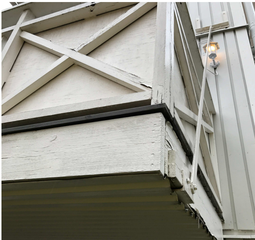
Bild 44: Fuktskadat räcke och sprickbildning i balkar
