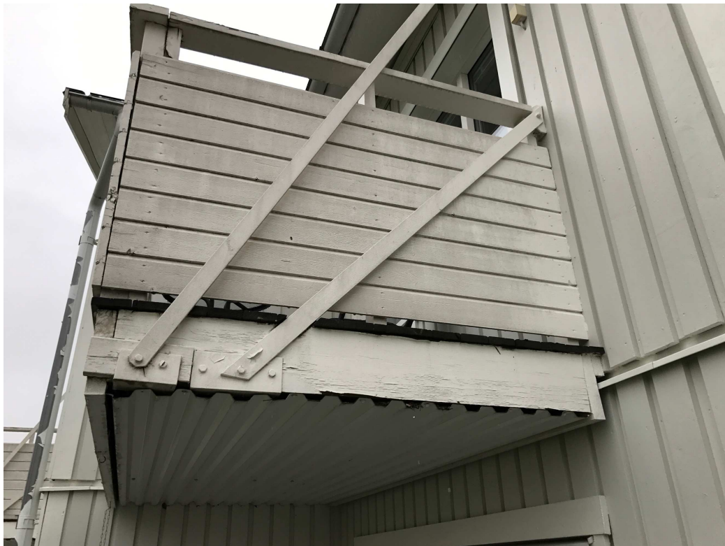
Bild 74: Fuktskadade och sprickbildning i balkar vid främre infästning
