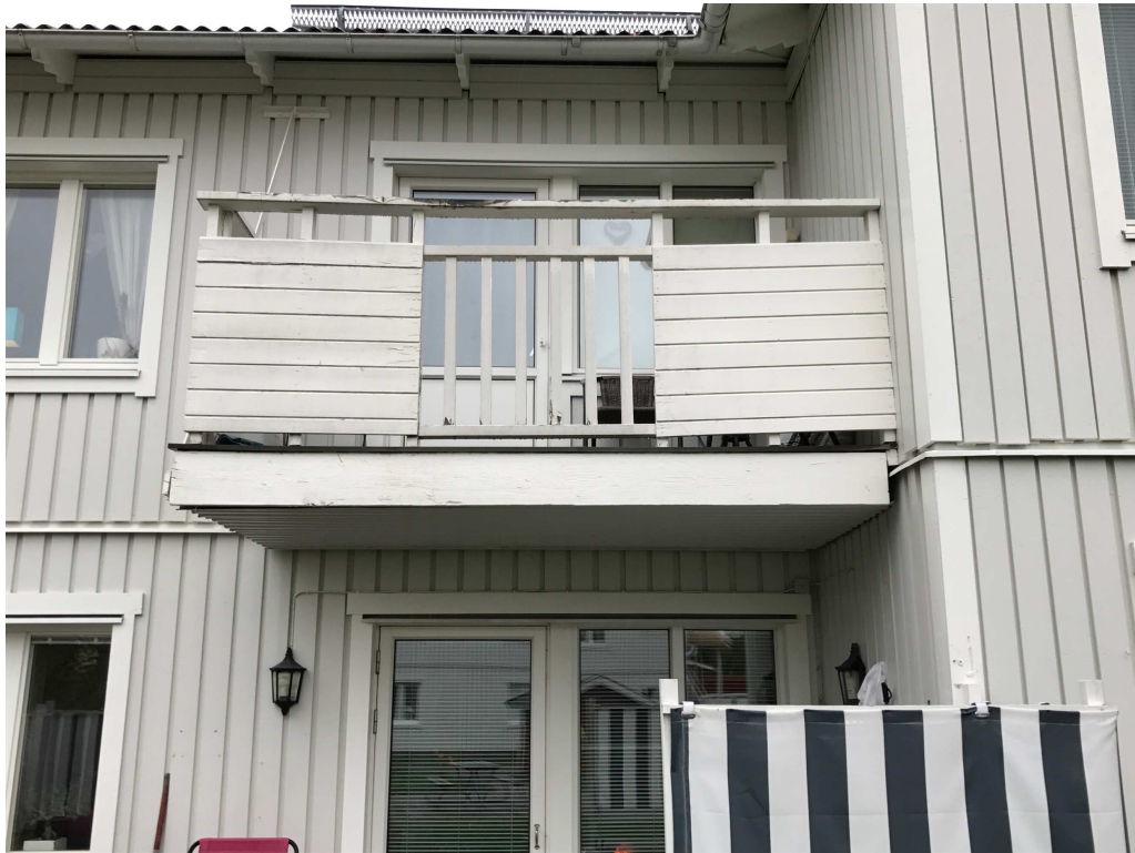
Bild 79: Fuktskadade räcken och sprickbildning i balkar vid främre infästning
