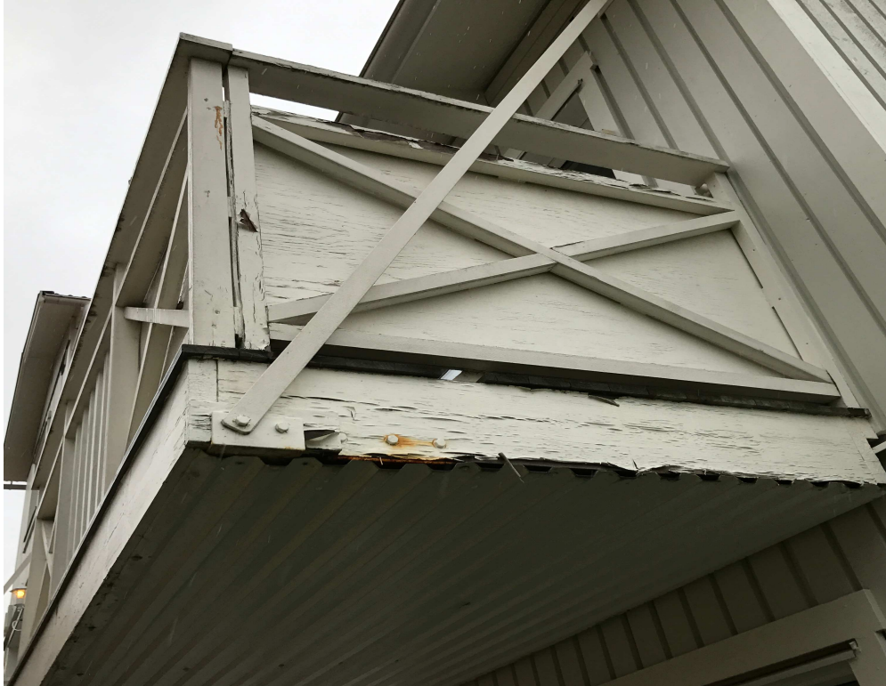
Bild 47: Fuktskadat räcke och sprickbildning i balkar
