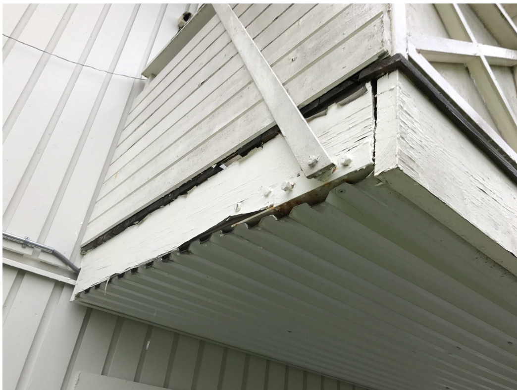
Bild 51: Fuktskadat räcke och sprickbildning i balkar
