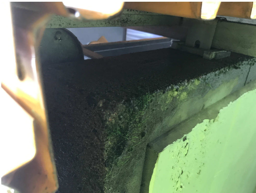
Bild 3: Frostsprängning i underkant betongplatta (nedre LGH 14A)
