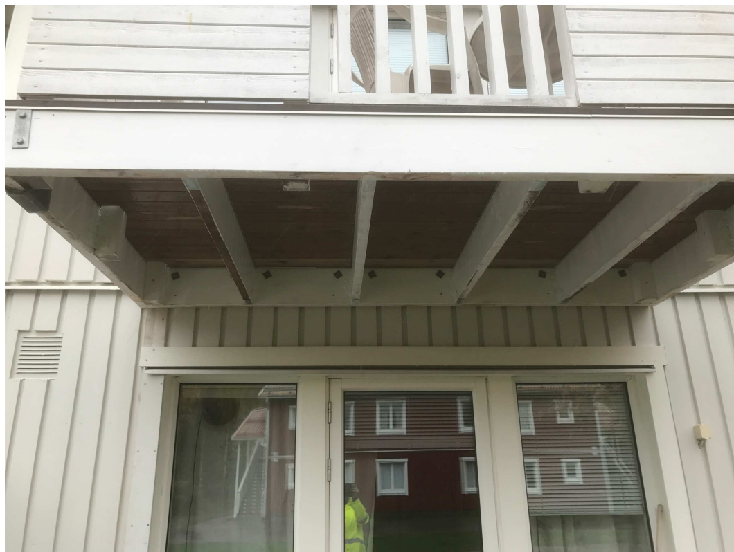
Bild 16: Plåttäckning undersida på en balkong saknas
