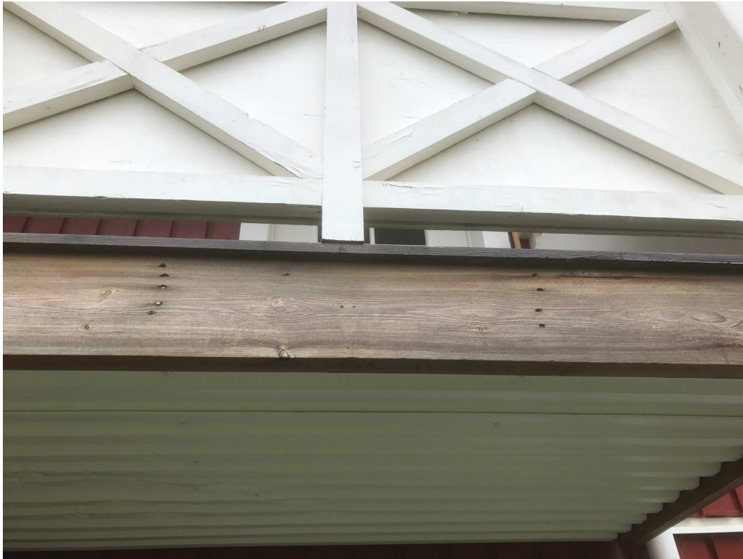
Bild 22: Fuktigt virke i räcke och balkar
