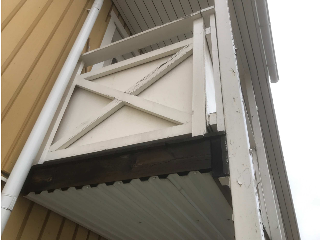
Bild 40: Fuktskadat räcke på trappa upp till plan 2
