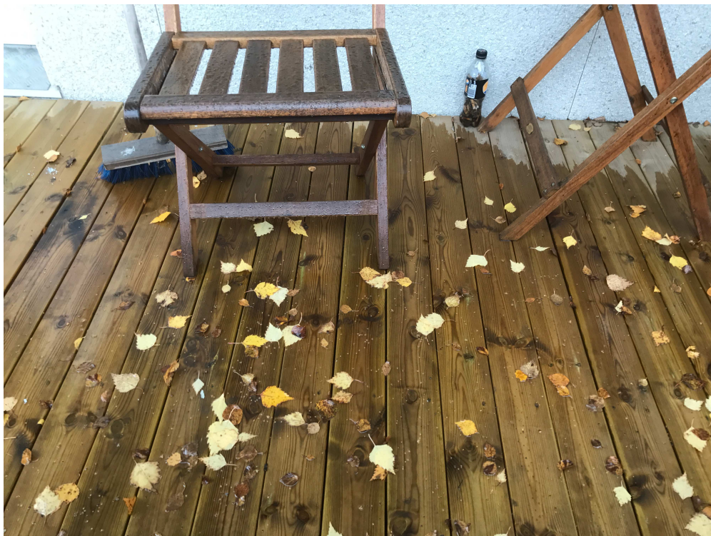
Bild 4: Balkongplatta klädd med trallvirke för att dölja sprickor i plattan
