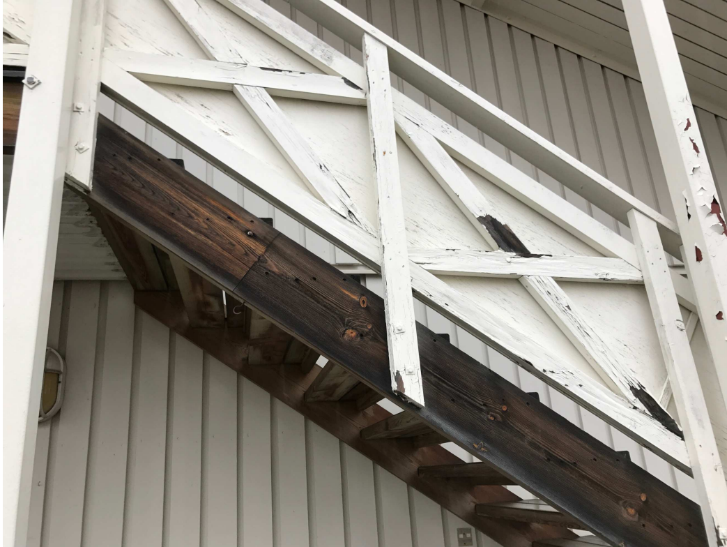
Bild 72: Fuktskadade räcken upp till plan 2
