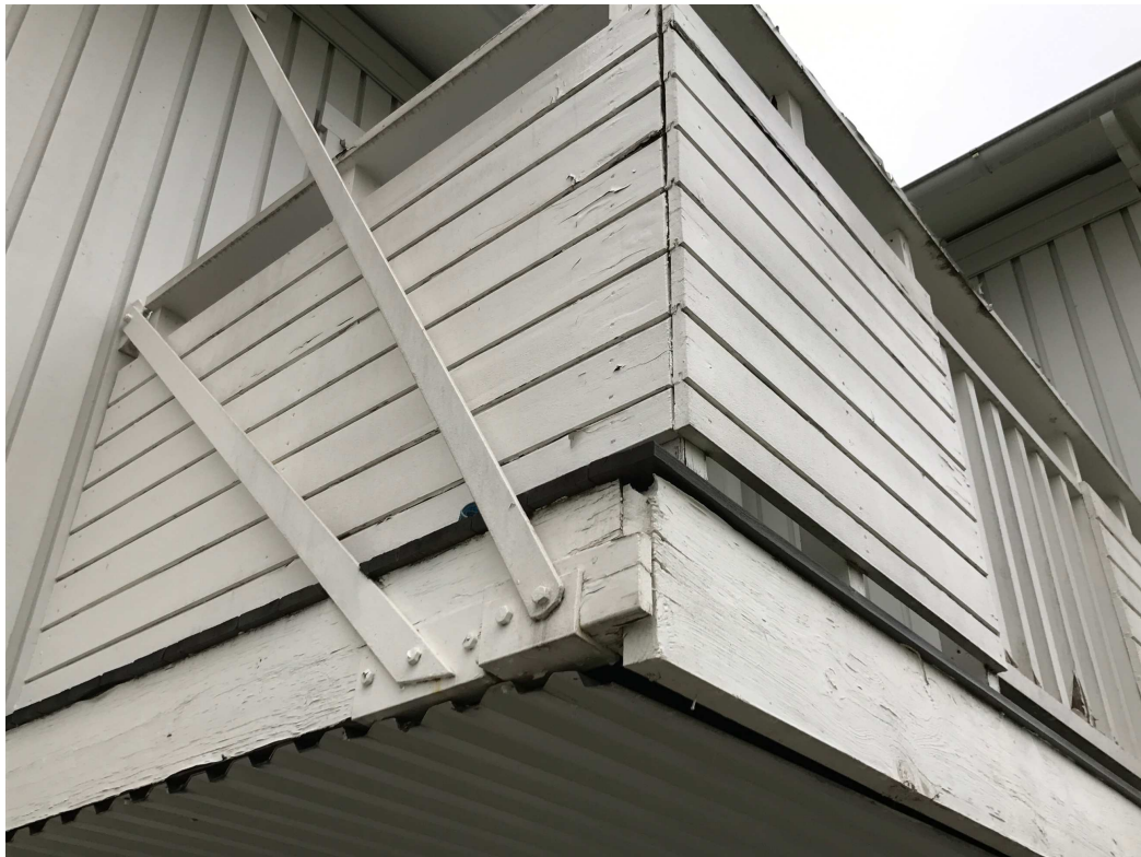
Bild 80: Fuktskadade räcken och sprickbildning i balkar vid främre infästning
