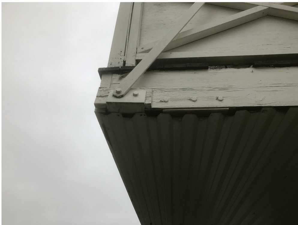
Bild 7: Glipor vid främre infästningen av dragstaget, synligt fuktskadade bjälkar
