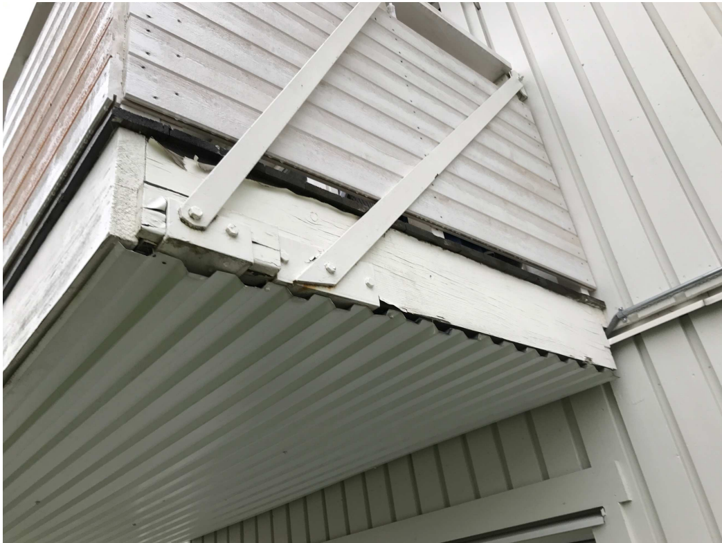
Bild 66: Fuktskadade och sprickbildning i balkar vid främre infästning
