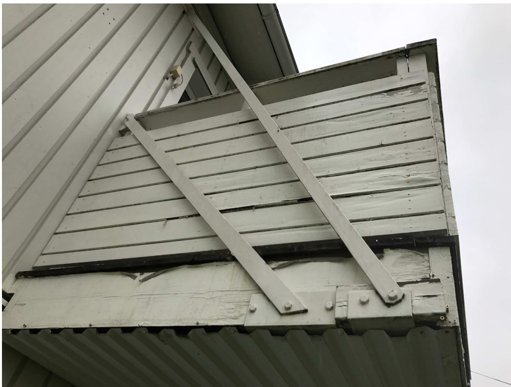
Bild 67: Fuktskadade räcken och sprickbildning i balkar vid främre infästning
