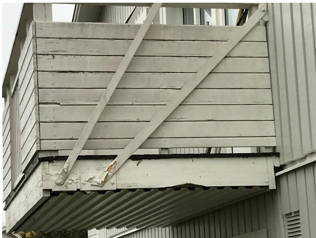
Bild 76: Fuktskadade och sprickbildning i balkar vid främre infästning
