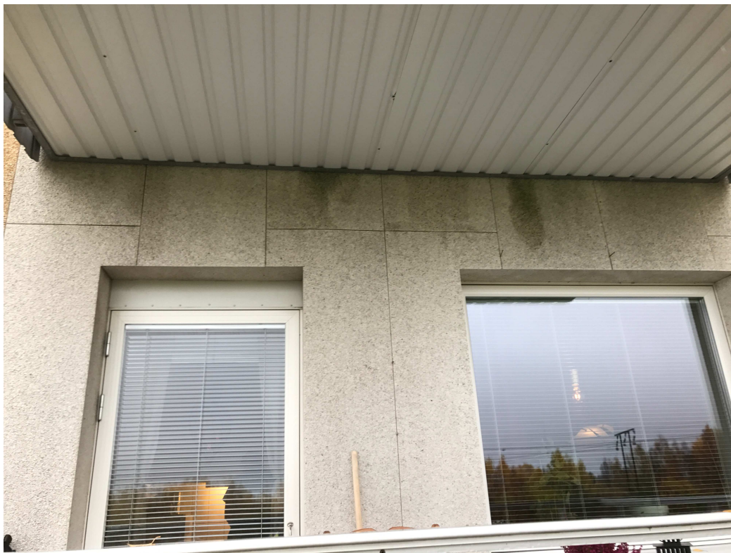
Bild 5: Synliga spår av att vatten rinner bakom balkongplatta och efter fasad.
