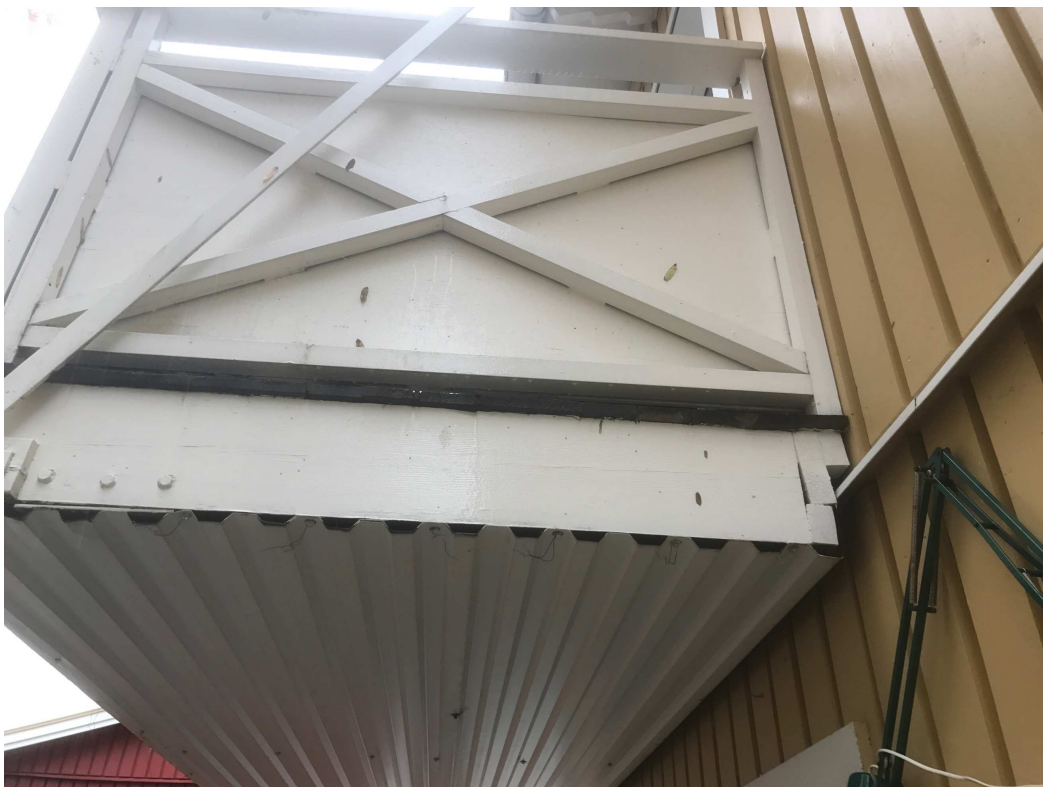
Bild 35: Fuktigt på räcken, sprickor och glipor infästningar i fram- och bakkant
