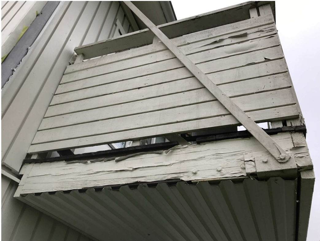
Bild 54: Fuktskadat räcke och sprickbildning i balkar
