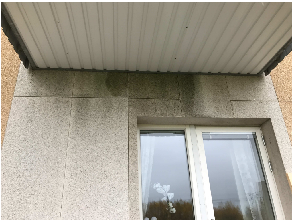
Bild 6: Synliga spår av att vatten rinner bakom balkongplatta och efter fasad.
