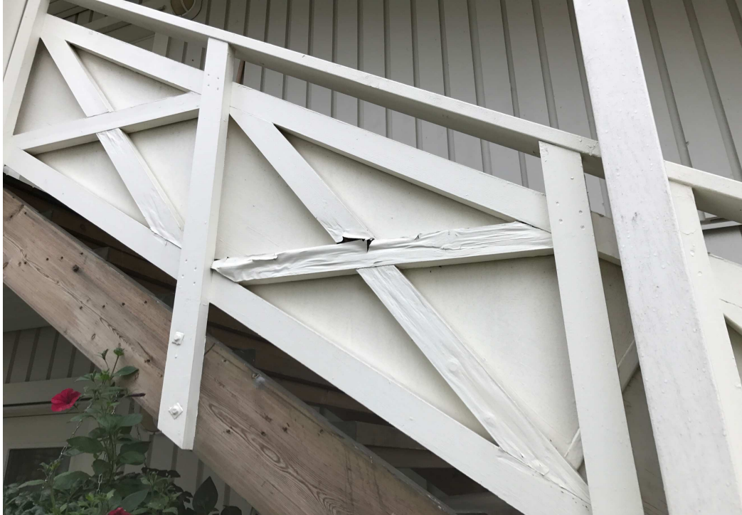
Bild 48: Fuktskadat räcke på trappa upp till plan 2
