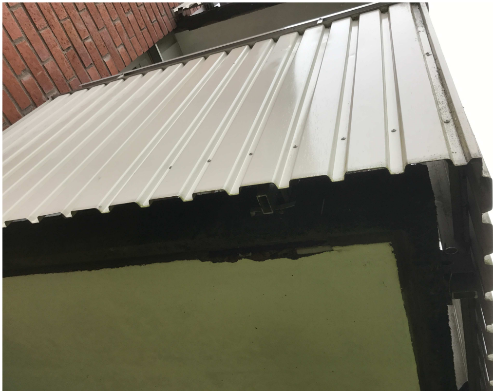
Bild 9: Frostsprängning underkant balkongplatta (undre LGH 12B)
