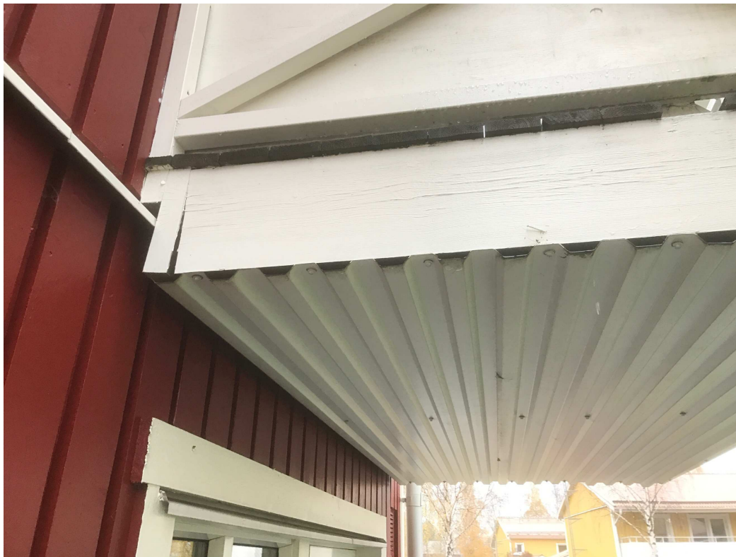
Bild 3: Infästning i fasad glipar
