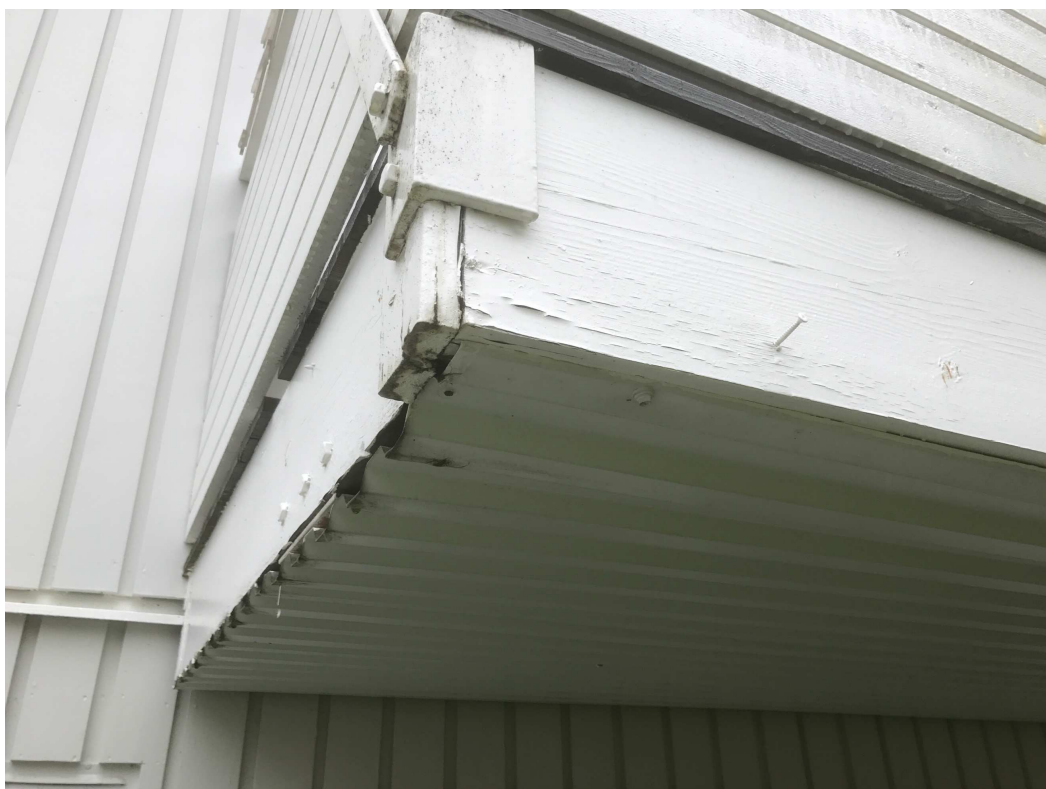
Bild 14: Sprickor vid infästning samt fuktskadade balkar
