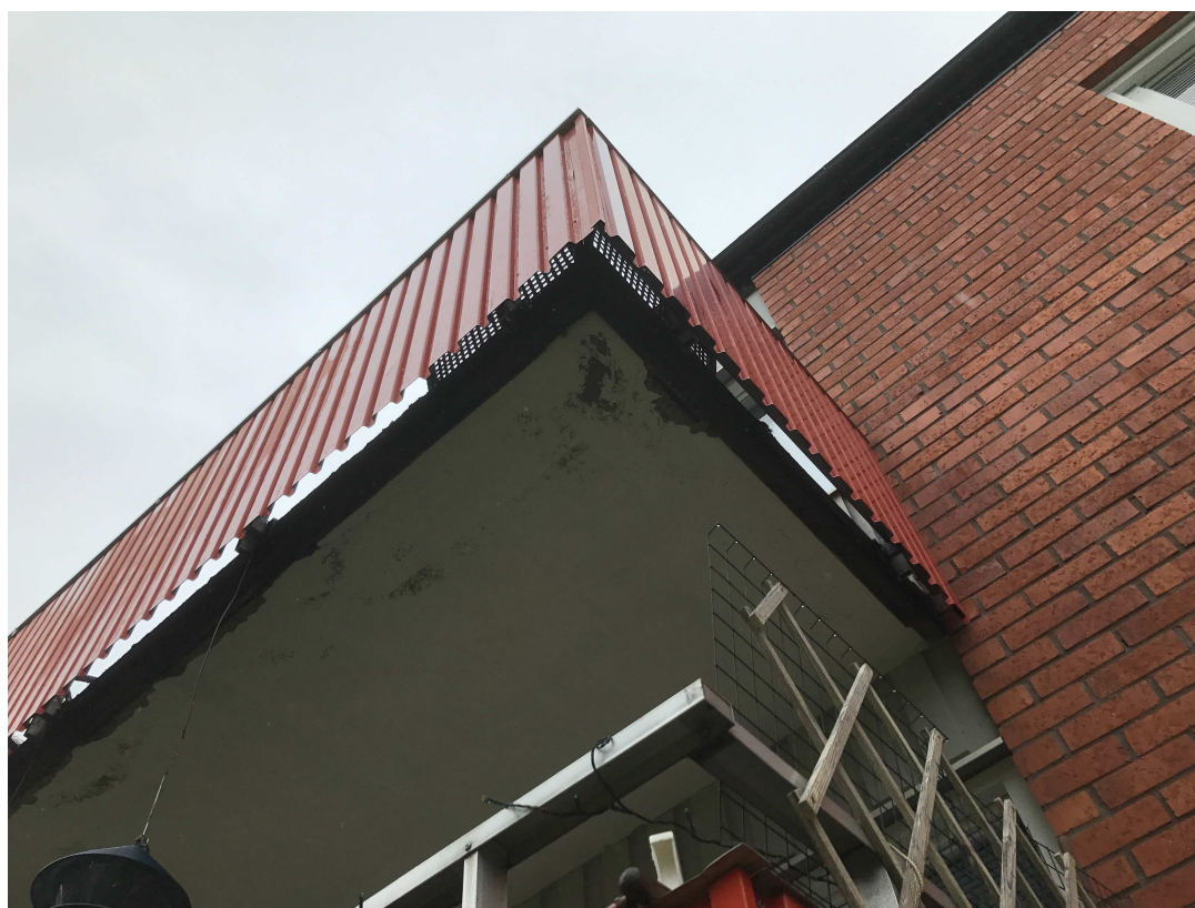
Bild 6: Frostsprängning i underkant betongplatta (LGH 14B)
