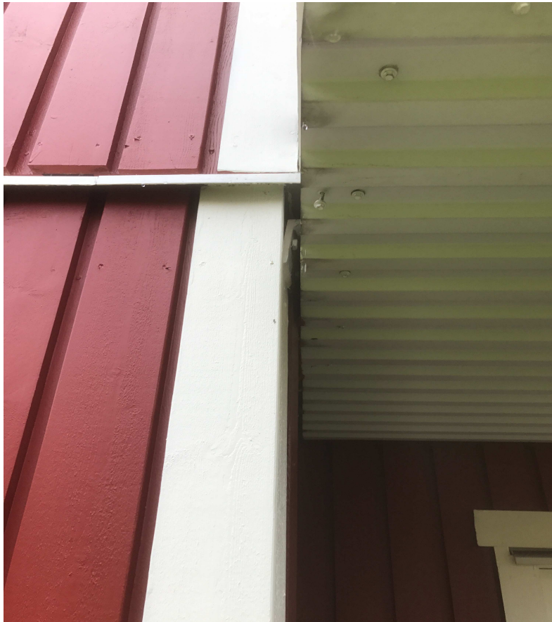
Bild 20: Infästning i fasad glipar, något lös.
