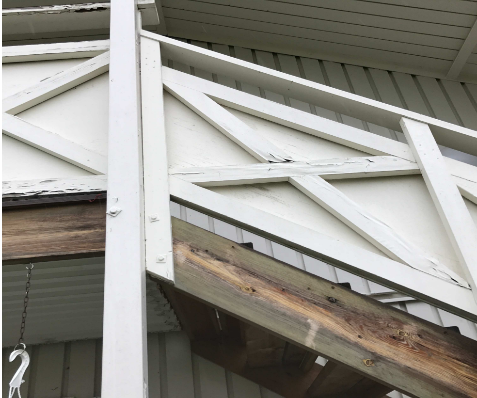
Bild 55: Fuktskadade räcken upp till plan 2
