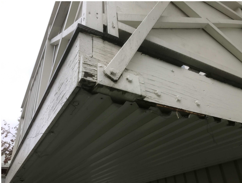
Bild 6: Glipor vid främre infästningen av dragstaget, synligt fuktskadad
