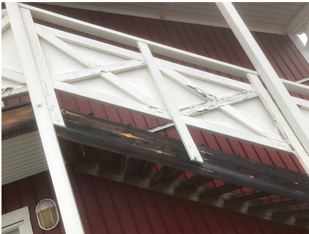
Bild 28: Fuktskadat räcke på trappa upp till plan 2
