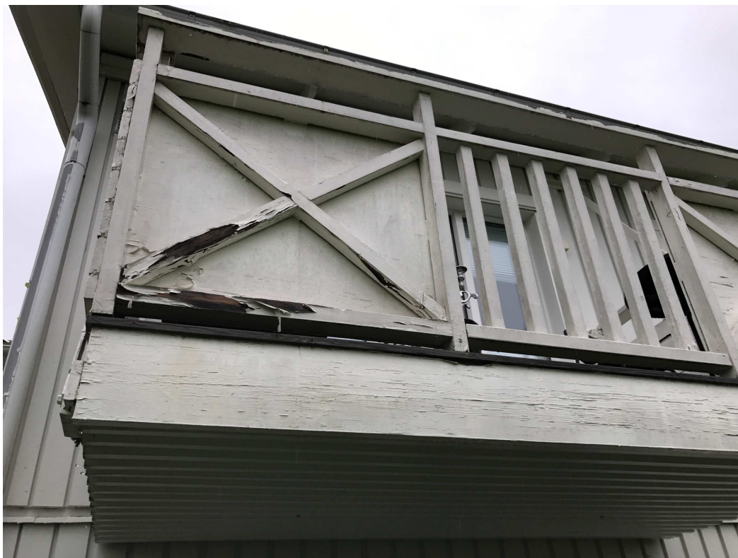
Bild 53: Fuktskadat räcke och sprickbildning i balkar
