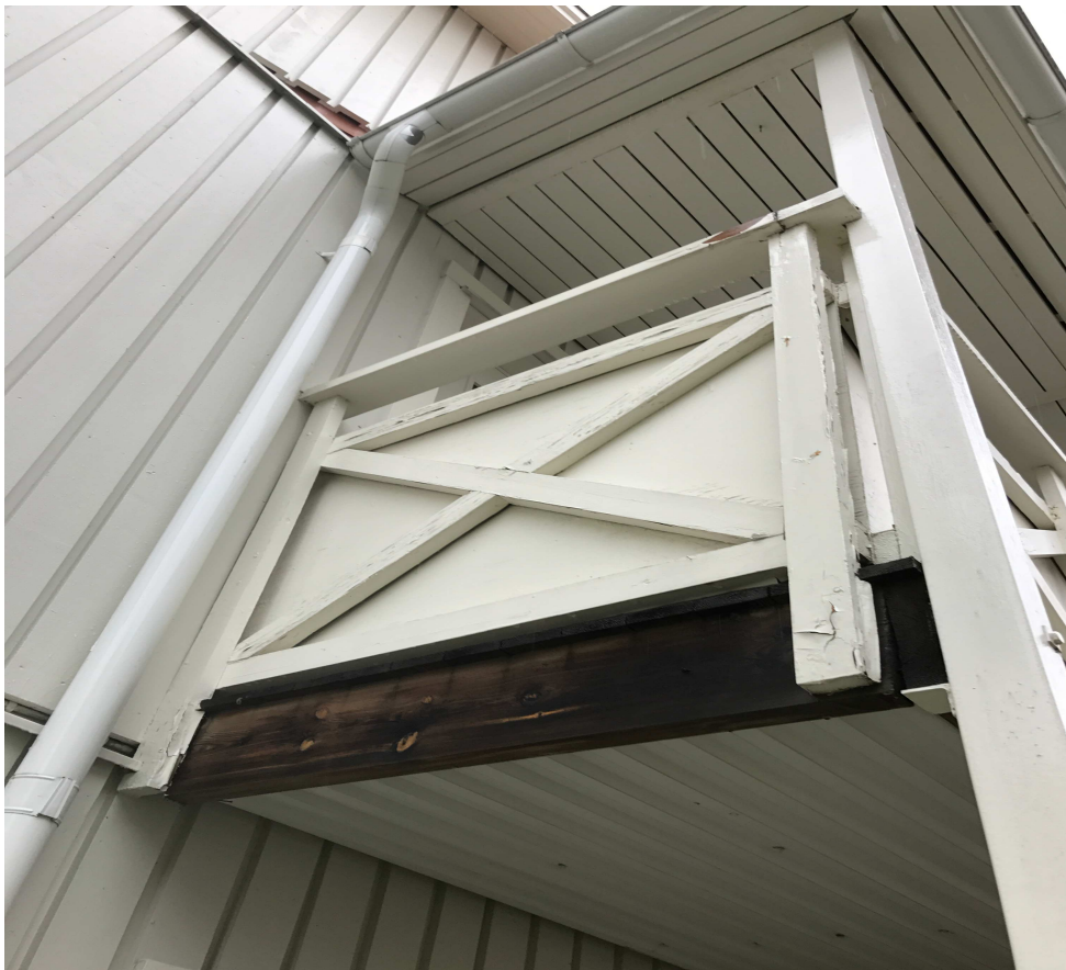
Bild 49: Fuktskadat räcke på trappa upp till plan 2
