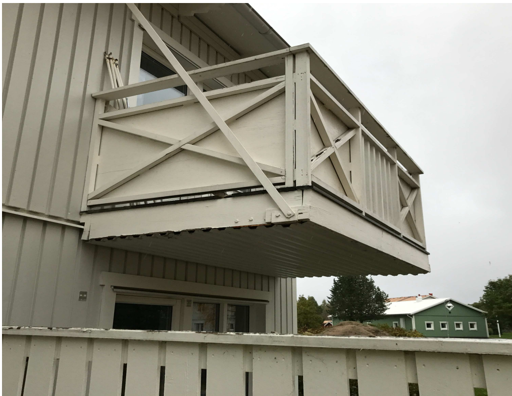
Bild 46: Fuktskadat räcke och sprickbildning i balkar i fram- och bakkant
