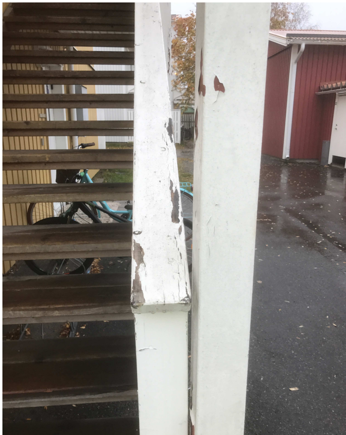
Bild 30: Fuktskadat räcke på trappa upp till plan 2
