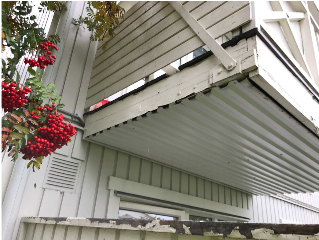
Bild 61: Fuktskadade och sprickbildning i balkar vid främre infästning
