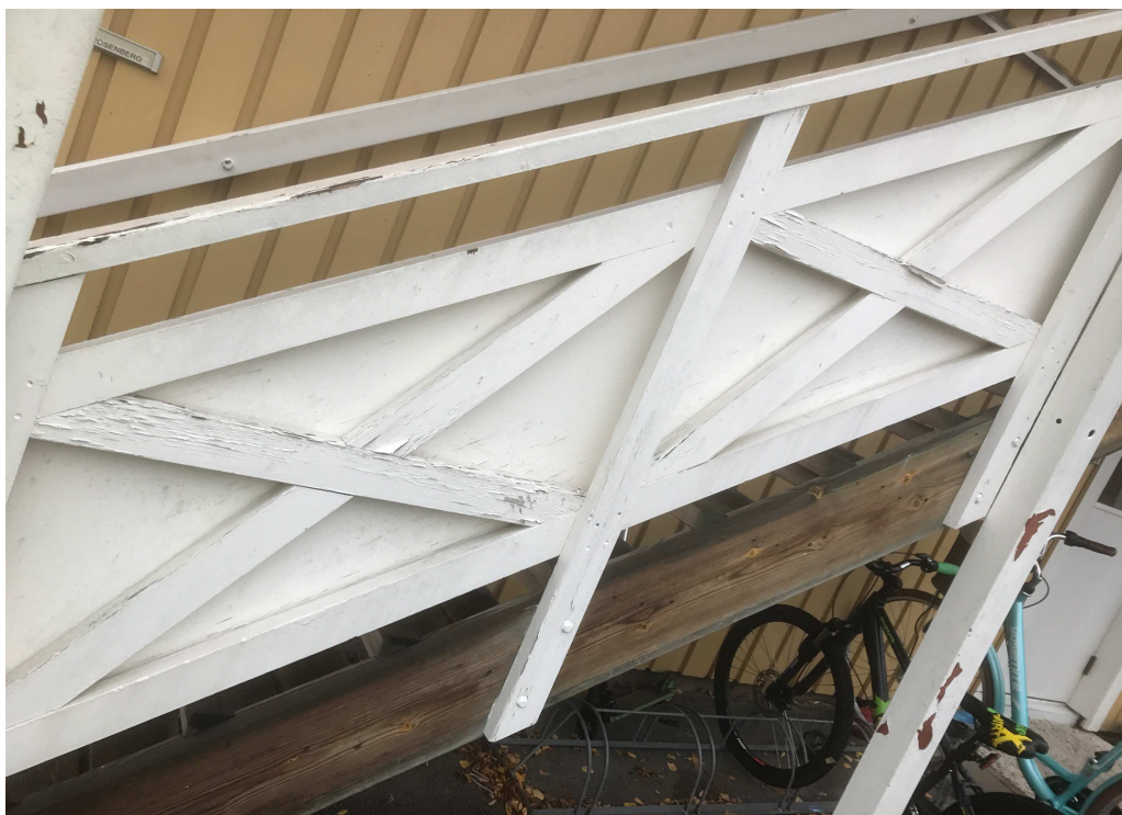
Bild 31: Fuktskadat räcke på trappa upp till plan 2
