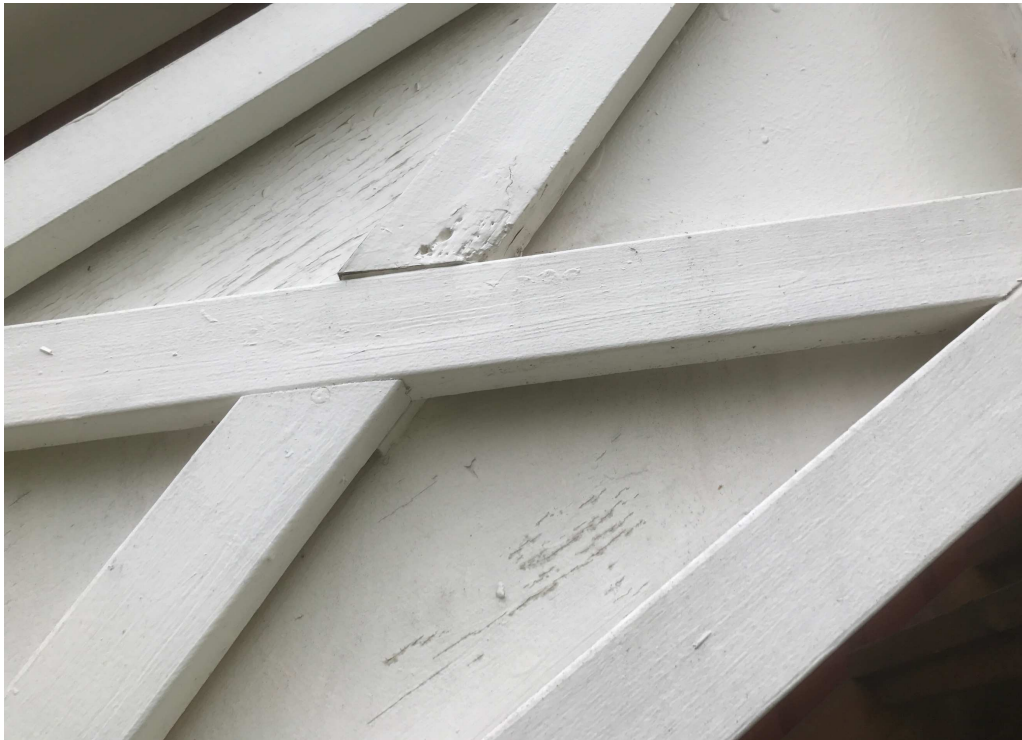
Bild 21: Fuktskadade räcken på trappor upp till plan 2
