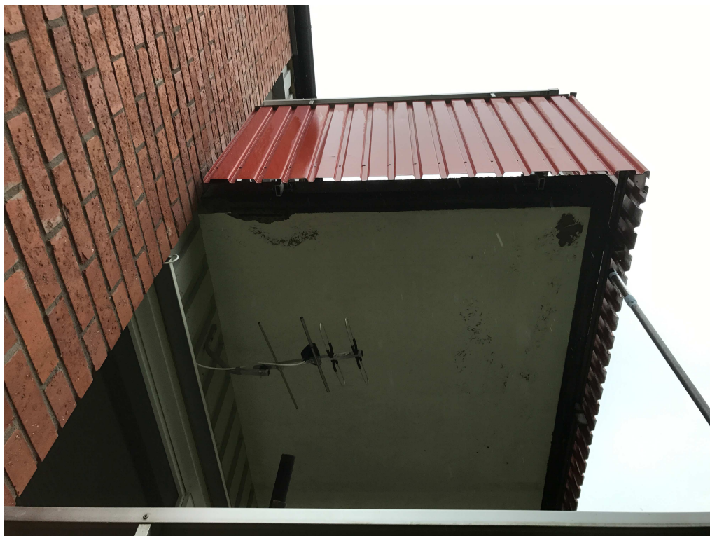
Bild 4: Frostsprängning i underkant betongplatta (LGH 14B)
