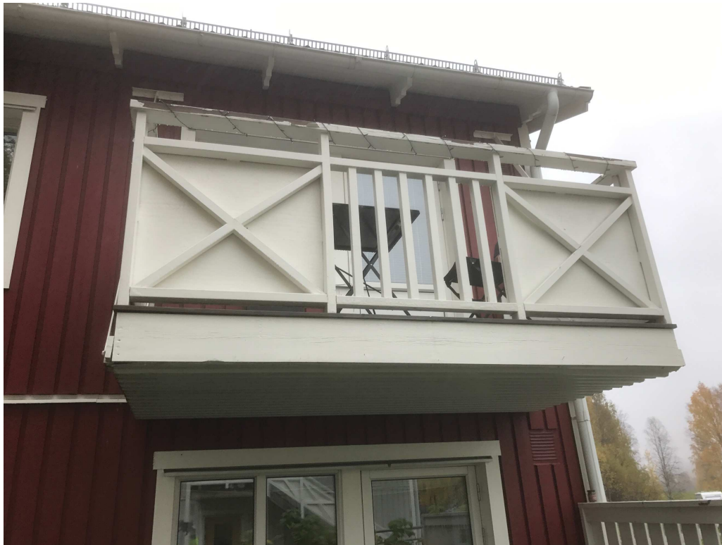
Bild 2: Fuktskadade stolpar och överliggare till balkongräcken
