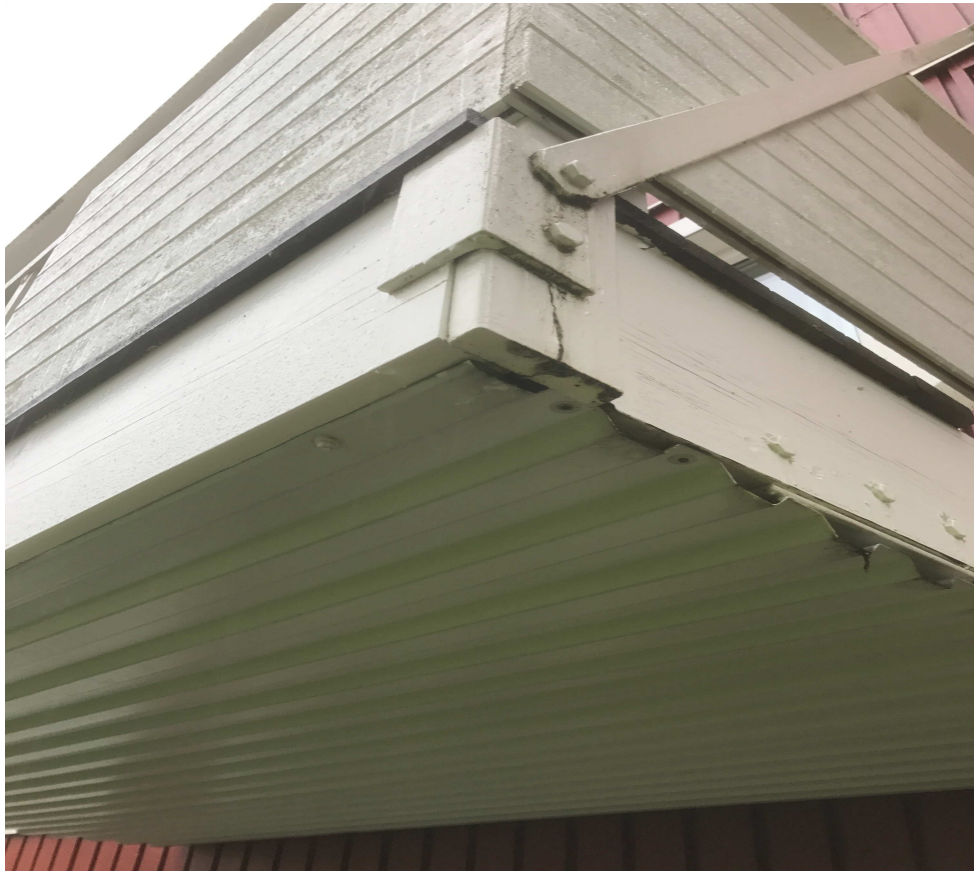
Bild 11: Sprickor i virket vid främre infästningen
