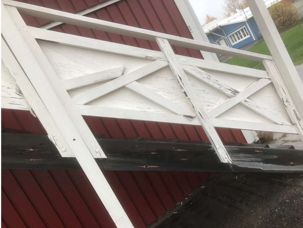
Bild 29: Fuktskadat räcke på trappa upp till plan 2
