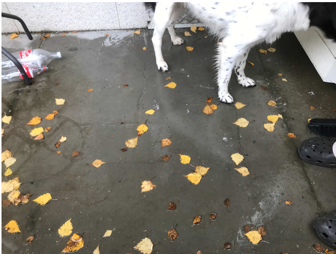
Bild 2: Flertalet större sprickor i balkongplatta (lgh i 40B)
