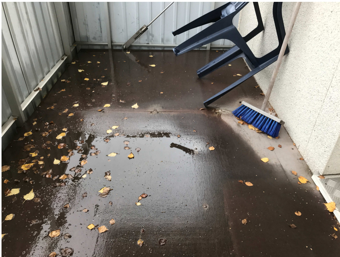
Bild 3: Balkongplatta klädd med formplywood för att dölja sprickor i plattan
