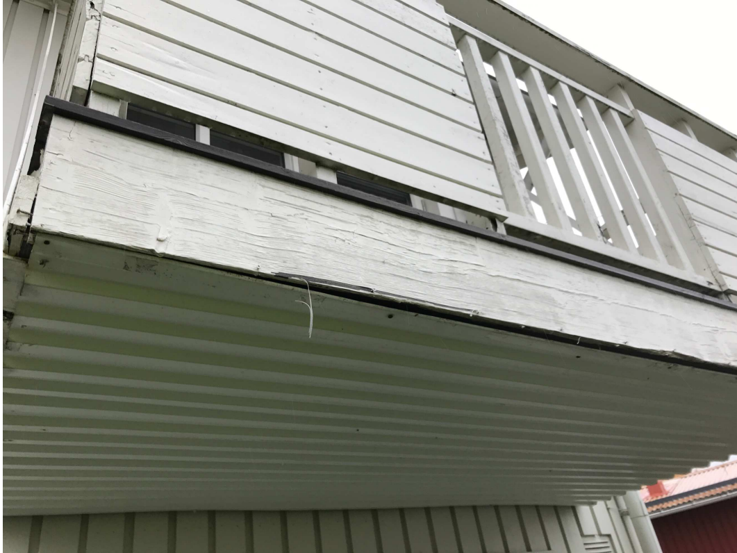
Bild 68: Fuktskadade och sprickbildning i balkar vid främre infästning
