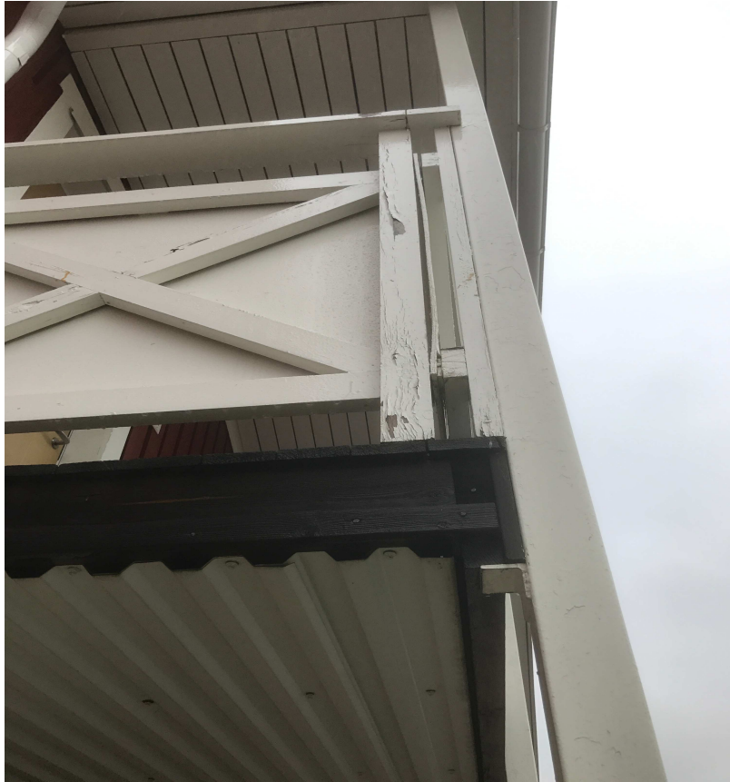
Bild 1: Fuktskadade stolpar och överliggare till balkongräcken
