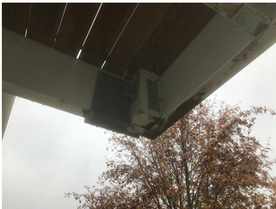
Bild 17: Fuktskadade balkar vid infästningen
