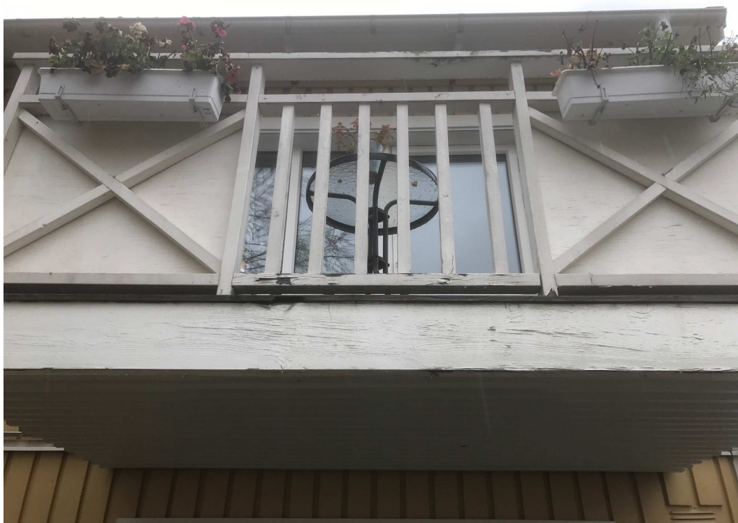
Bild 37: Fuktskadade spjälor i räcke, sprickbildning i balk.
