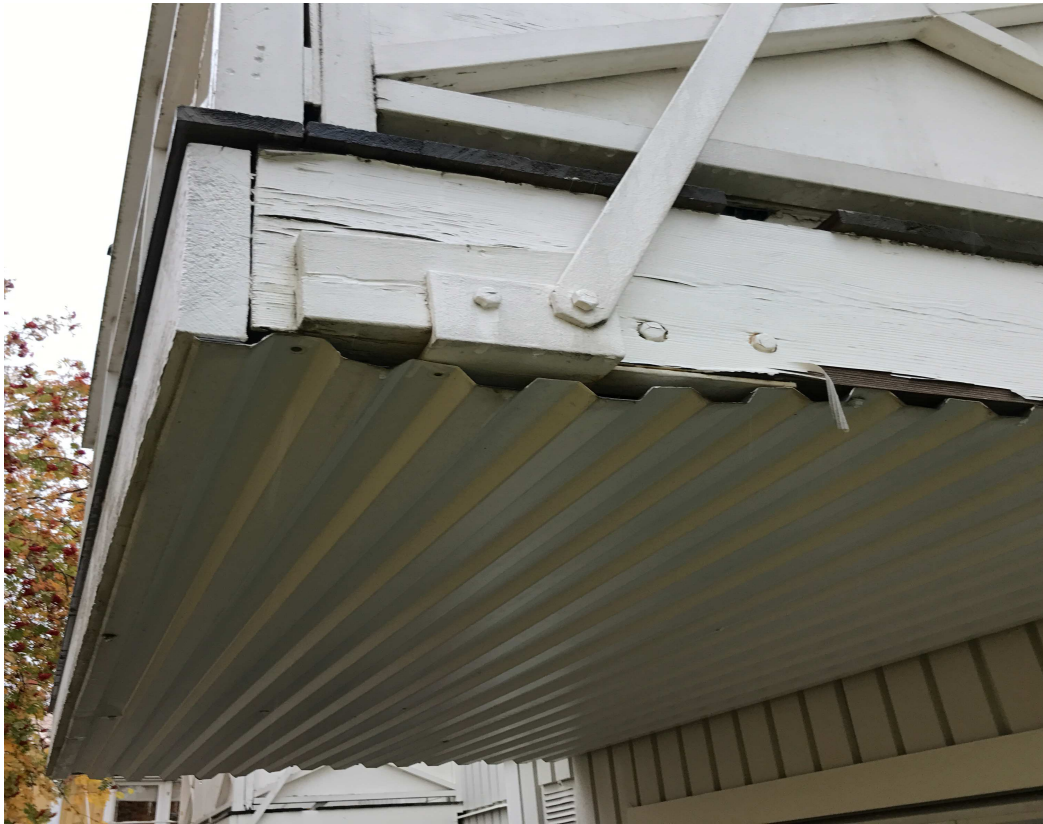
Bild 45: Fuktskadat räcke och sprickbildning i balkar
