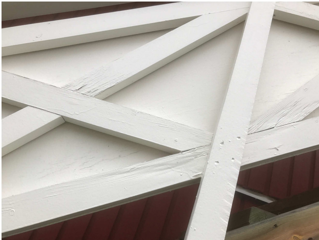
Bild 4: Fuktskadade räcken på trappor upp till plan 2.
