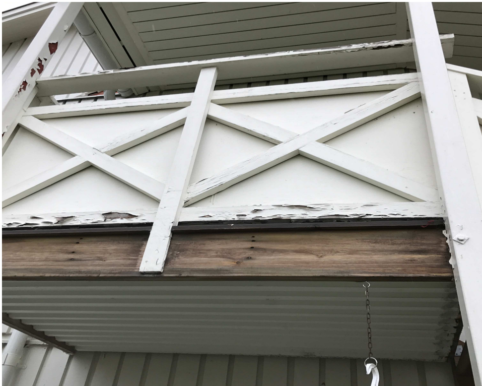
Bild 56: Fuktskadade räcken upp till plan 2
