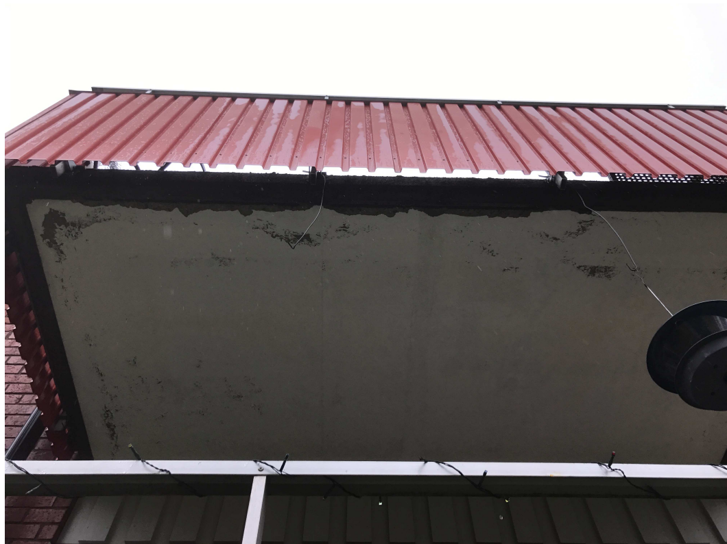
Bild 5: Frostsprängning i underkant betongplatta (LGH 14B)
