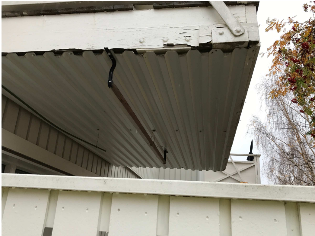
Bild 41: Sprickbildning och fuktskadade balkar
