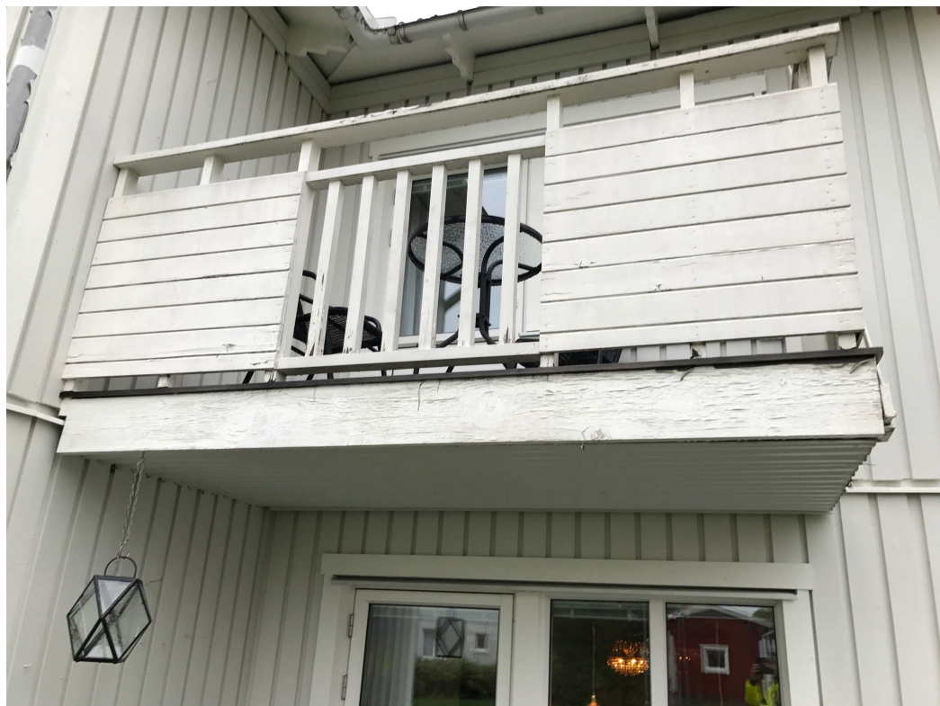
Bild 75: Fuktskadade och sprickbildning i balkar vid främre infästning
