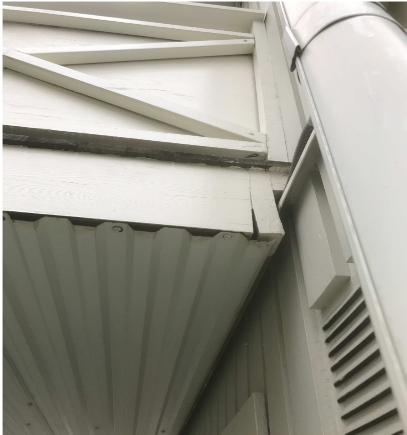
Bild 8: Infästning i fasad glipar
