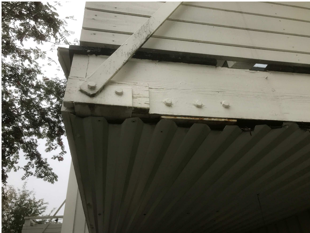
Bild 12: Sprickor vid infästning samt fuktskadade balkar
