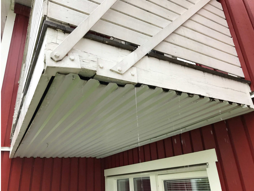
Bild 81: Fuktskadade balkar och sprickbildning i balkar vid främre infästning
