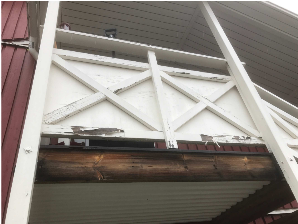
Bild 27: Fuktskadat räcke på trappa upp till plan 2
