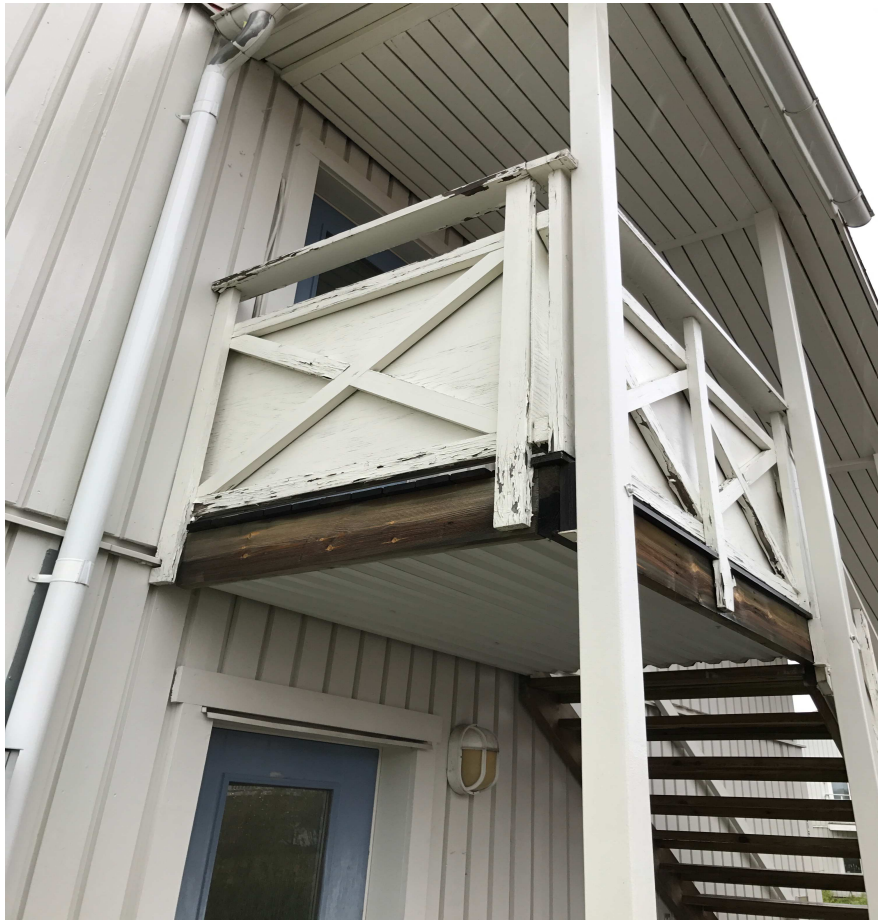
Bild 70: Fuktskadade räcken upp till plan 2
