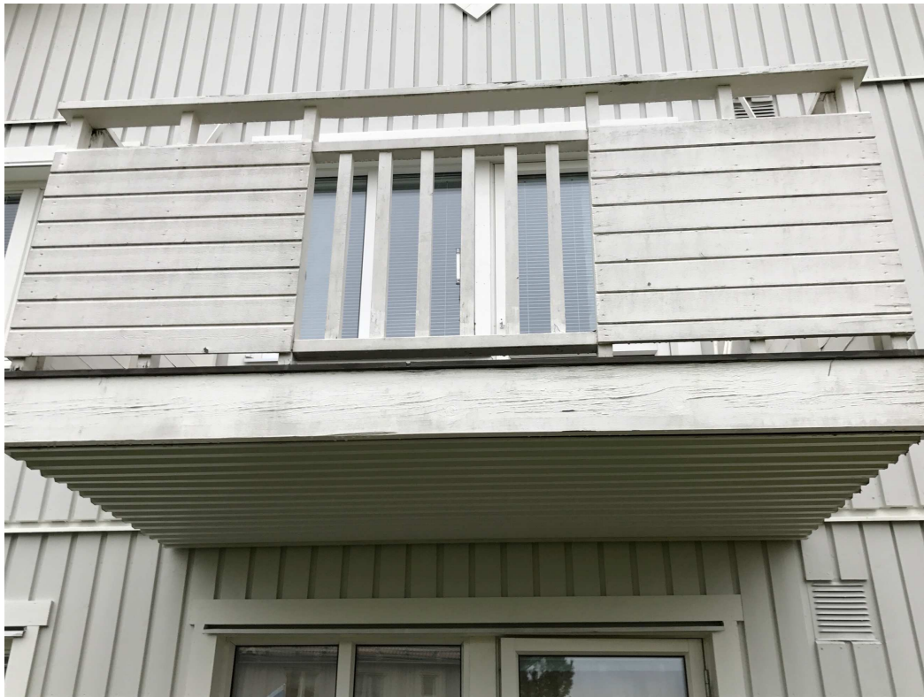
Bild 77: Fuktskadade och sprickbildning i främre balk
