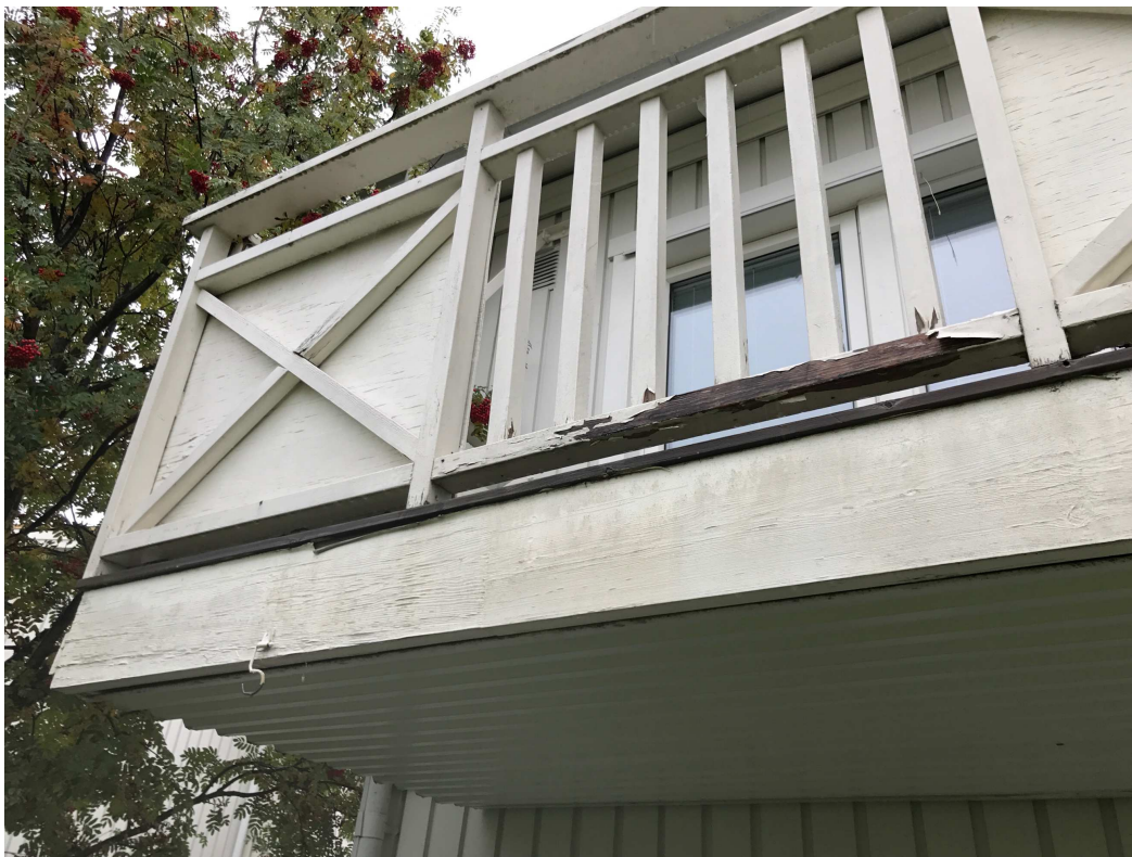
Bild 60: Fuktskadade räcken och lite sprickbildning i balk
