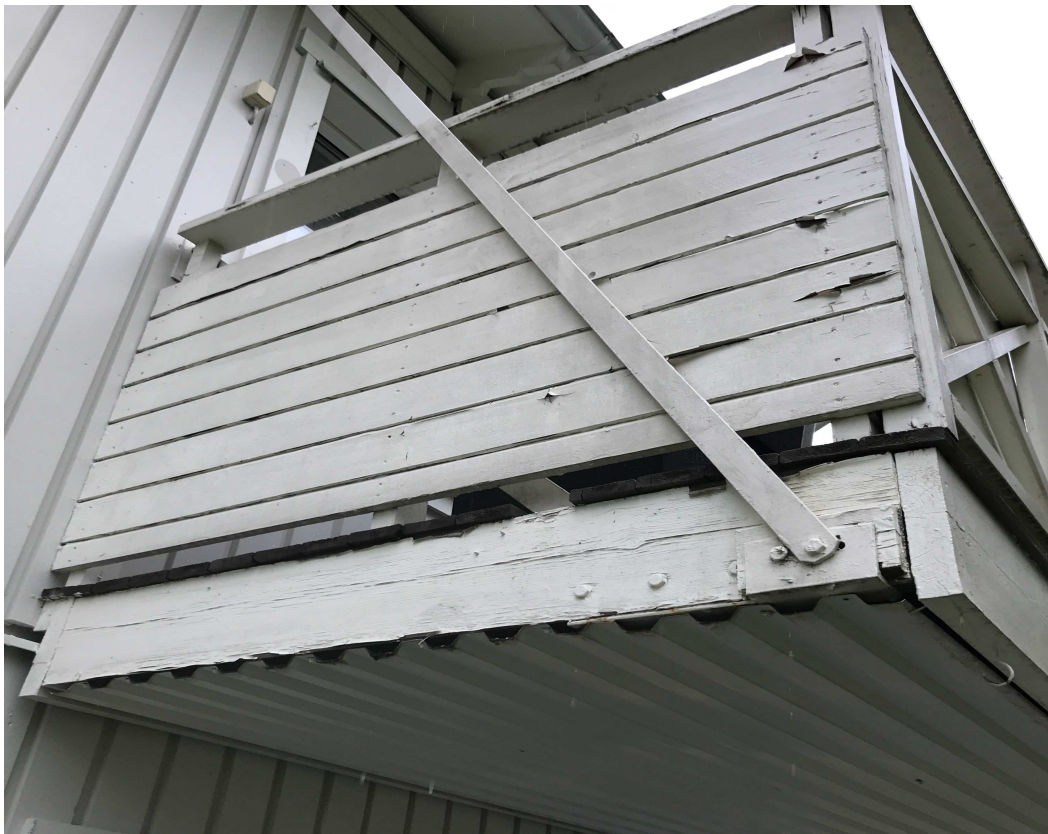
Bild 58: Fuktiskadat räcke och sprickbildning i balkar i fram- och bakkant
