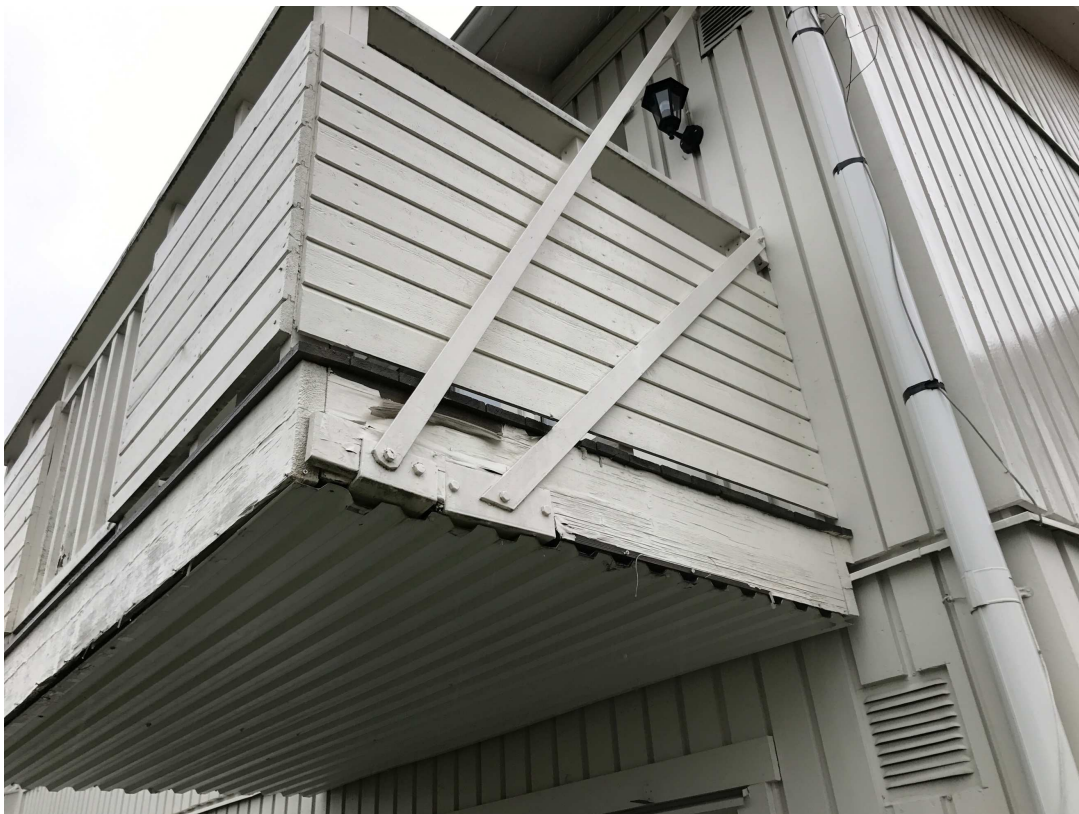
Bild 69: Fuktskadade och sprickbildning i balkar vid främre infästning
