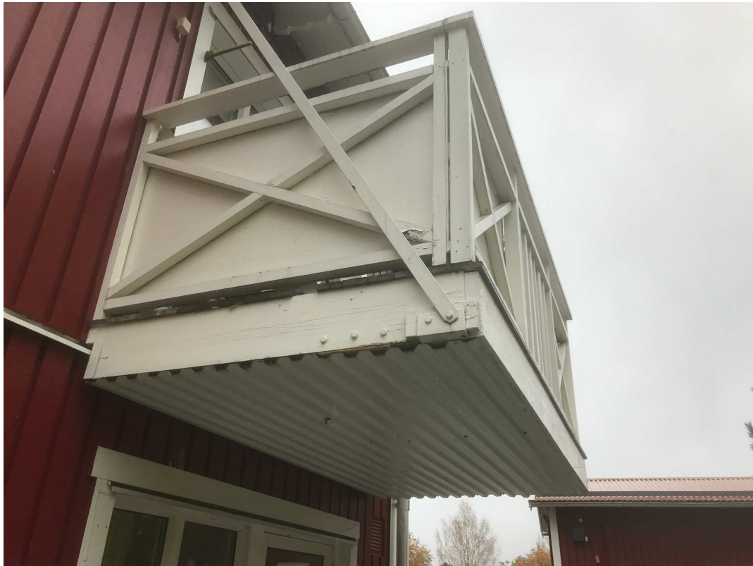
Bild 25: Fuktigt på räcken, sprickor och glipor infästningar i fram- och bakkant
