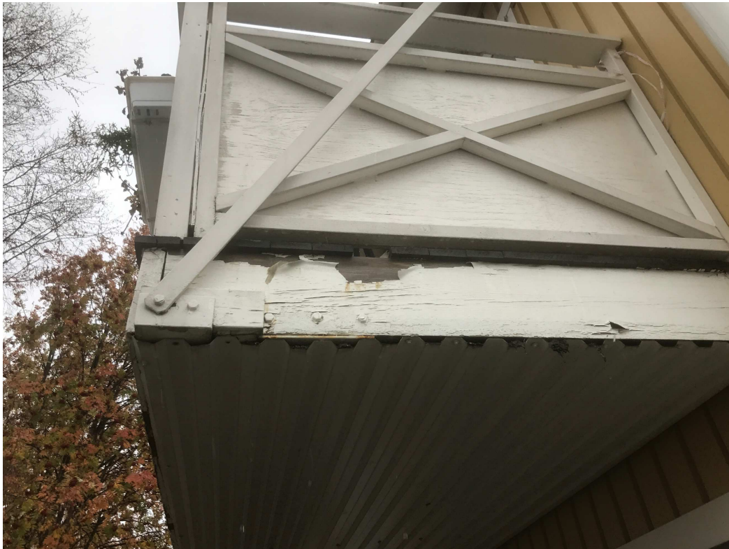
Bild 38: Fuktigt på räcken, sprickor och glipor infästningar i fram- och bakkant
