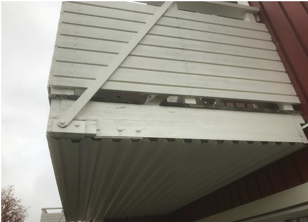
Bild 19: Sprickor vid infästning samt fuktskadade balkar
