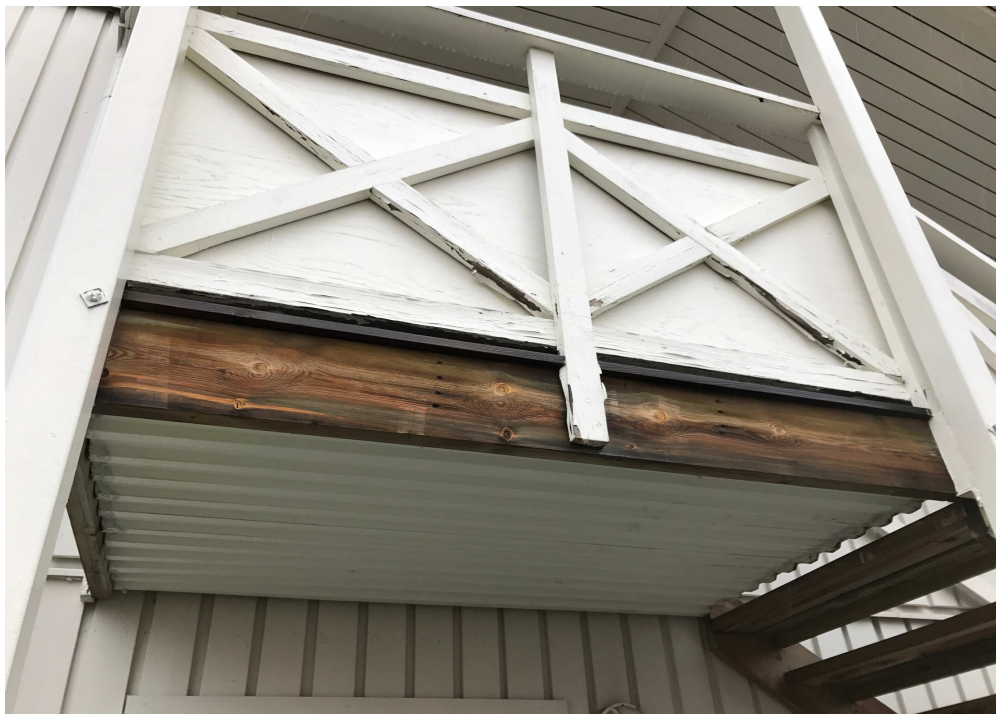
Bild 71: Fuktskadade räcken upp till plan 2
