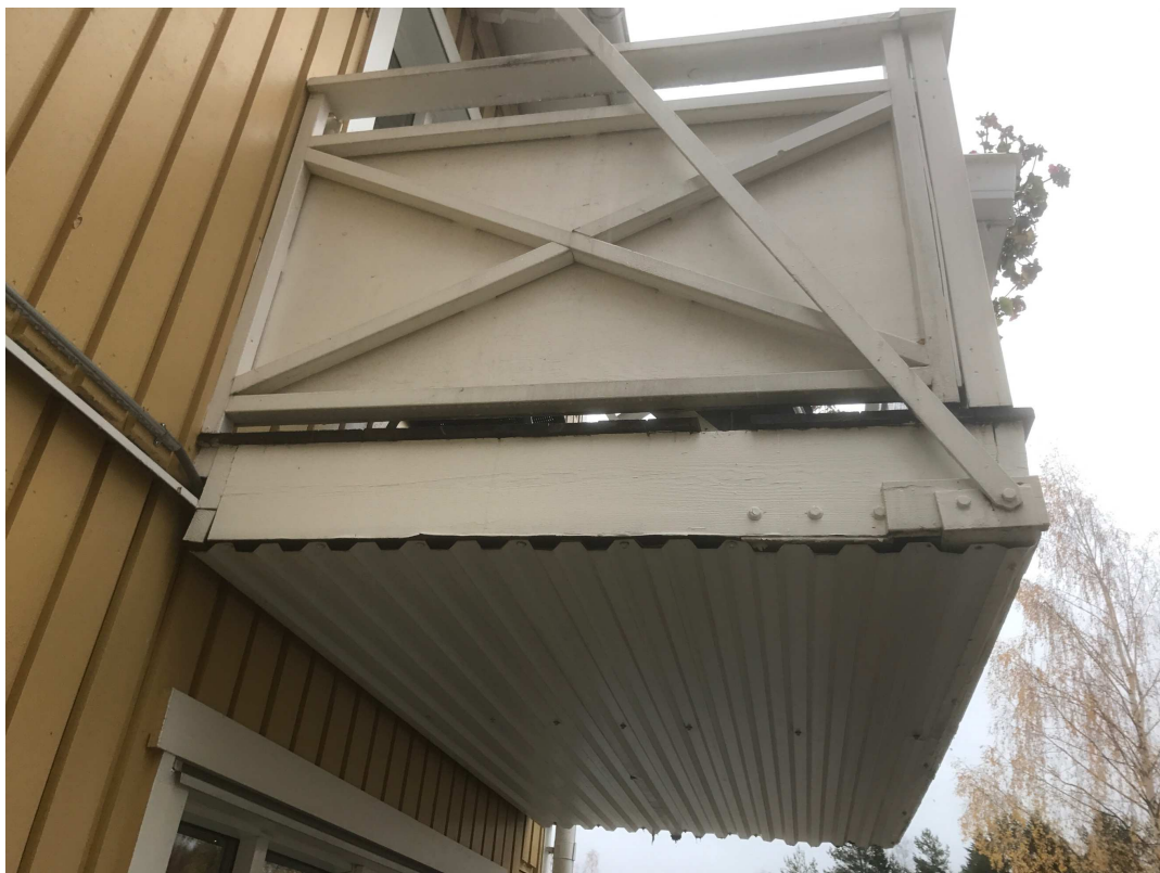
Bild 36: Fuktigt på räcken, sprickor och glipor infästningar i fram- och bakkant
