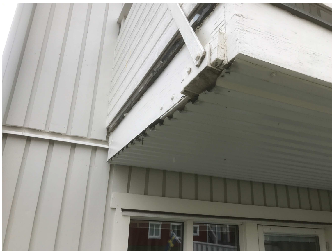
Bild 15: Sprickor vid infästning samt fuktskadade balkar
