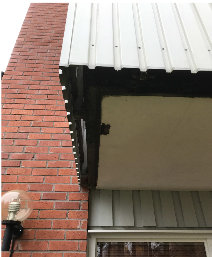
Bild 8: Frostsprängning underkant balkongplatta (övre LGH 12C)
