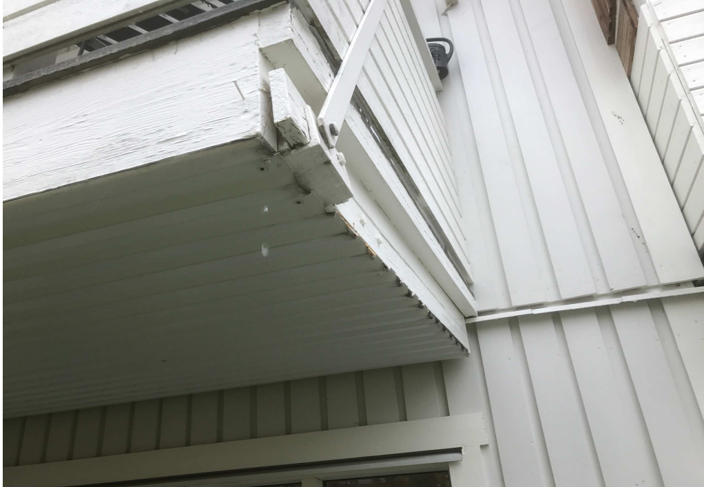
Bild 18: Sprickor vid infästning samt fuktskadade balkar
