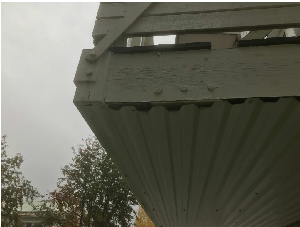
Bild 13: Sprickor vid infästning samt fuktskadade balkar
