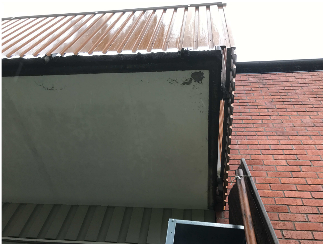
Bild 2: Början till frostsprängning underkant balkong (LGH i 14B)
