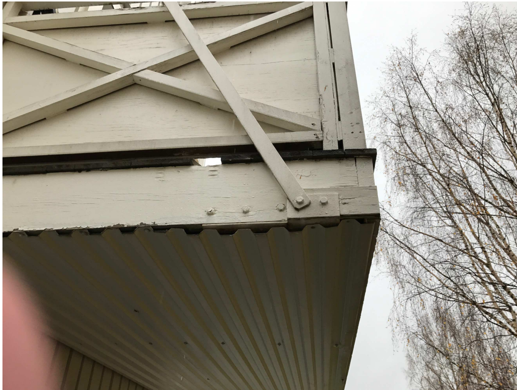
Bild 43: Fuktskadat räcke och sprickbildning i balkar
