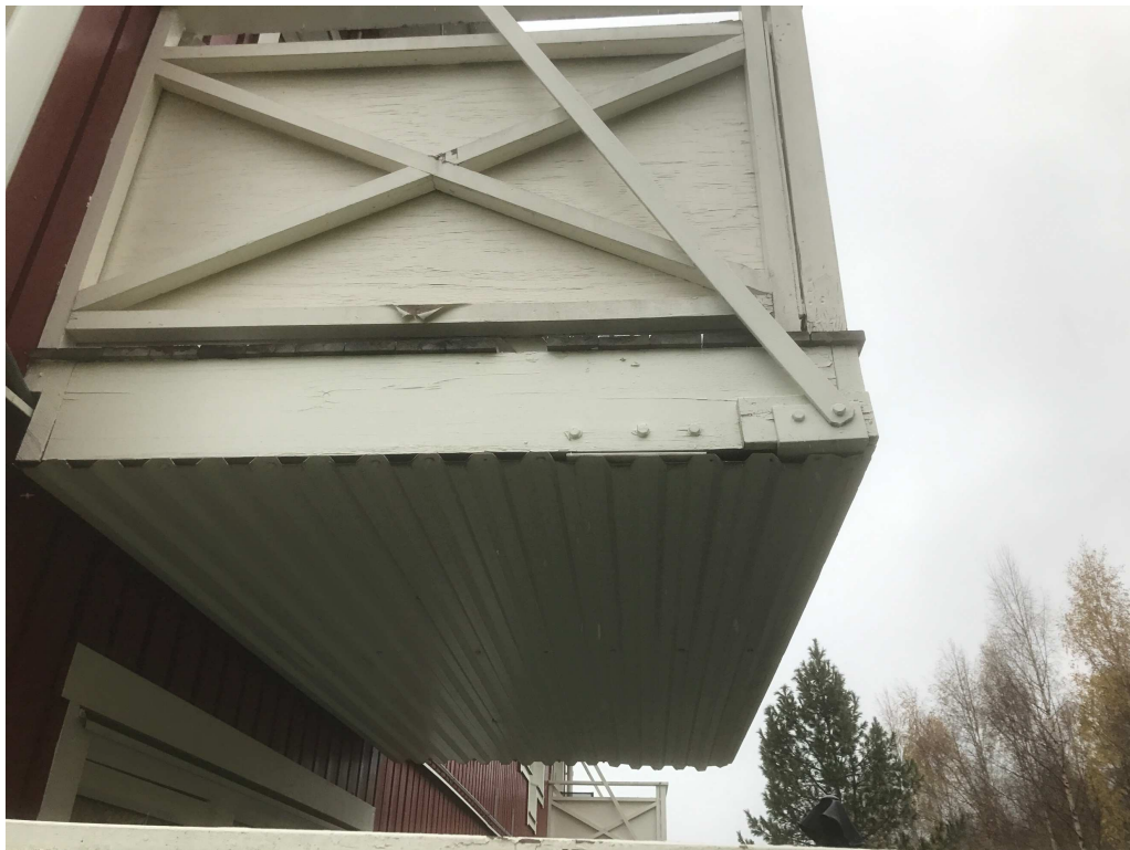
Bild 23: Fuktigt på räcken, sprickor och glipor infästningar i fram- och bakkant
