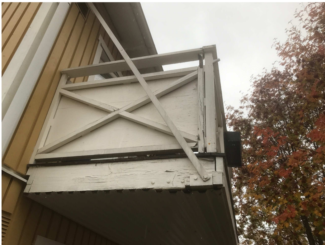
Bild 33: Fuktigt på räcken, sprickor och glipor infästningar i fram- och bakkant
