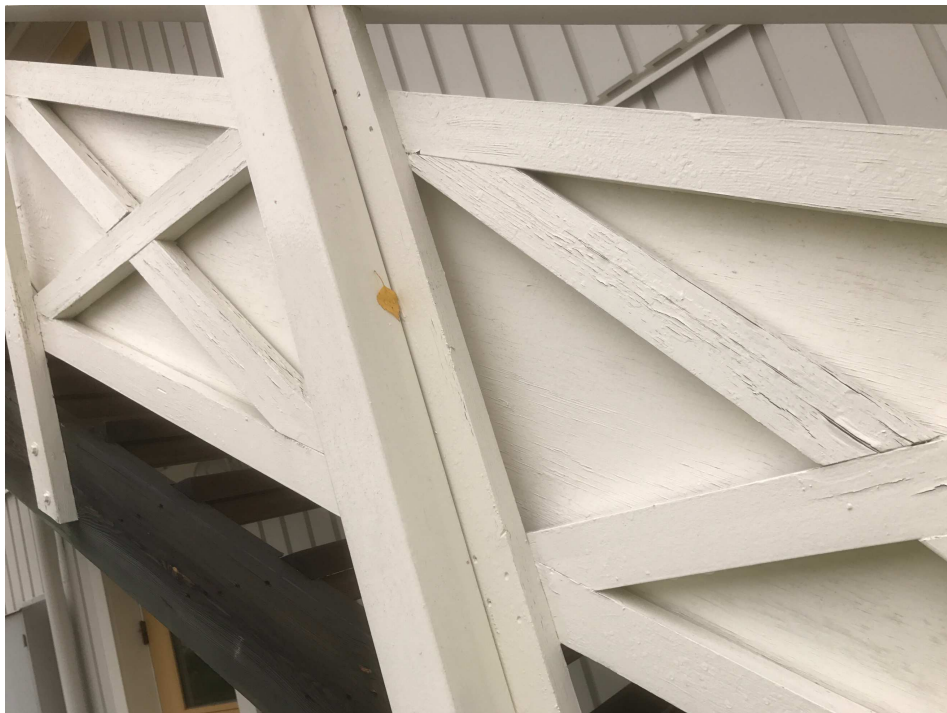
Bild 9: Fuktskadade räcken på trappor upp till plan 2.
