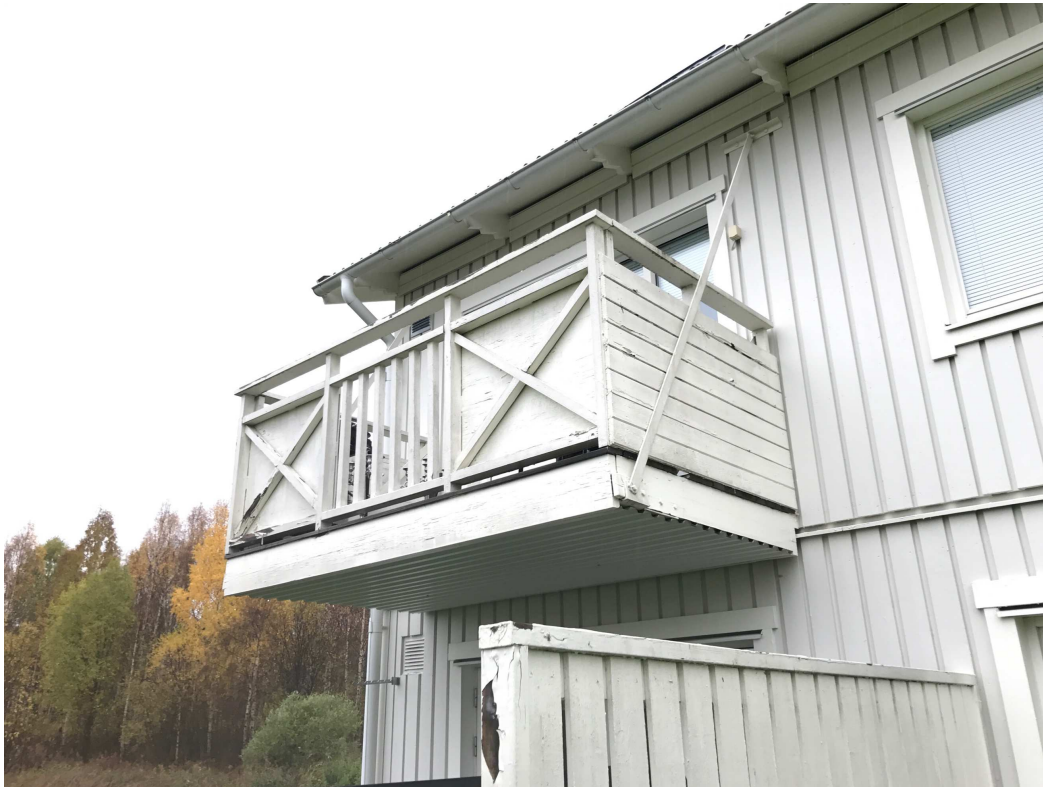
Bild 52: Fuktskadat räcke och sprickbildning i balkar
