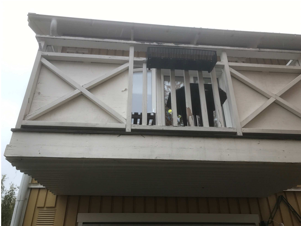
Bild 34: Fuktskadade räcken och överliggare
