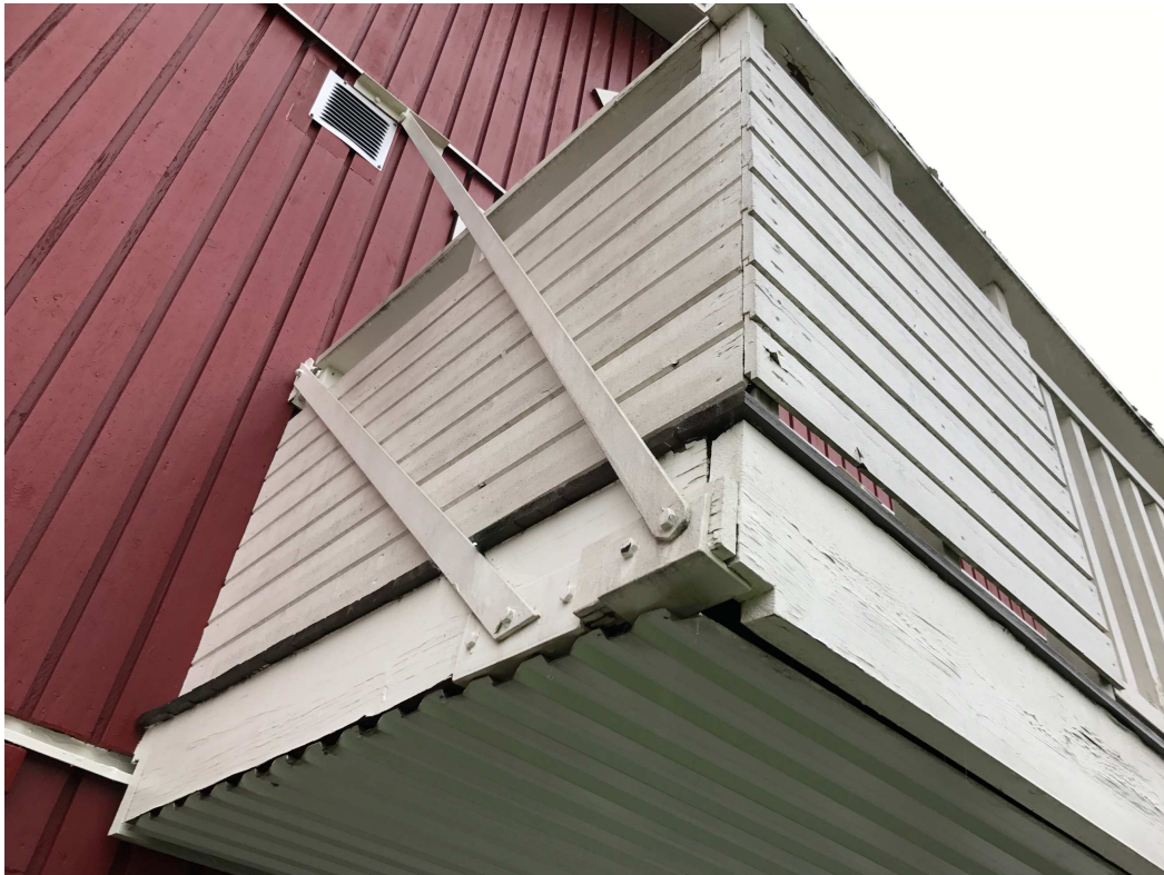
Bild 82: Fuktskadade balkar och sprickbildning i balkar vid främre infästning
