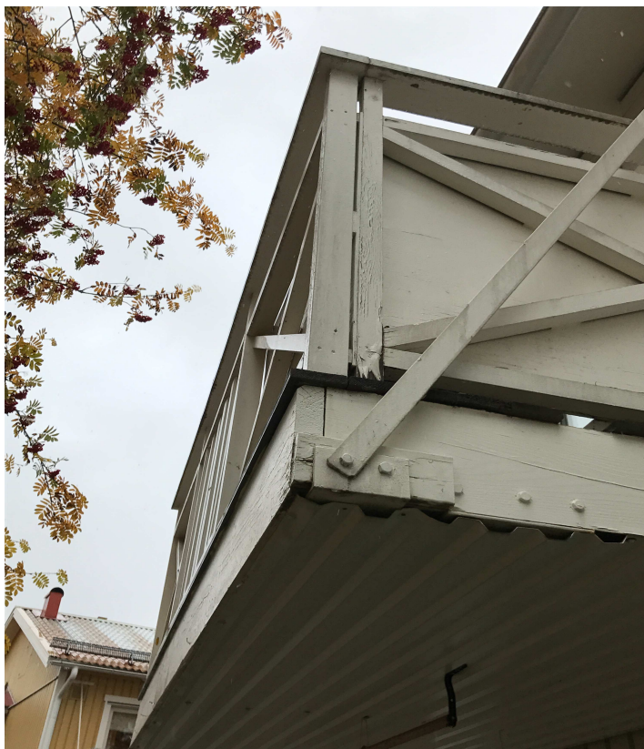
Bild 42: Fuktskadat räcke och sprickbildning i balkar
