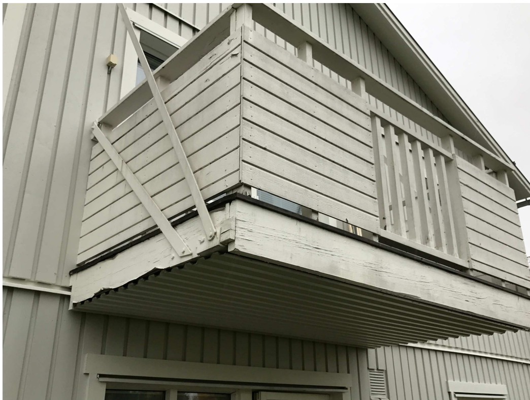
Bild 78: Fuktskadade och sprickbildning i balkar vid främre infästning
