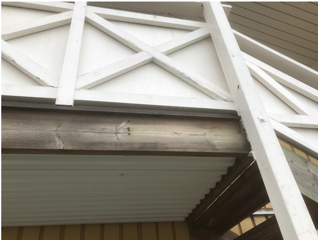
Bild 39: Fuktskadat räcke på trappa upp till plan 2
