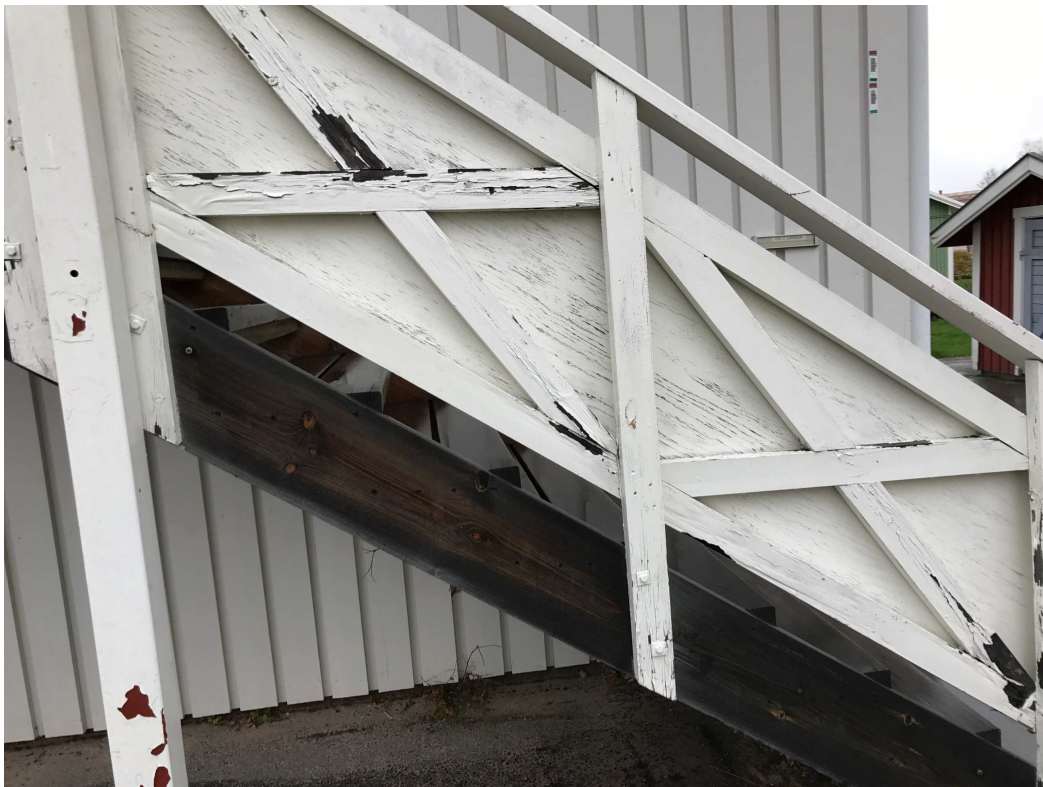
Bild 73: Fuktskadade räcken upp till plan 2
