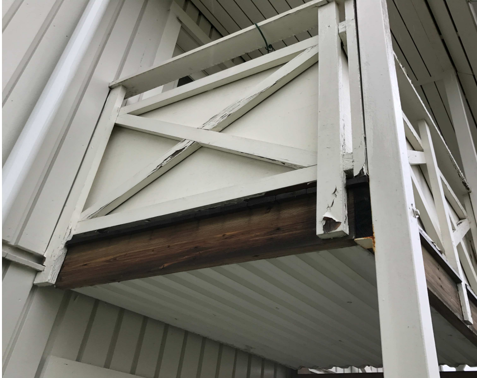
Bild 57: Fuktiskadade räcken upp till plan 2
