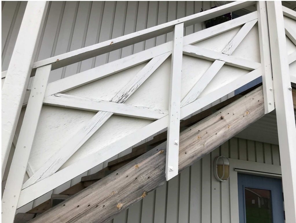
Bild 64: Fuktskadade räcken upp till plan 2
