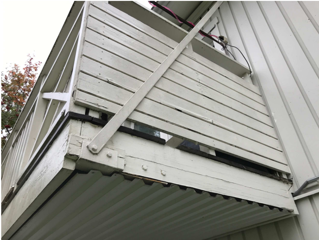
Bild 59: Fuktskadat räcke och sprickbildning i balkar i fram- och bakkant
