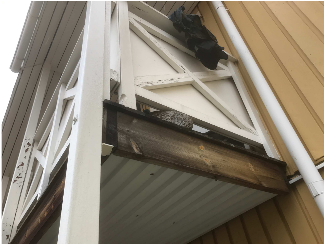
Bild 32: Fuktskadat räcke på trappa upp till plan 2
