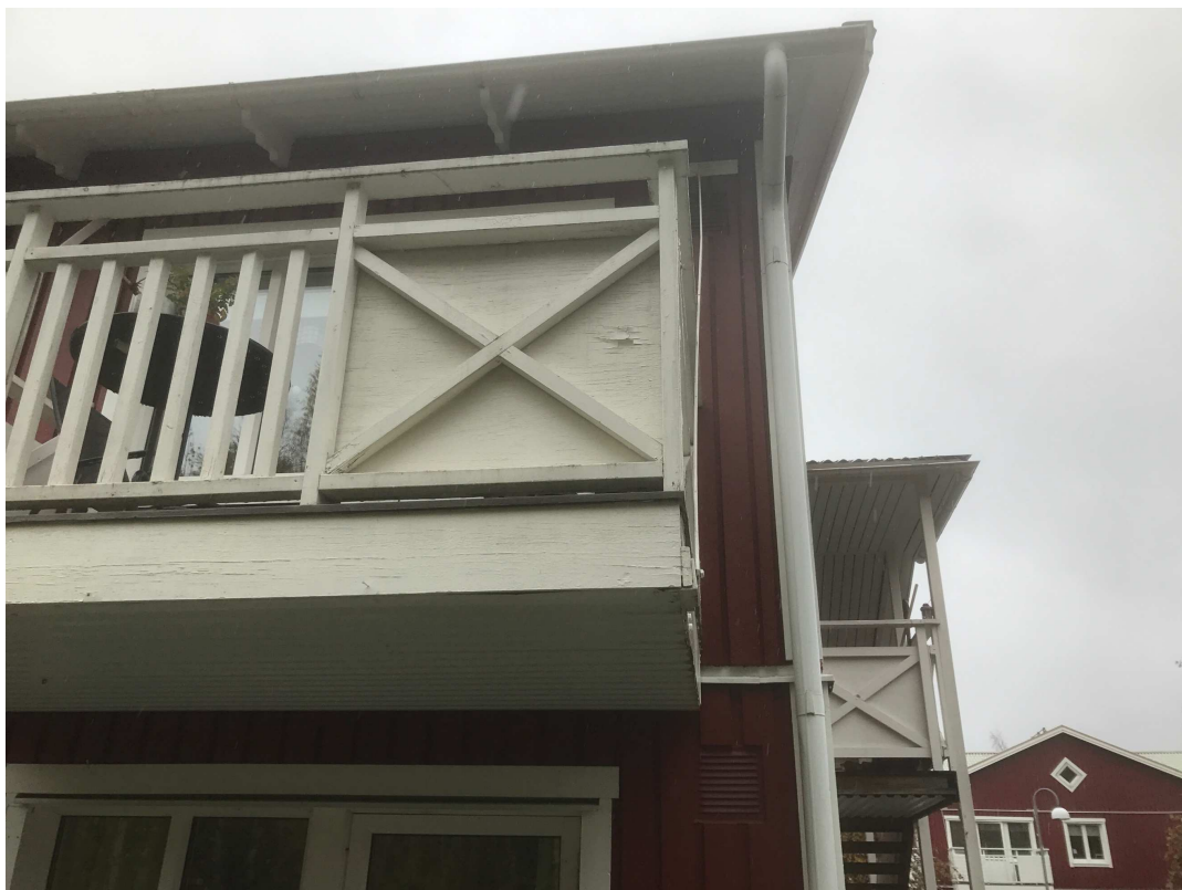
Bild 26: Fuktigt på räcken, sprickor och glipor infästningar i fram- och bakkant
