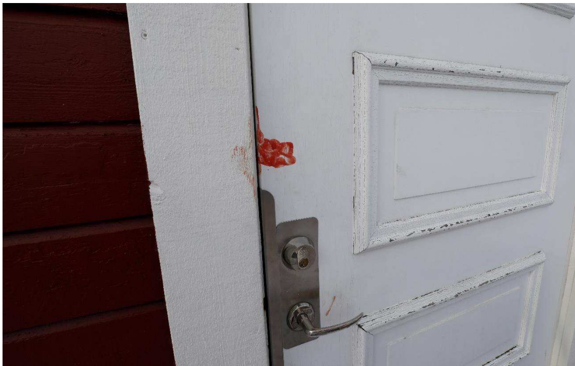
Bild 11. Närbild på ytterdörrens utsida med blod på dörrbladet, på och intill handtaget.
