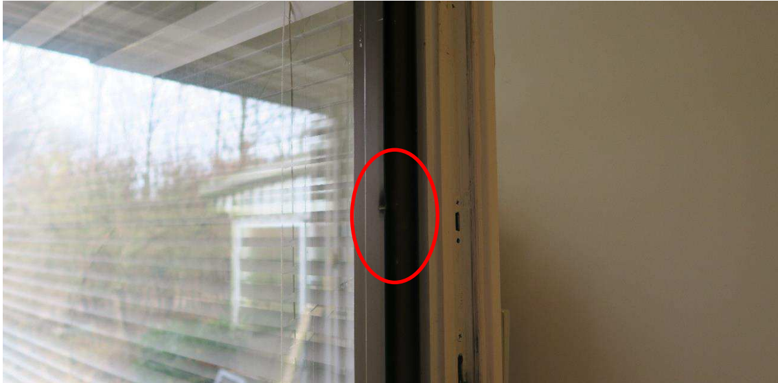
Figur 4. Fönster från kök ut till altan. Röd oval visar brytskada.
