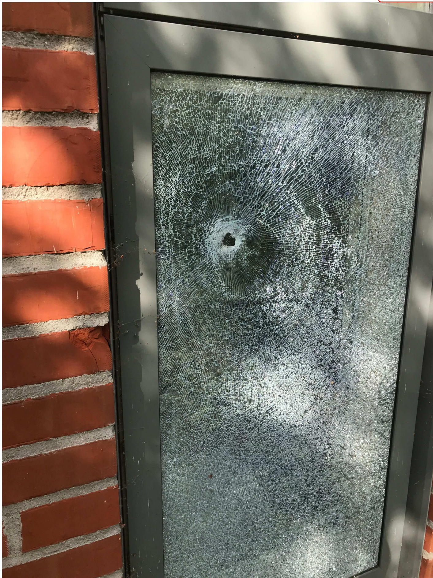
13. Närbild på det beskjutna fönstret.
