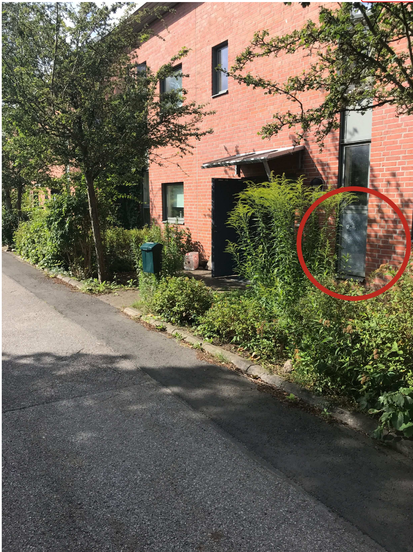
11. Bild på Östanväg 11. I röd ring fönstret som blivit beskjutet. Bild tagen av Pa F. Nöjd 2022-08-08. Bild 11.
