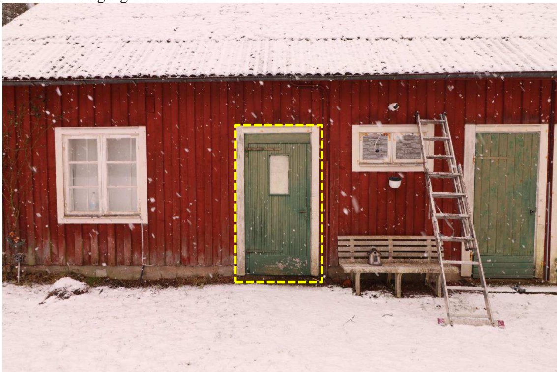
Figur 4. Markeringen visar den enda dörren som gick att använda i undersökt del av fastigheten.
