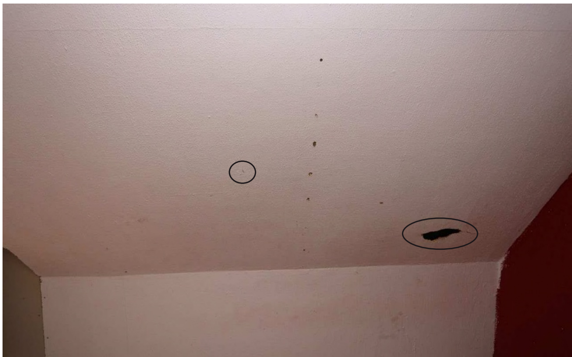
Figur 16. Skadorna på väggen till vänster om fönstret sett från dörröppningen, har markerats. På bilden har gipsplattan (G019) skruvats ned av kriminaltekniker.
