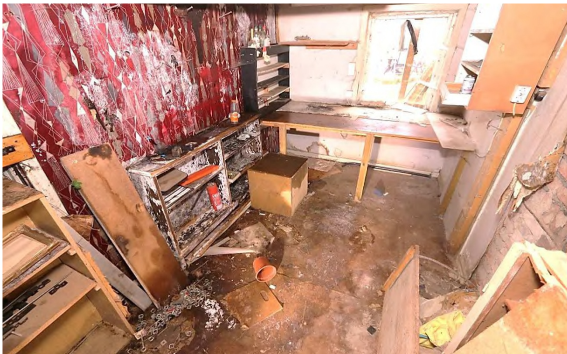
Figur 6. Omfattande mögelpåväxt iakttofs i rummet.
