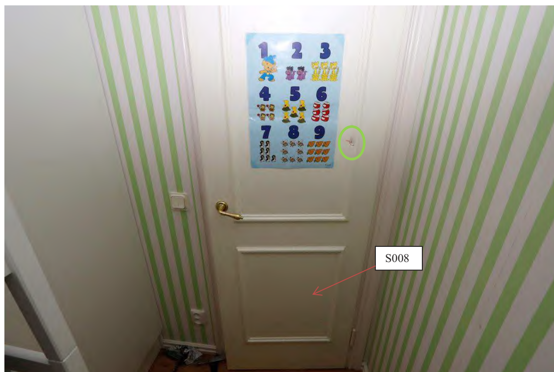
Figur 28. Visar insidan av dörren till barnrummet. Grön markering visar skadan i dörren.
