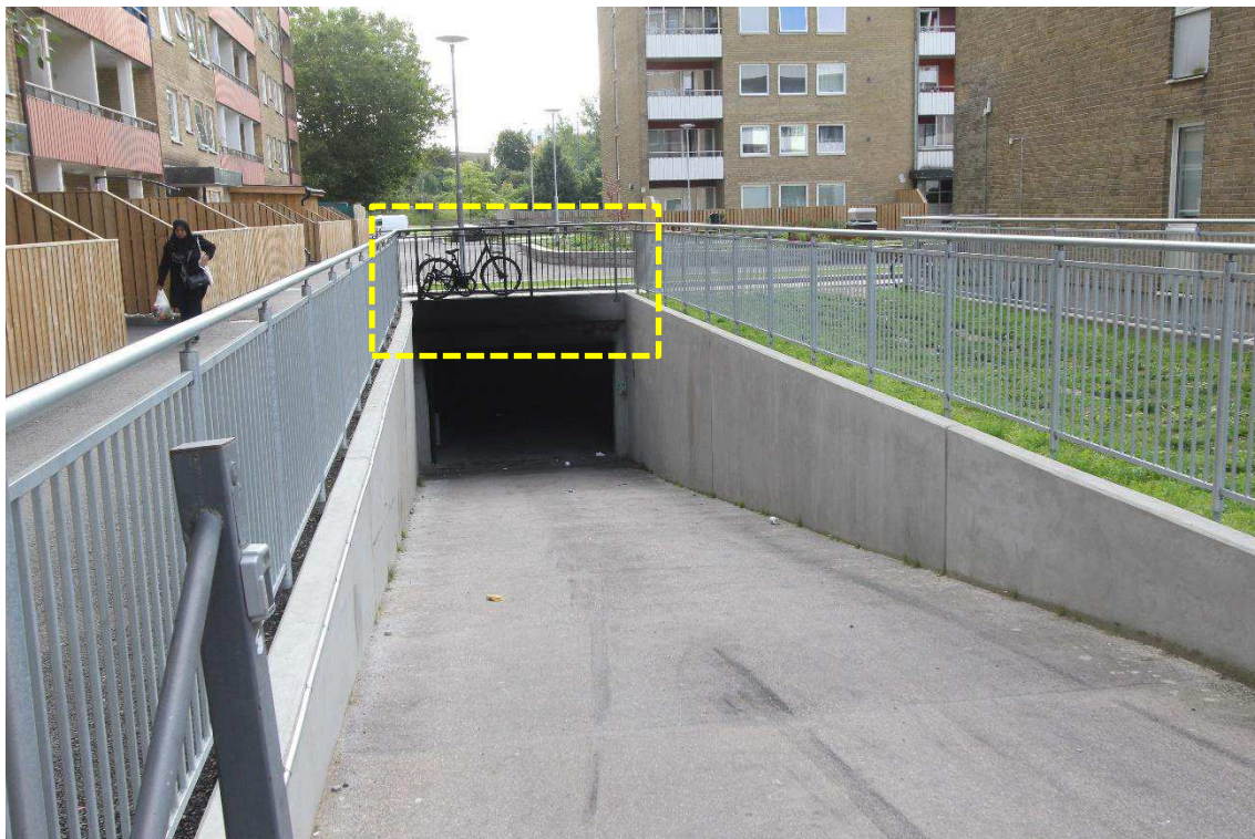
Figur 5. Nedfarten till garaget. Sotskadat området har markerats.
