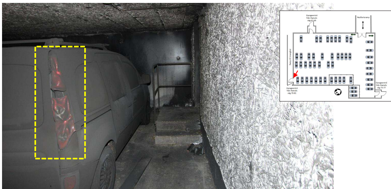
Figur 15. Närbild på en av flera värmeskadade personbilar i garaget. Värmeskadade baklyktor inom markering.
