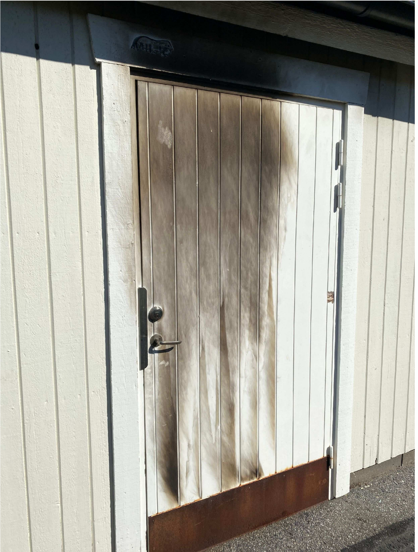
3. Bild på den vänstra dörren till ett förråd som brunnit. foto taget av PA Sigurdsson 2023-09-08
