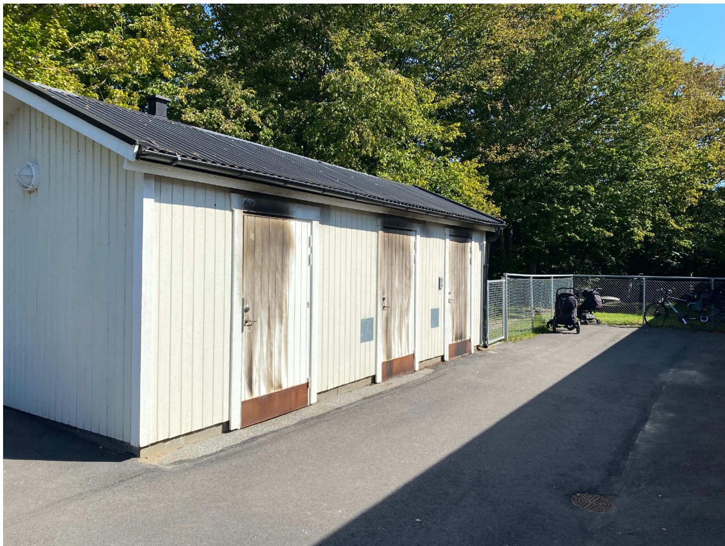
2. Bilder tagna på dörrar till ett förråd som brunnit. foto taget av PA Sigurdsson 2023-09-08
