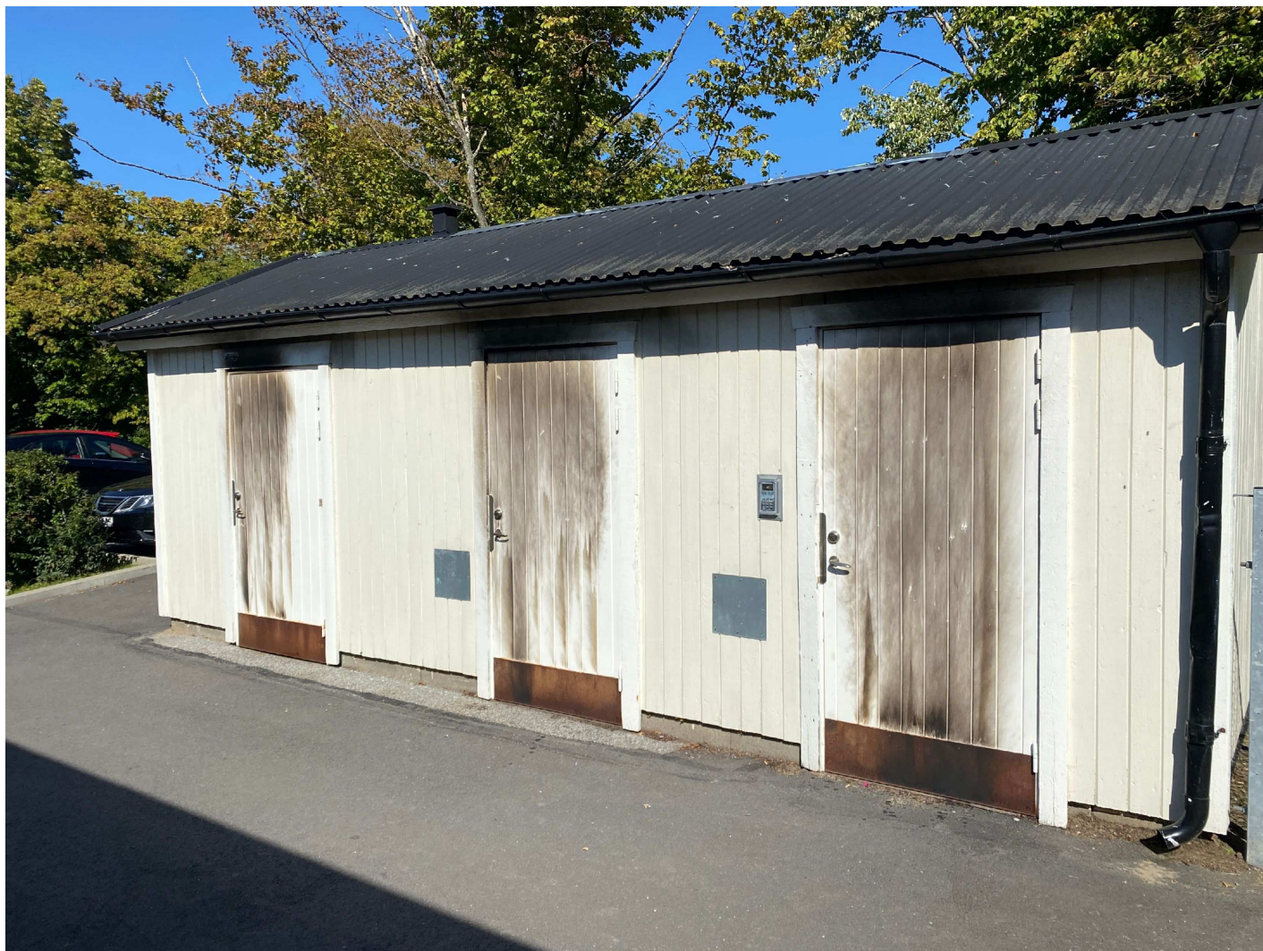
1. Bilder tagna på dörrar till ett förråd som brunnit. foto taget av PA Sigurdsson 2023-09-08
