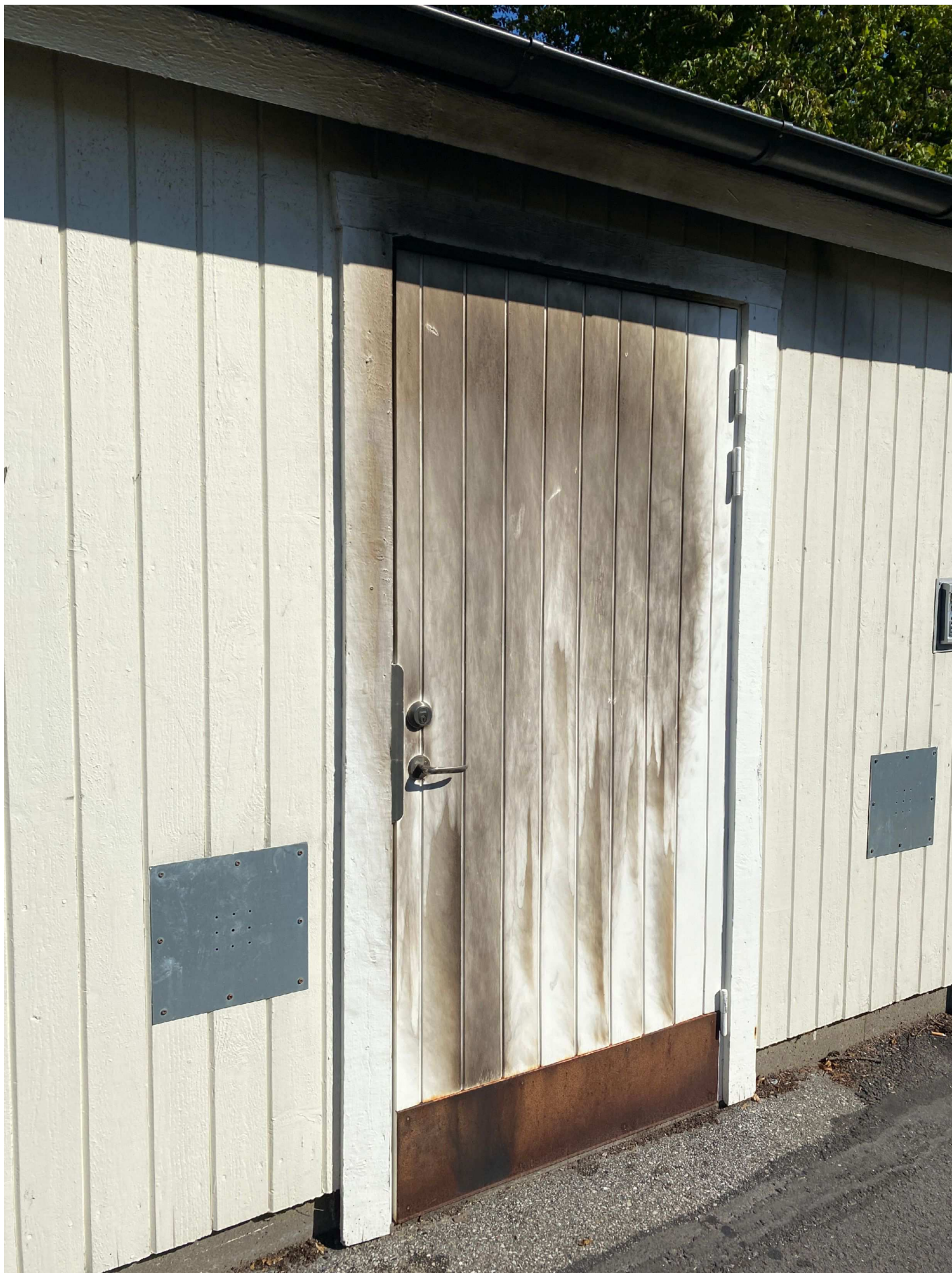
5. Bild på den mittersta dörren till ett förråd som brunnit. foto taget av PA Sigurdsson 2023-09-08
