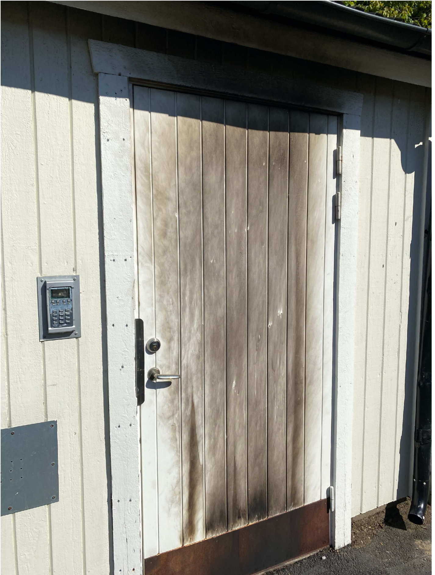
6. Bild på den högra dörren till ett förråd som brunnit. foto taget av PA Sigurdsson 2023-09-08
