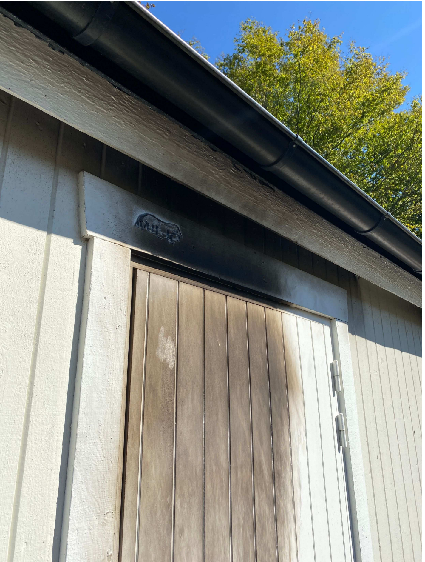
4. Bild på den vänstra dörren till ett förråd som brunnit. foto taget av PA Sigurdsson 2023-09-08
